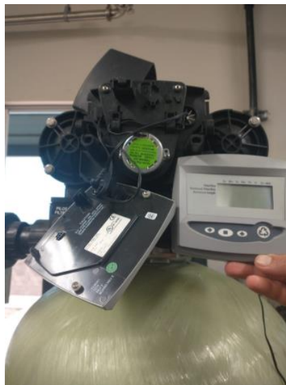
Figura 13. Cambio de filtros a Filtro Ablandador
