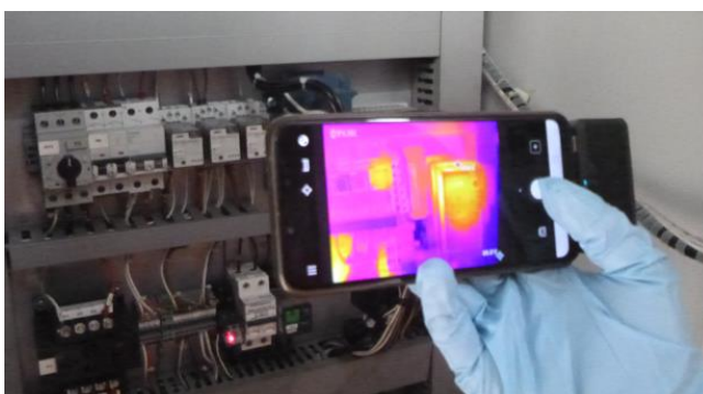
Figura 15. Termografía a Tablero de presión constante
