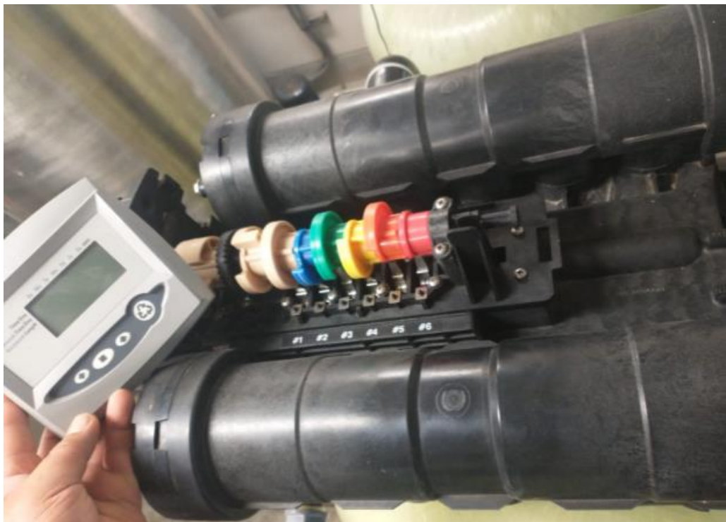
Figura 9. Inspección a Filtro Carbón Activado B
