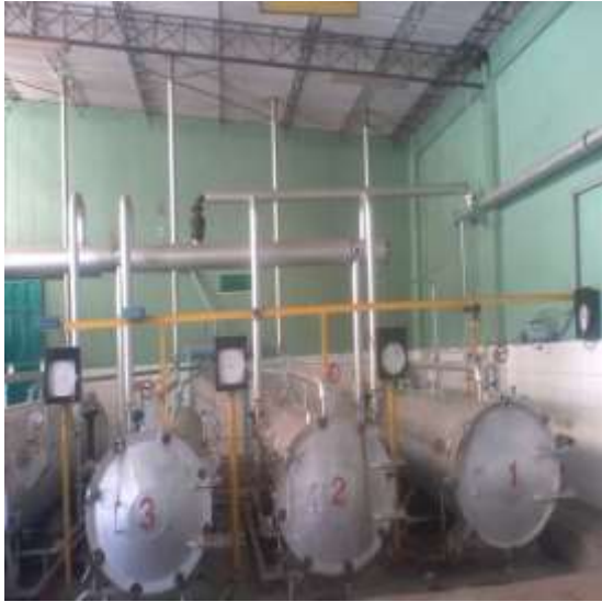
Área de esterilizado PCC3
