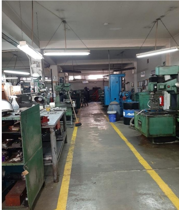
Figura 17. Instalación de Fluorescente de tubo doble en la estación de frezado de agujero.
