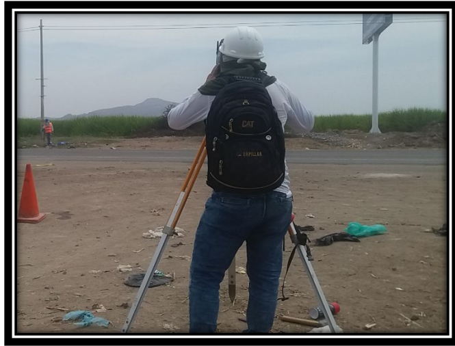
Foto N° 04.- Se observa al topógrafo realizando el levantamiento del punto de control del BM del proyecto de los 12 pueblos jóvenes del distrito de Pomalca, donde se empezará la nivelación geométrica.
