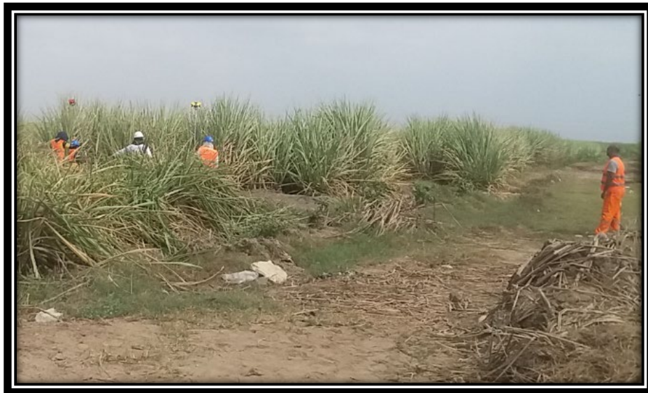
Foto N° 05.- Se observa al topógrafo y los cuatro ayudantes de topografía que siempre estuvieron durante todo el levantamiento topográfico de la vía principal a la Habilitación Urbana Puertas de Chiclayo.
