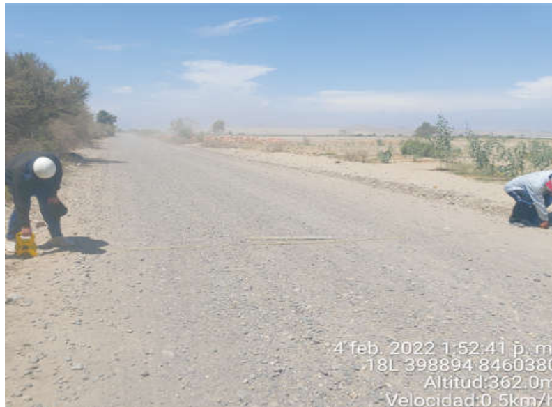
Figura 19. Superficie de Rodadura KM-00+634 al KM-00+644, se observa el daño de Encalaminado en la calzada.
