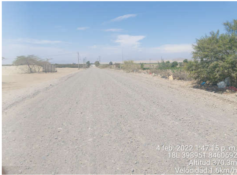
Figura 48. Superficie de Rodadura KM-00+924 al KM-00+934, se observa el daño de Encalaminado en la calzada.
