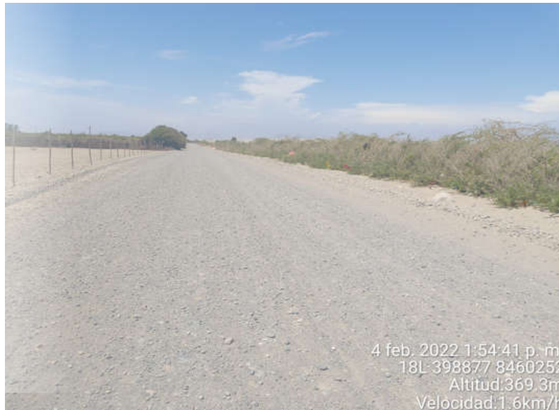
Figura 6. Superficie de Rodadura KM-00+504 al KM-00+514, se observa el daño de Encalaminado en la calzada.
