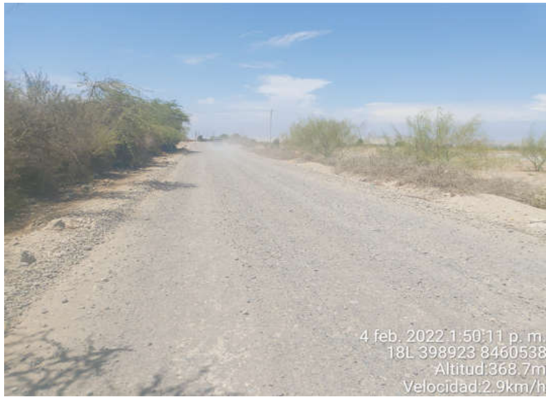
Figura 34. Superficie de Rodadura KM-00+784 al KM-00+794, se observa el daño de Encalaminado en la calzada.
