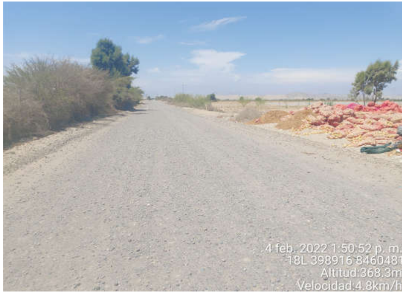
Figura 28. Superficie de Rodadura KM-00+724 al KM-00+734, se observa el daño de Encalaminado en la calzada.
