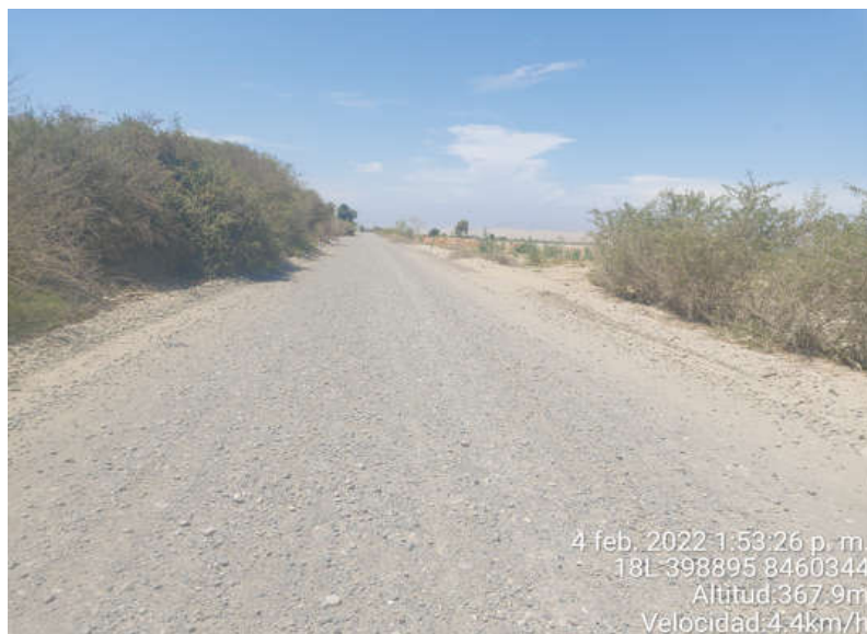
Figura 15. Superficie de Rodadura KM-00+594 al KM-00+604, se observa el daño de Encalaminado en la calzada.
