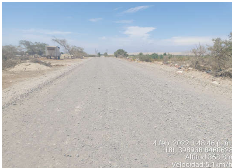
Figura 43. Superficie de Rodadura KM-00+874 al KM-00+884, se observa el daño de Encalaminado en la calzada.
