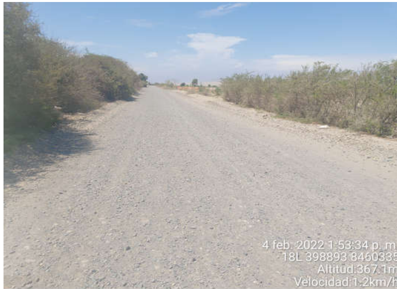
Figura 14. Superficie de Rodadura KM-00+584 al KM-00+594, se observa el daño de Encalaminado en la calzada.
