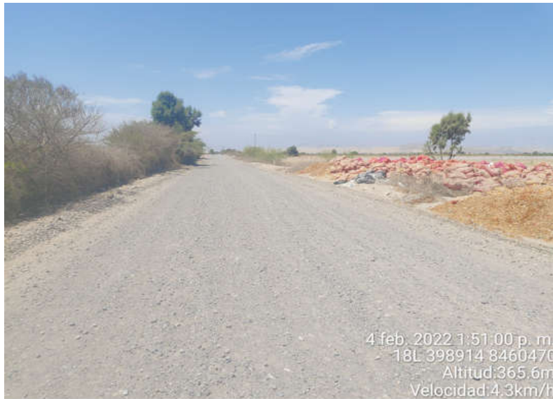
Figura 27. Superficie de Rodadura KM-00+714 al KM-00+724, se observa el daño de Encalaminado en la calzada.
