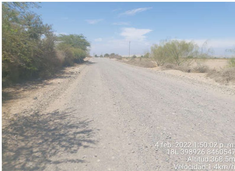
Figura 35. Superficie de Rodadura KM-00+794 al KM-00+804, se observa el daño de Encalaminado en la calzada.
