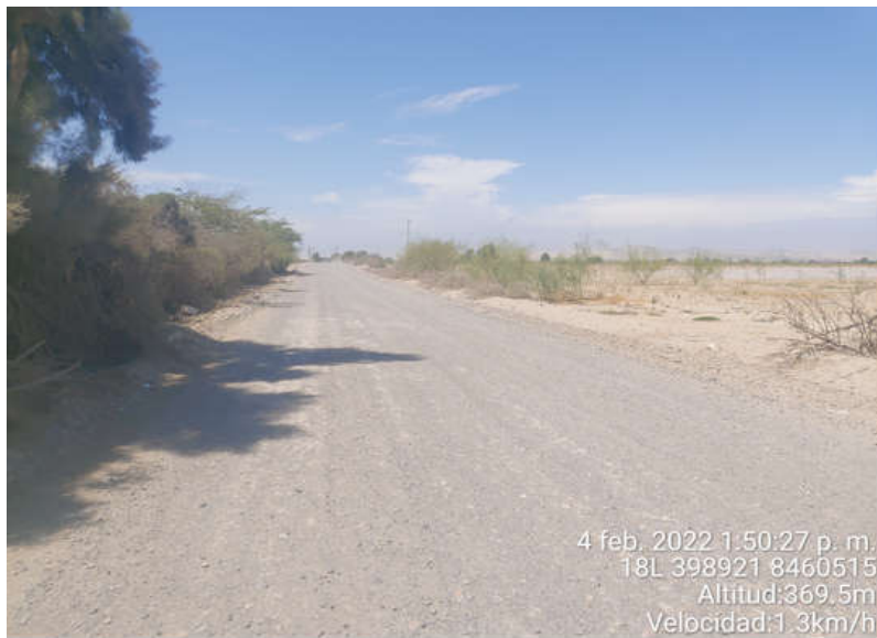
Figura 31. Superficie de Rodadura KM-00+754 al KM-00+764, se observa el daño de Encalaminado en la calzada.
