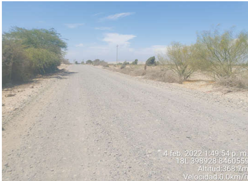
Figura 36. Superficie de Rodadura KM-00+804 al KM-00+814, se observa el daño de Encalaminado en la calzada.
