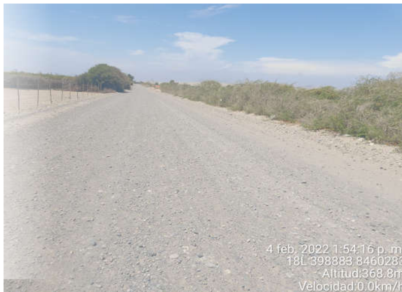
Figura 9. Superficie de Rodadura KM-00+534 al KM-00+544, se observa el daño de Encalaminado en la calzada.
