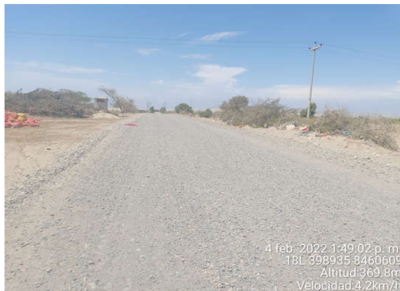
Figura 41. Superficie de Rodadura KM-00+854 al KM-00+864, se observa el daño de Encalaminado en la calzada.
