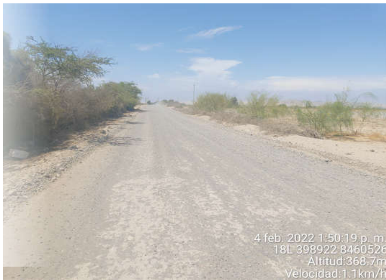
Figura 33. Superficie de Rodadura KM-00+774 al KM-00+784, se observa el daño de Encalaminado en la calzada.
