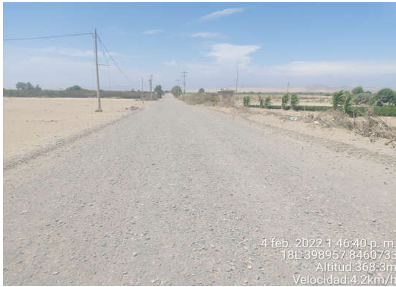
Figura 52. Superficie de Rodadura KM-00+964 al KM-00+974, se observa el daño de Encalaminado en la calzada.
