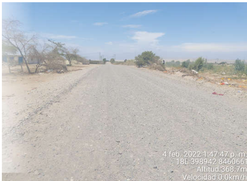
Figura 45. Superficie de Rodadura KM-00+894 al KM-00+904, se observa el daño de Encalaminado en la calzada.
