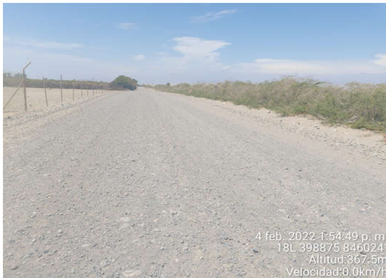
Figura 5. Superficie de Rodadura KM-00+494 al KM-00+504, se observa el daño de Encalaminado en la calzada.
