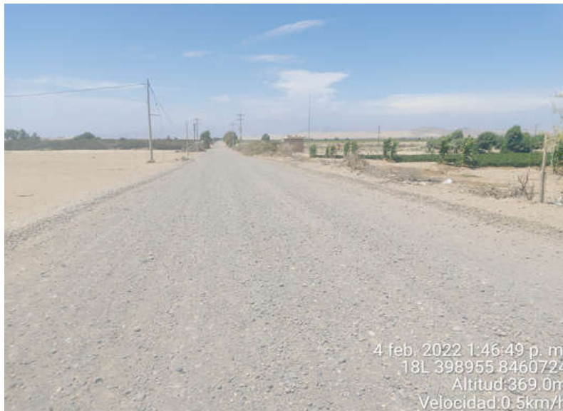
Figura 51. Superficie de Rodadura KM-00+954 al KM-00+964, se observa el daño de Encalaminado en la calzada.
