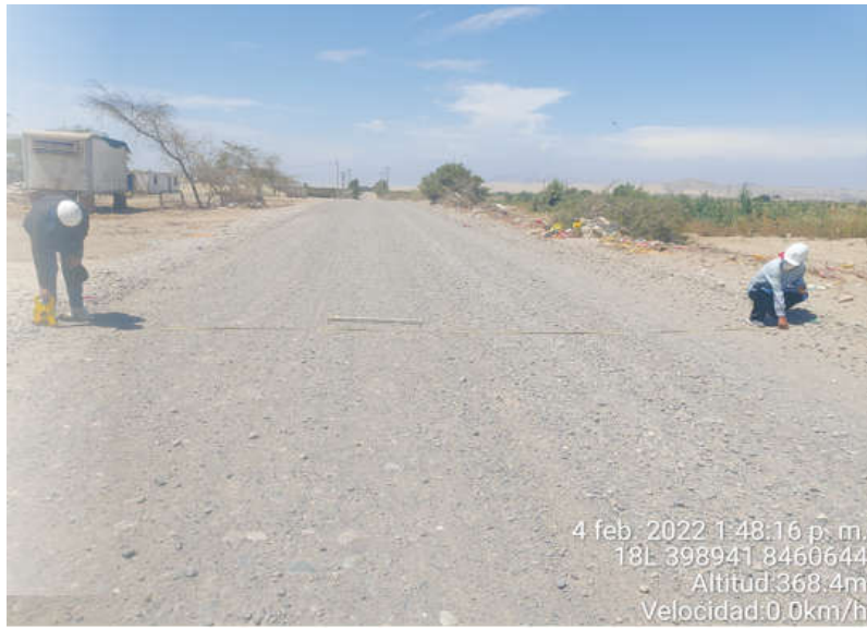
Figura 44. Superficie de Rodadura KM-00+884 al KM-00+894, se observa el daño de Encalaminado en la calzada.
