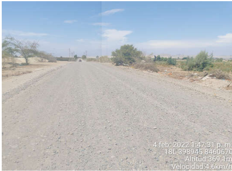
Figura 46. Superficie de Rodadura KM-00+904 al KM-00+914, se observa el daño de Encalaminado en la calzada.
