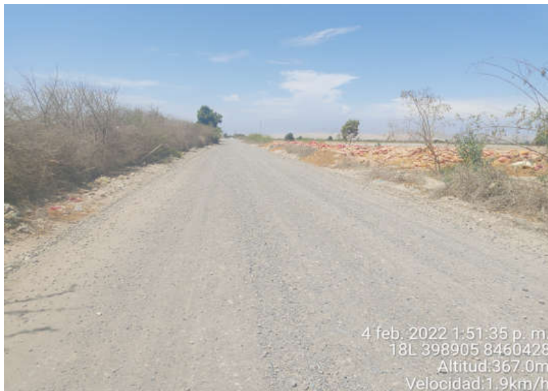
Figura 23. Superficie de Rodadura KM-00+674 al KM-00+684, se observa el daño de Encalaminado en la calzada.
