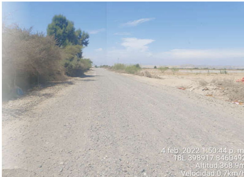
Figura 29. Superficie de Rodadura KM-00+734 al KM-00+744, se observa el daño de Encalaminado en la calzada.
