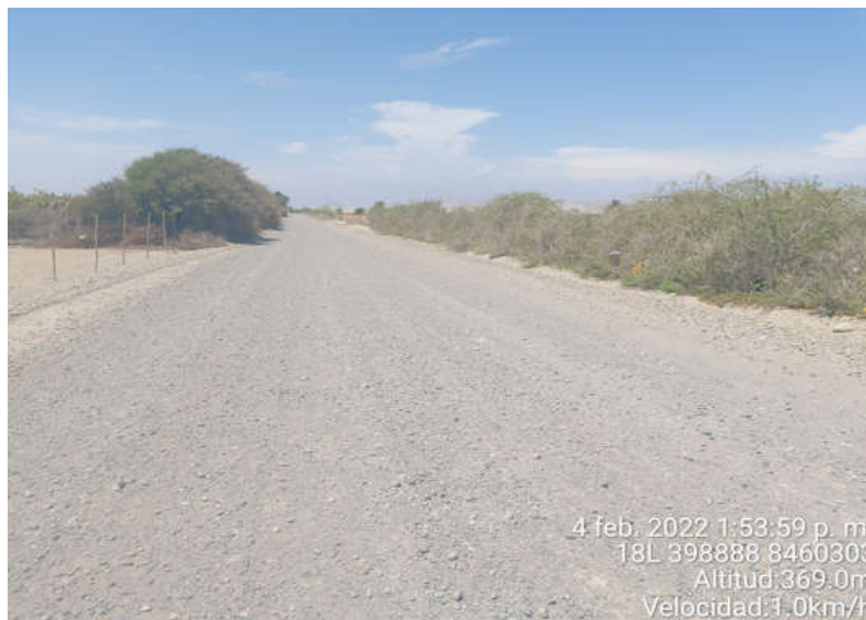
Figura 11. Superficie de Rodadura KM-00+554 al KM-00+564, se observa el daño de Encalaminado en la calzada.
