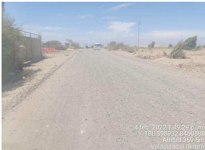
Figura 39. Superficie de Rodadura KM-00+834 al KM-00+844, se observa el daño de Encalaminado en la calzada.
