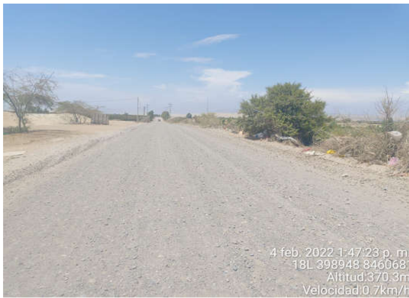
Figura 47. Superficie de Rodadura KM-00+914 al KM-00+924, se observa el daño de Encalaminado en la calzada.
