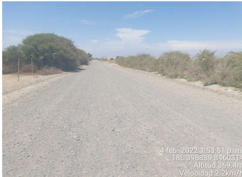
Figura 12. Superficie de Rodadura KM-00+564 al KM-00+574, se observa el daño de Encalaminado en la calzada.
