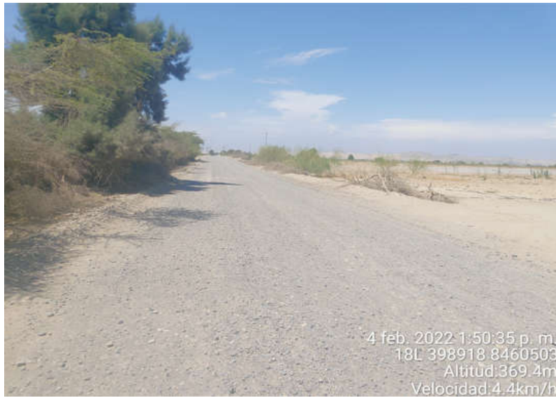
Figura 30. Superficie de Rodadura KM-00+744 al KM-00+754, se observa el daño de Encalaminado en la calzada.
