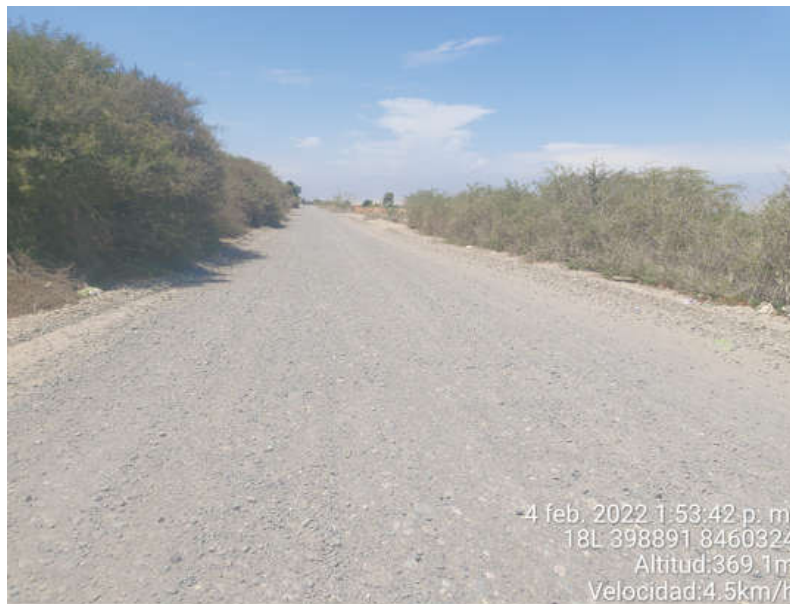
Figura 13. Superficie de Rodadura KM-00+574 al KM-00+584, se observa el daño de Encalaminado en la calzada.
