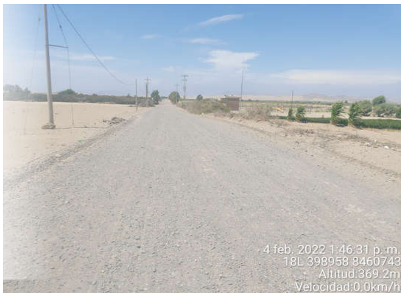
Figura 53. Superficie de Rodadura KM-00+974 al KM-00+984, se observa el daño de Encalaminado en la calzada.
