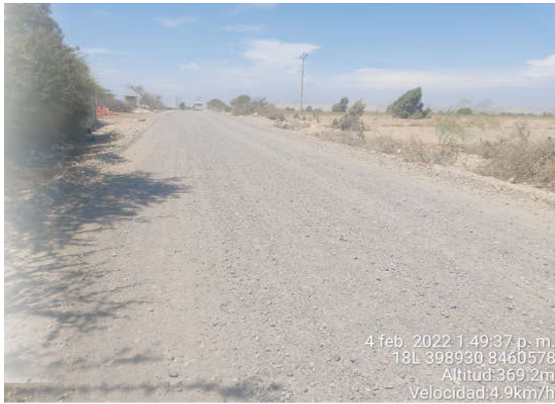
Figura 38. Superficie de Rodadura KM-00+824 al KM-00+834, se observa el daño de Encalaminado en la calzada.
