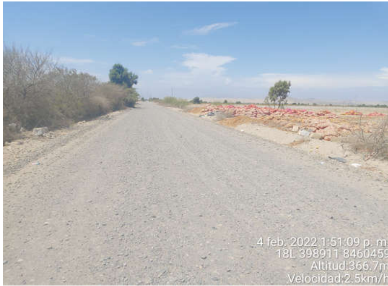
Figura 26. Superficie de Rodadura KM-00+704 al KM-00+714, se observa el daño de Encalaminado en la calzada.
