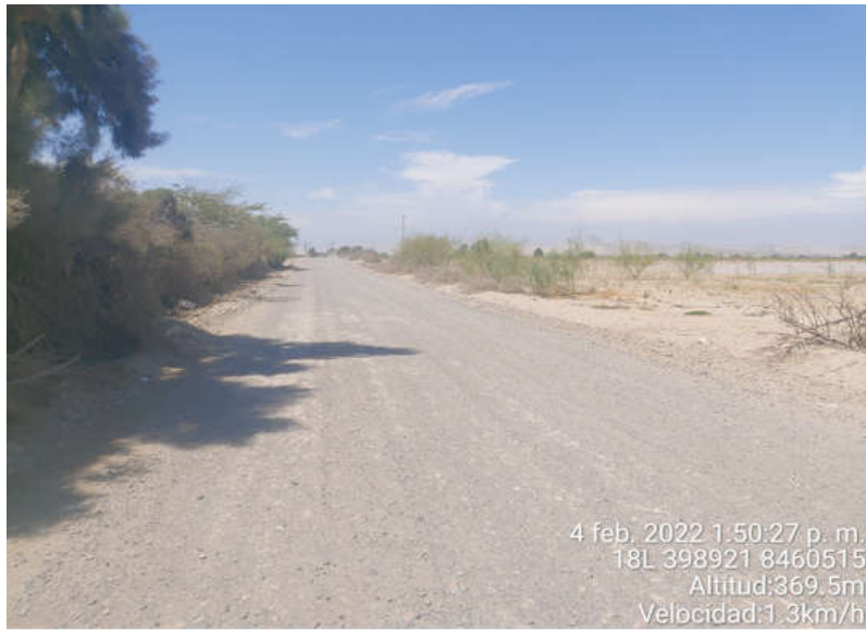
Figura 32. Superficie de Rodadura KM-00+764 al KM-00+774, se observa el daño de Encalaminado en la calzada.
