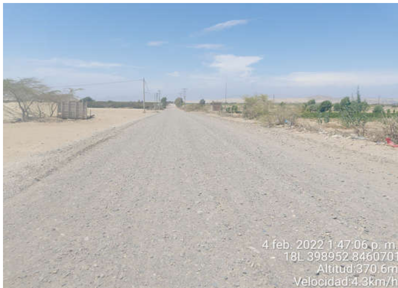
Figura 49. Superficie de Rodadura KM-00+934 al KM-00+944, se observa el daño de Encalaminado en la calzada.
