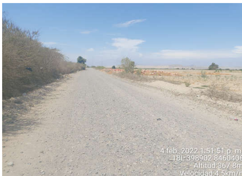
Figura 21. Superficie de Rodadura KM-00+654 al KM-00+664, se observa el daño de Encalaminado en la calzada.
