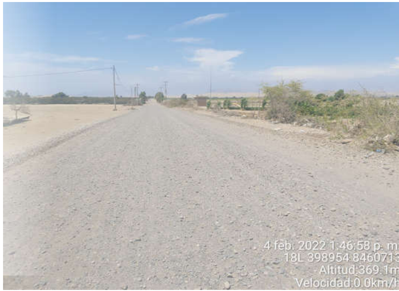
Figura 50. Superficie de Rodadura KM-00+944 al KM-00+954, se observa el daño de Encalaminado en la calzada.
