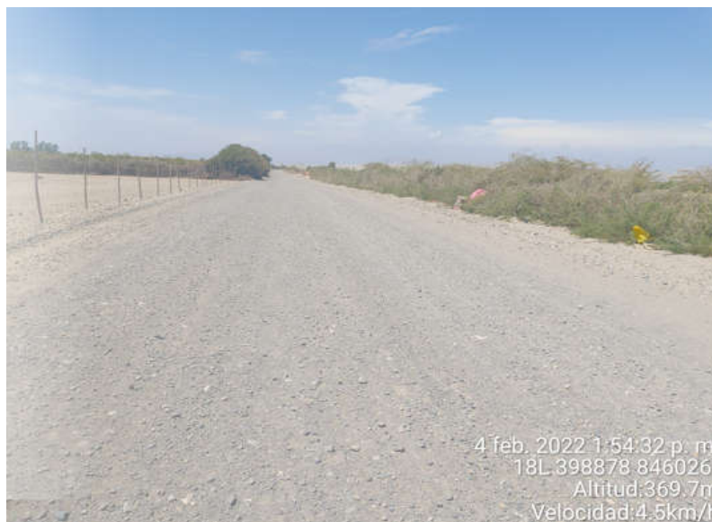
Figura 7. Superficie de Rodadura KM-00+514 al KM-00+524, se observa el daño de Encalaminado en la calzada.
