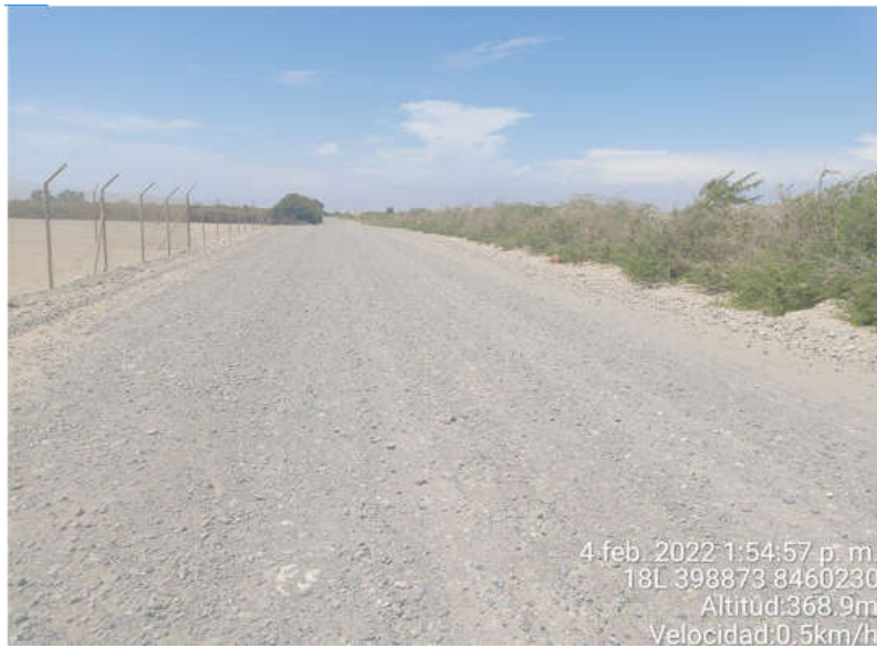
Figura 4. Superficie de Rodadura KM-00+484 al KM-00+494, se observa el daño de Encalaminado en la calzada.
