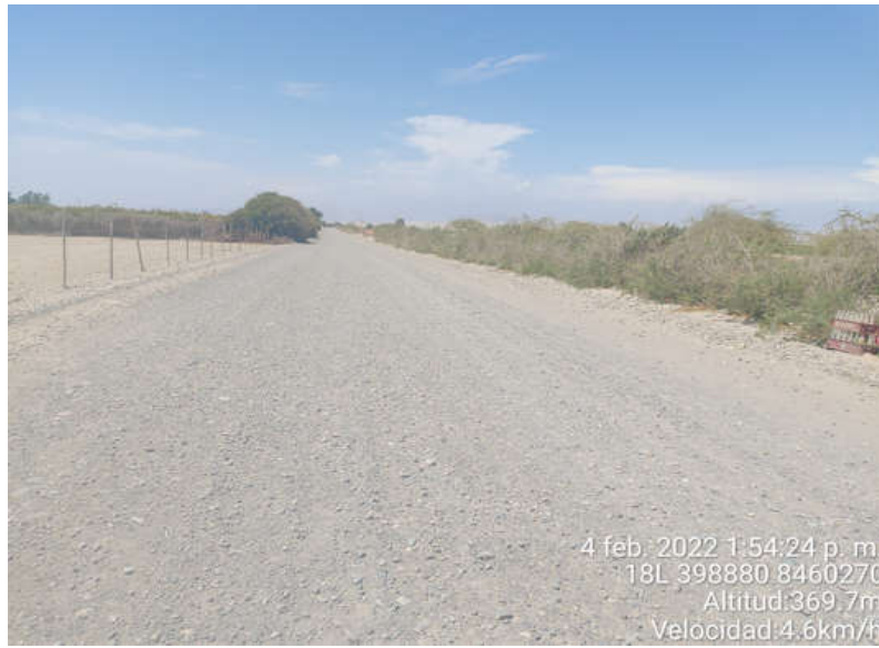
Figura 8. Superficie de Rodadura KM-00+524 al KM-00+534, se observa el daño de Encalaminado en la calzada.
