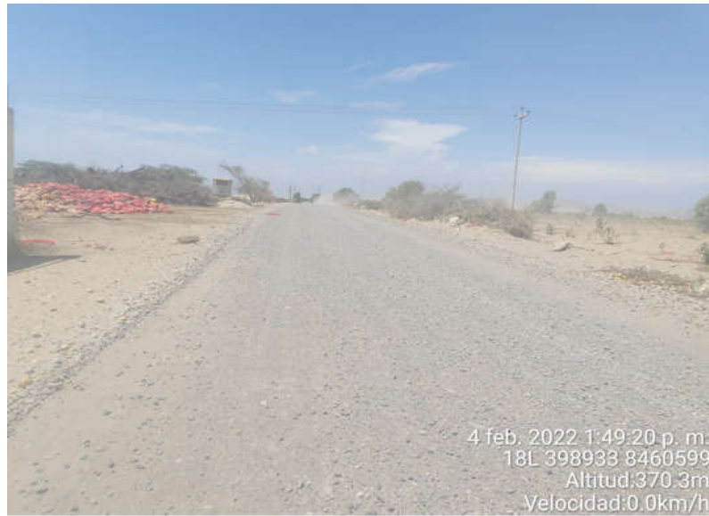
Figura 40. Superficie de Rodadura KM-00+844 al KM-00+854, se observa el daño de Encalaminado en la calzada.
