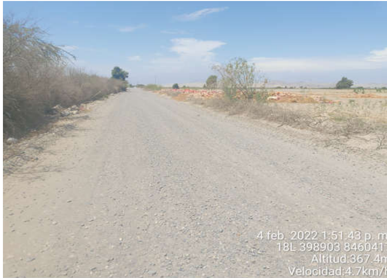
Figura 22. Superficie de Rodadura KM-00+664 al KM-00+674, se observa el daño de Encalaminado en la calzada.
