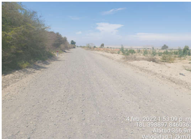
Figura 17. Superficie de Rodadura KM-00+614 al KM-00+624, se observa el daño de Encalaminado en la calzada.
