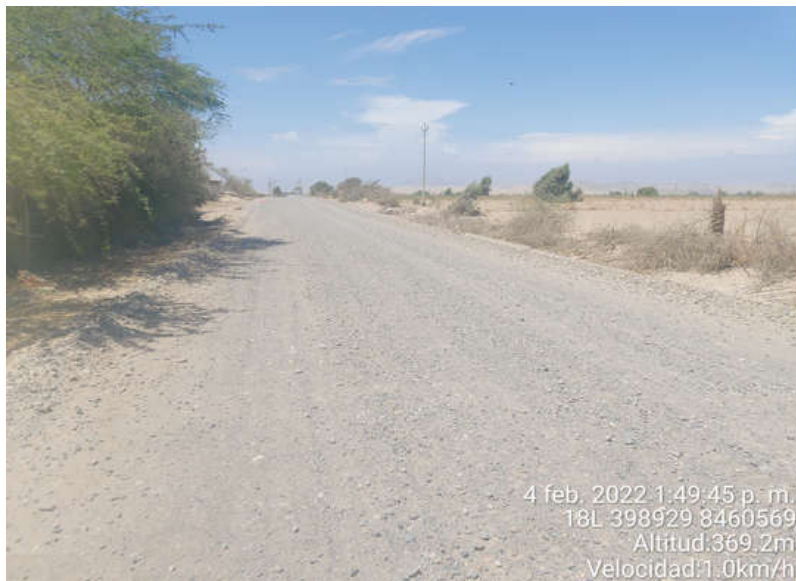
Figura 37. Superficie de Rodadura KM-00+814 al KM-00+824, se observa el daño de Encalaminado en la calzada.
