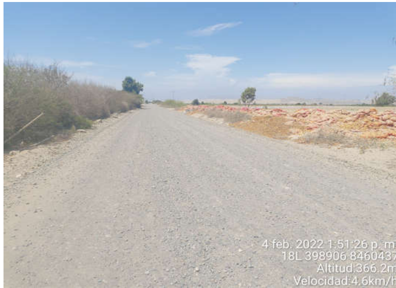
Figura 24. Superficie de Rodadura KM-00+684 al KM-00+694, se observa el daño de Encalaminado en la calzada.
