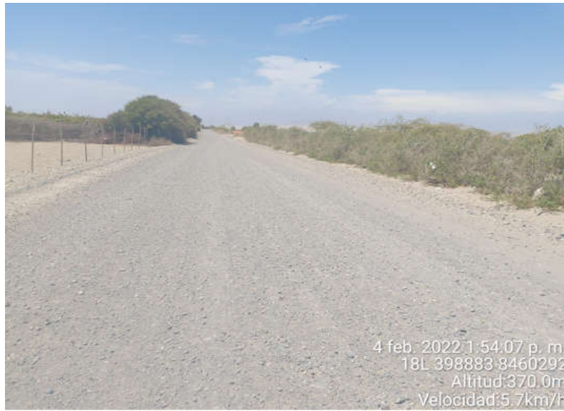
Figura 10. Superficie de Rodadura KM-00+544 al KM-00+554, se observa el daño de Encalaminado en la calzada.
