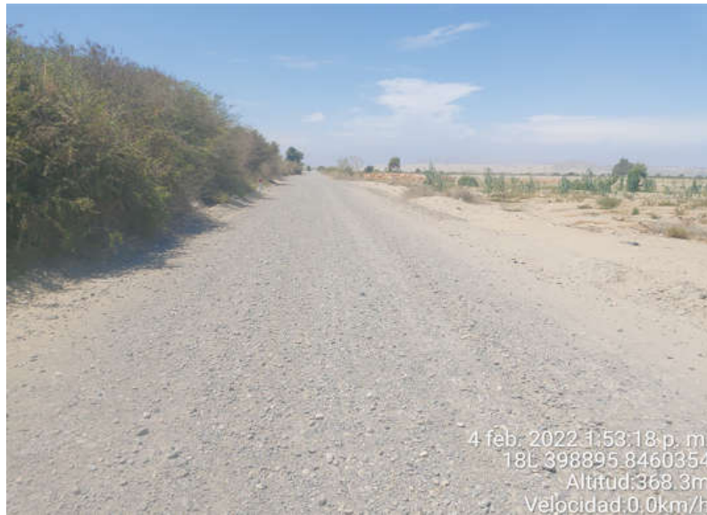
Figura 16. Superficie de Rodadura KM-00+604 al KM-00+614, se observa el daño de Encalaminado en la calzada.
