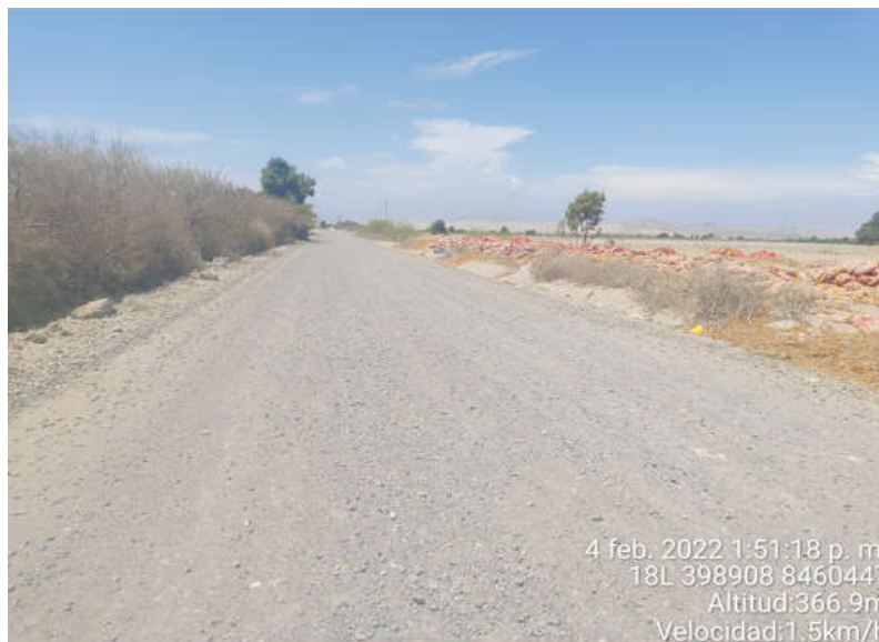
Figura 25. Superficie de Rodadura KM-00+694 al KM-00+704, se observa el daño de Encalaminado en la calzada.
