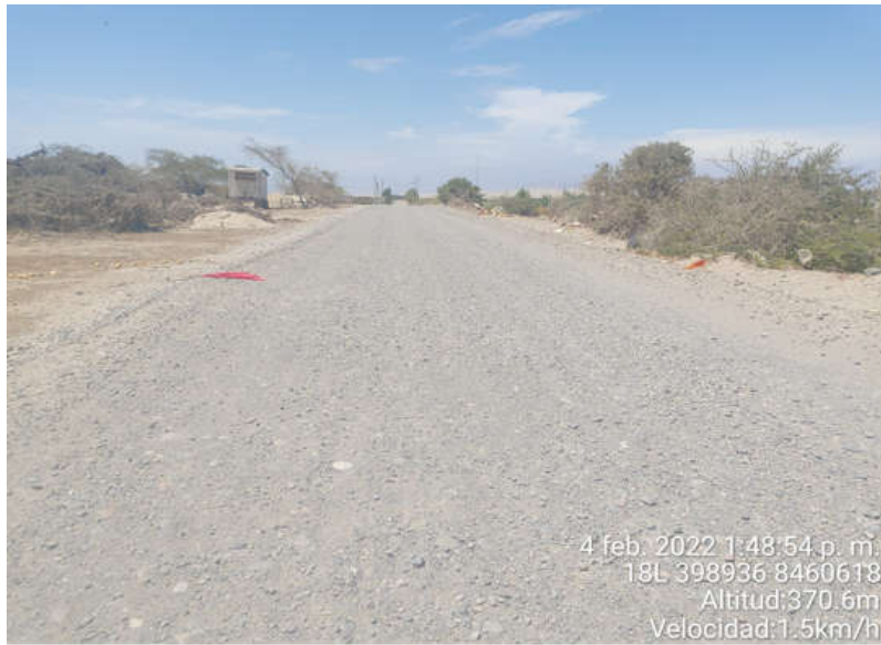
Figura 42. Superficie de Rodadura KM-00+864 al KM-00+874, se observa el daño de Encalaminado en la calzada.
