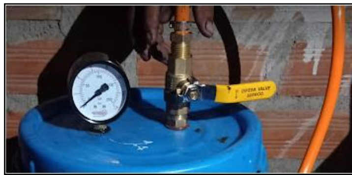
Figura 8. Monitoreo de la presión del Biogás
