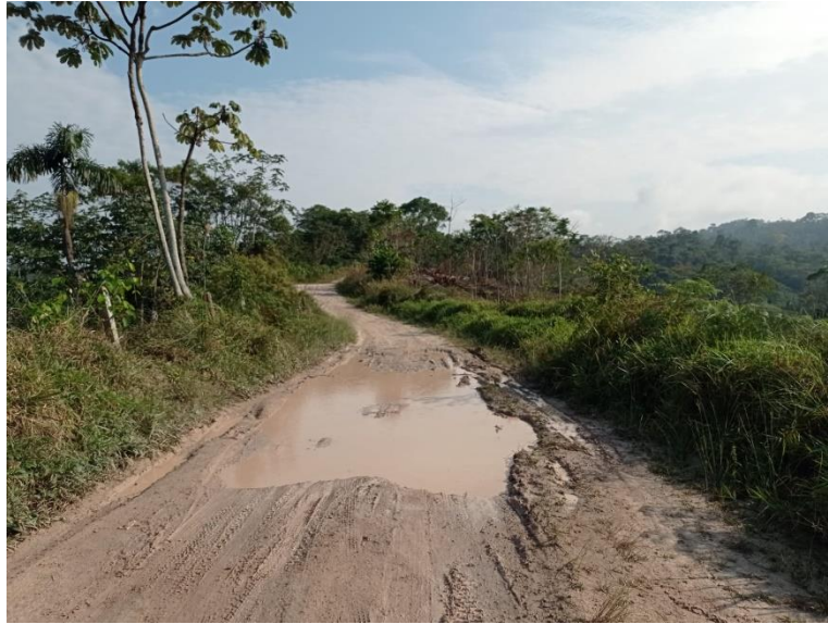
Vista fotográfica: Situación actual donde se observa acumulación de agua en eje de vía por falta de cunetas.
