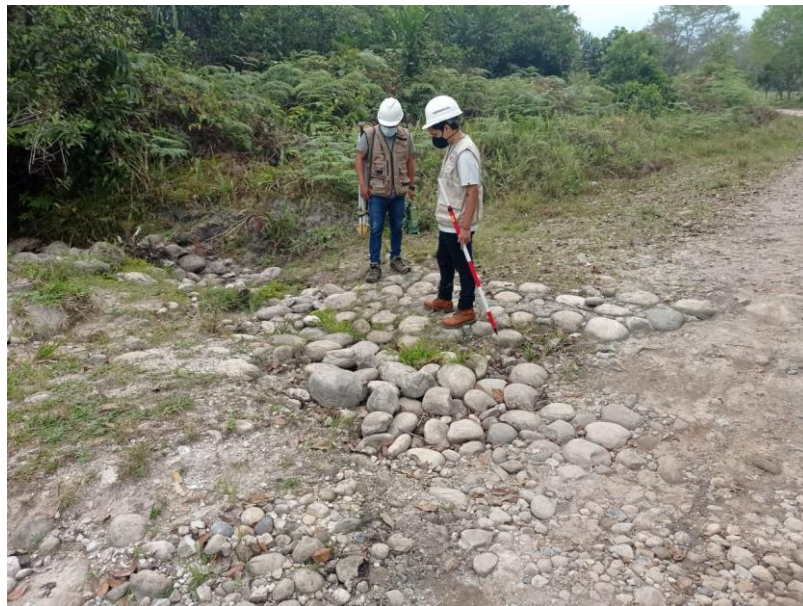
Vista fotográfica: Imagen donde podemos observar deterioro de badén existente.
