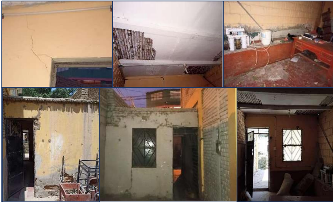
Figura 5. I.E. Federico Villarreal: Bloque “E” estructuralmente debilitado (presencia de grietas en los elementos estructurales y no estructurales), 28-06-2021.
