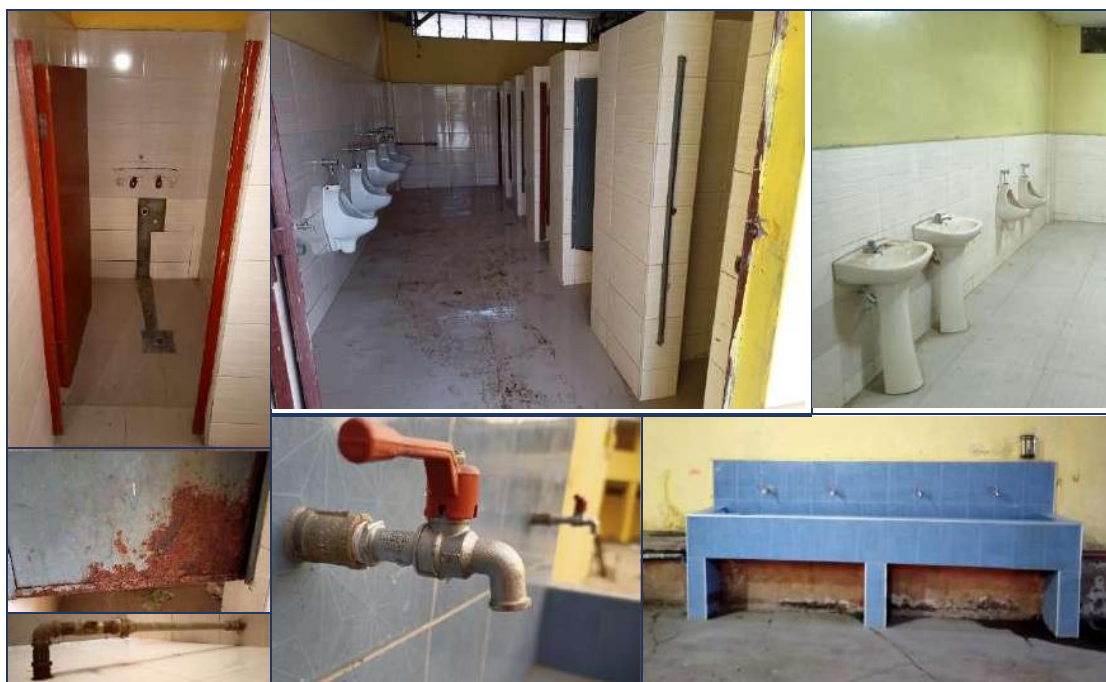
Figura 13. I.E. Federico Villarreal: Instalaciones Sanitarias en condiciones inapropiadas (aparatos sanitarios en mal estado o faltantes, fugas en griferías, puertas de SS.HH. en mal estado y deterioro de accesorios sanitarios), 29-06-2021.
