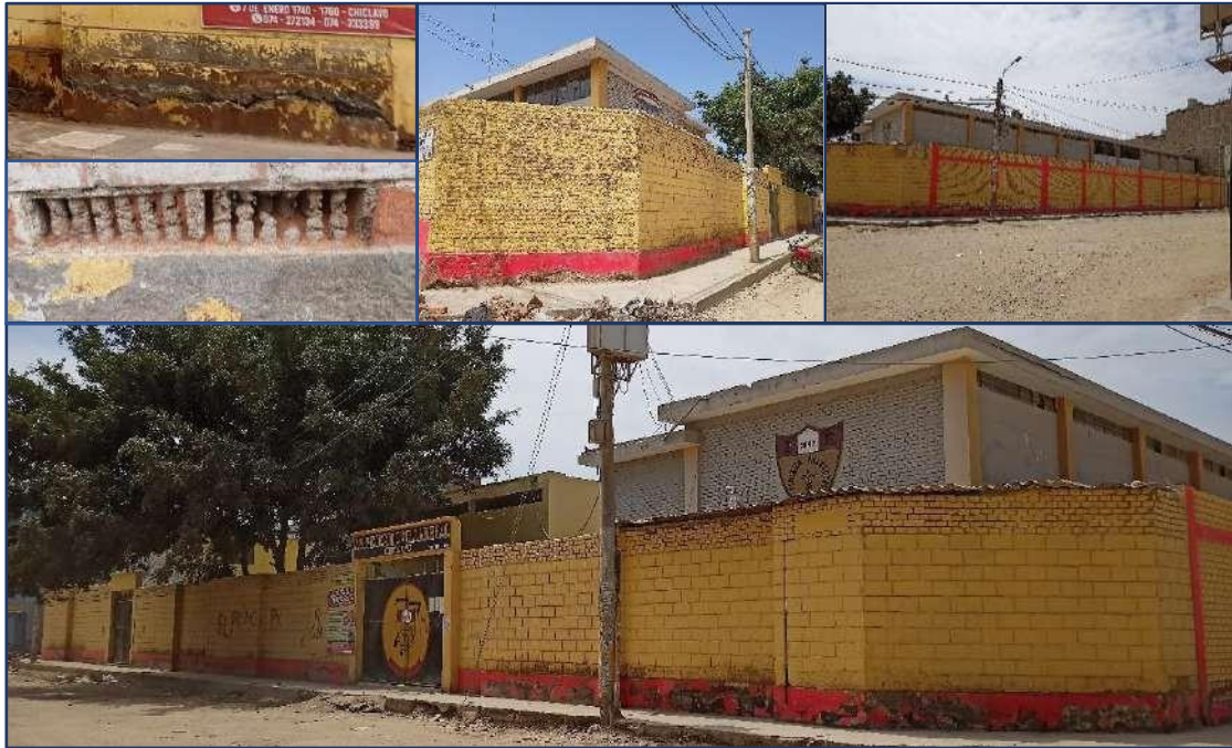
Figura 9. I.E. Federico Villarreal: Cerco Perimétrico con diversas unidades de albañilería y estructuralmente debilitado (ladrillos Caravista y King Kong 18 Huecos; Y presencia de grietas y erosión en sus elementos), 29-06-2021.
