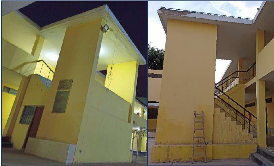
Figura 7. I.E. Federico Villarreal: Escalera “2” con dimensiones inapropiadas y estructuralmente debilitada (presencia de grietas en sus elementos), 28-06-2021.
