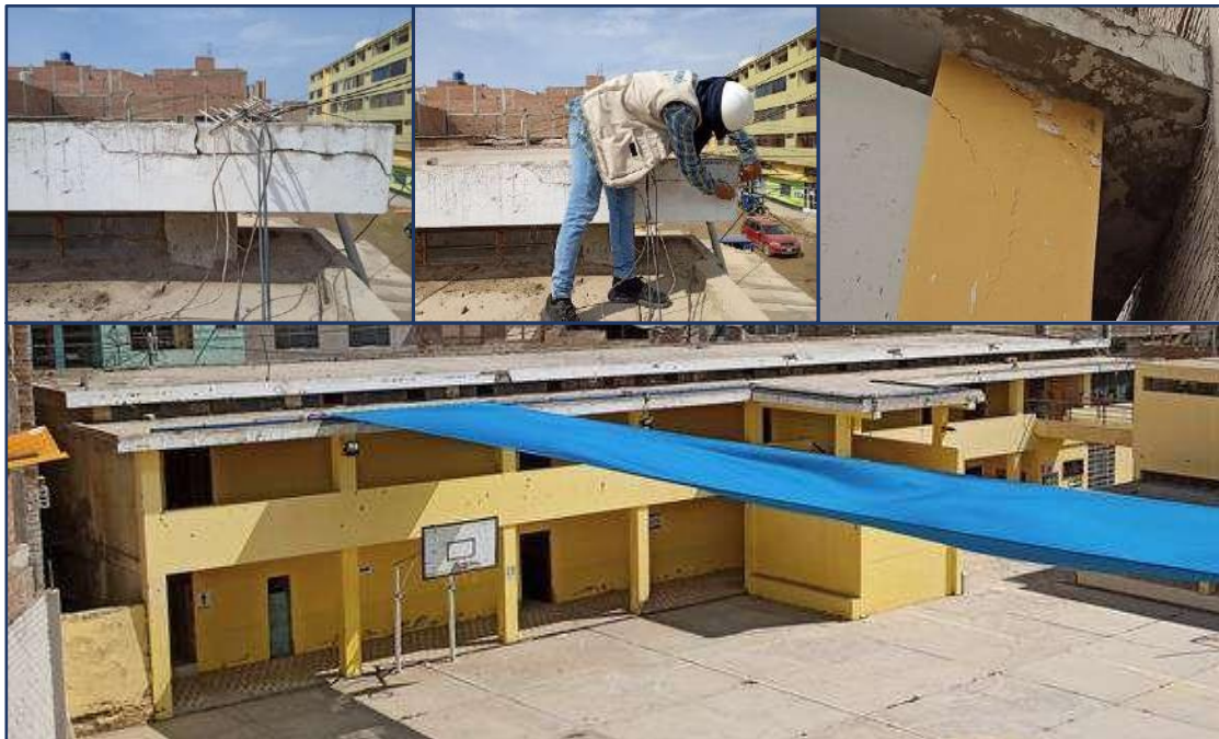
Figura 1. I.E. Federico Villarreal: Bloque “A” estructuralmente debilitado (presencia de grietas en los elementos estructurales y no estructurales), 28-06-2021.
