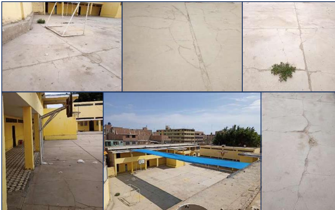
Figura 8. I.E. Federico Villarreal: Losa Deportiva estructuralmente debilitada y sin condiciones óptimas para funcionalidad (presencia de grietas en sus paneles, colmatación de juntas con elementos vegetales, falta de cobertura y fallas de luminarias), 28-06-2021.
