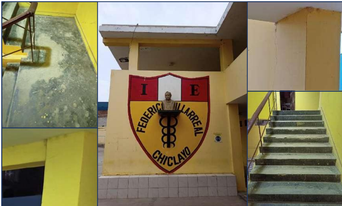
Figura 6. I.E. Federico Villarreal: Escalera “1” con pasamanos a un solo lado y estructuralmente debilitada (presencia de grietas en sus elementos), 28-06-2021.
