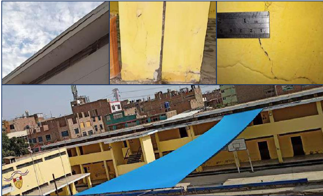
Figura 3. I.E. Federico Villarreal: Bloque “C” estructuralmente debilitado (presencia de grietas en los elementos estructurales y no estructurales), 28-06-2021.
