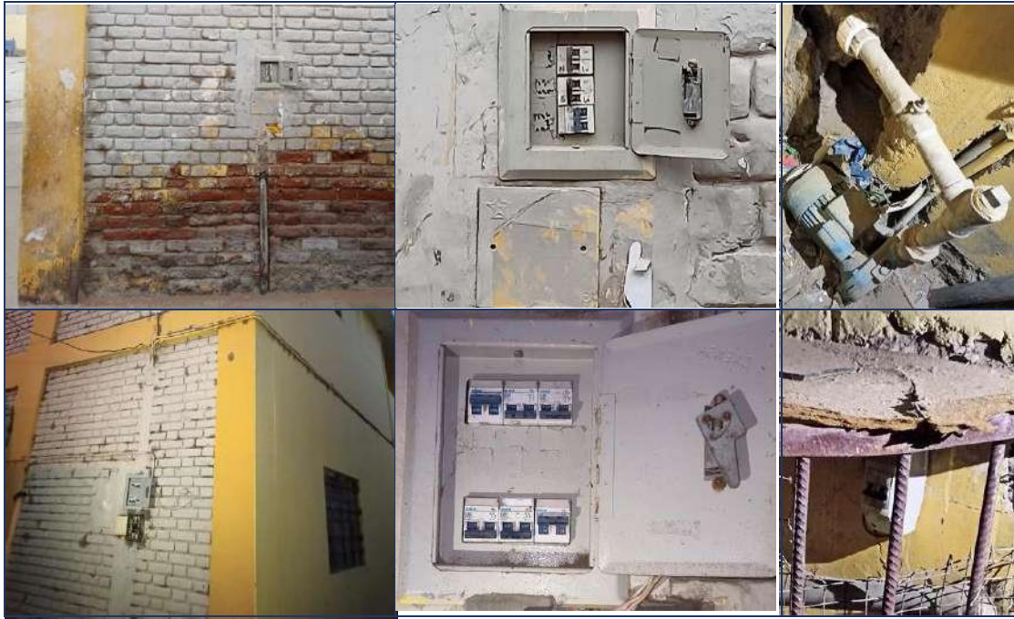
Figura 16. I.E. Federico Villarreal: Instalaciones Eléctricas parcialmente funciones y peligrosas (tableros eléctricos mal ubicados y habilitados; Y electrobomba de 1 HP deteriorada), 30-06-2021.
