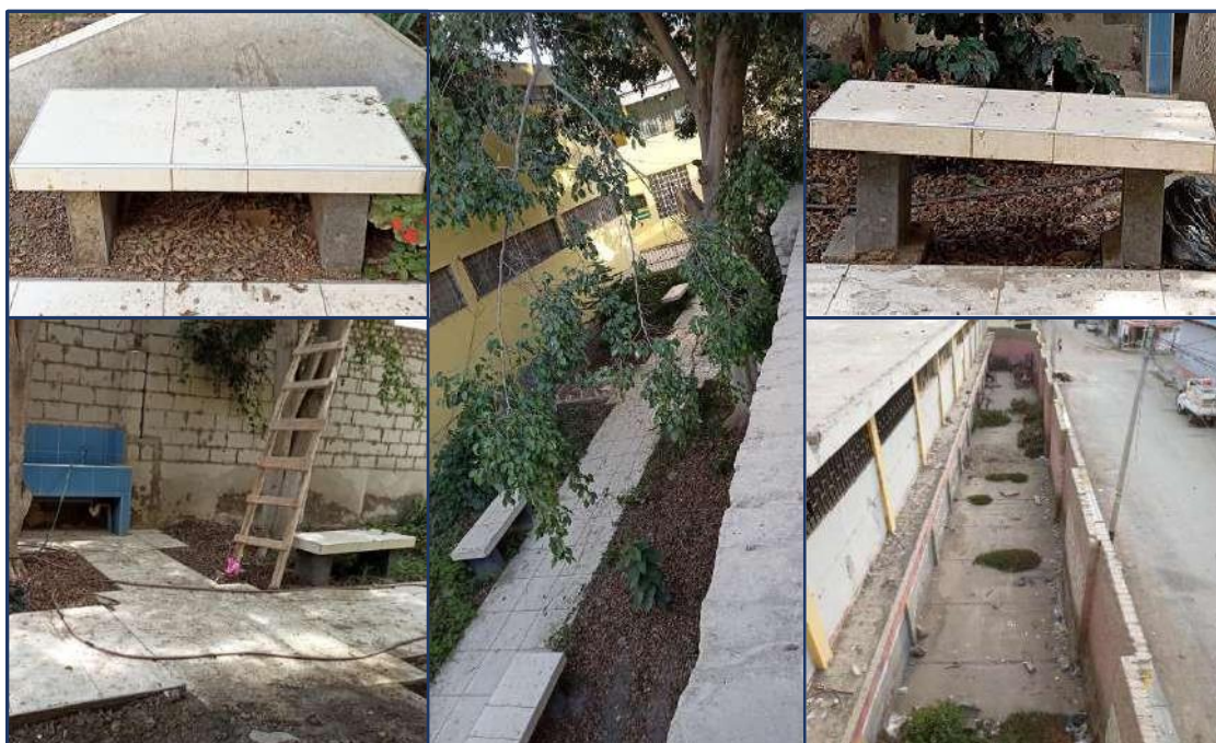
Figura 11. I.E. Federico Villarreal: Áreas de Circulación y Descanso con infraestructura en mal estado (bancas deterioradas y pisos dañados), 29-06-2021.
