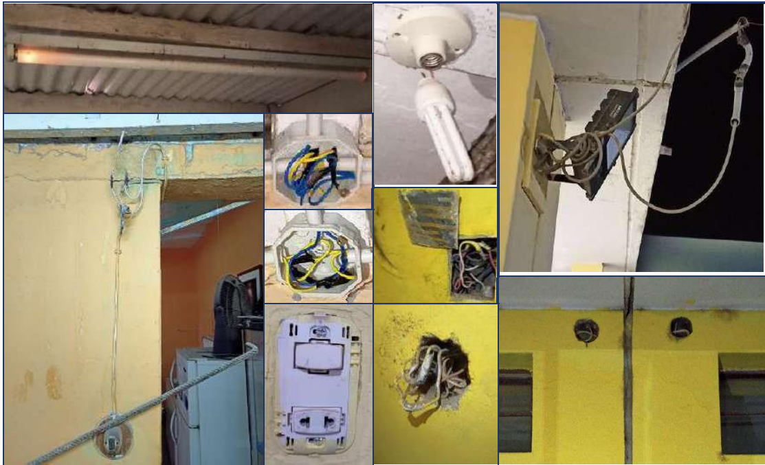
Figura 15. I.E. Federico Villarreal: Instalaciones Eléctricas en mal estado y peligrosas (accesorios eléctricos deteriorados, cables de circuitos expuestos y ausencia de iluminación de emergencia), 30-06-2021.
