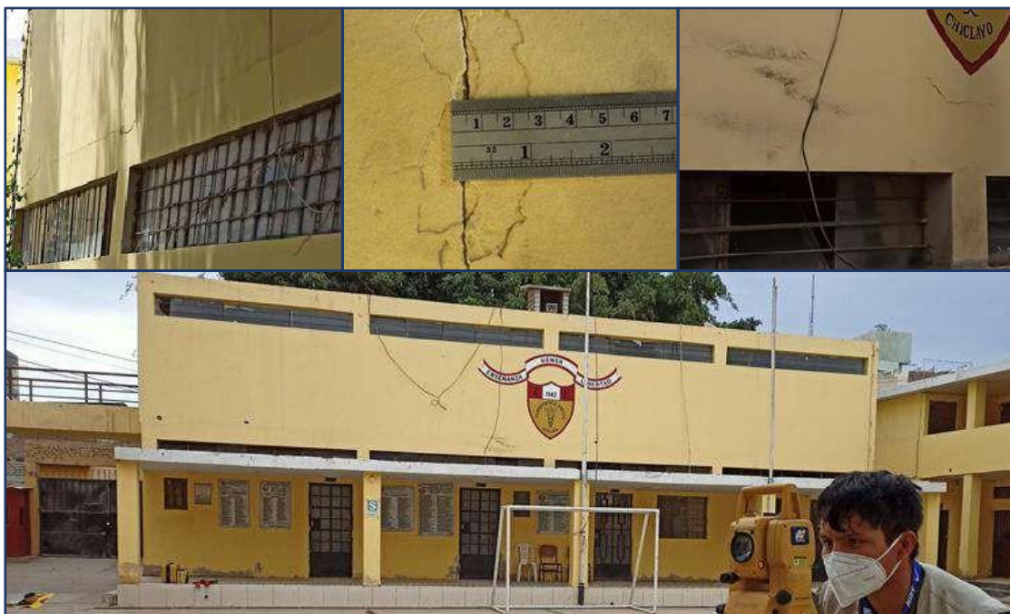
Figura 2. I.E. Federico Villarreal: Bloque “B” estructuralmente debilitado (presencia de grietas en los elementos estructurales y no estructurales), 28-06-2021.
