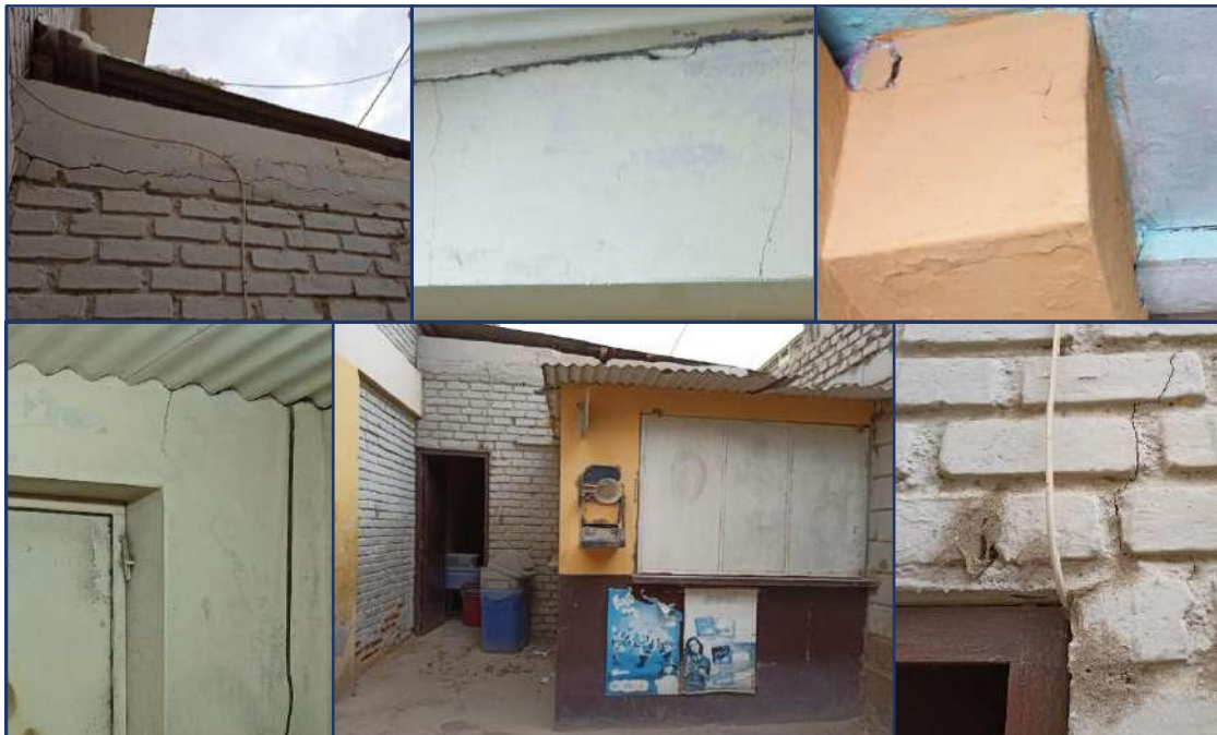
Figura 4. I.E. Federico Villarreal: Bloque “D” estructuralmente debilitado (presencia de grietas en los elementos estructurales y no estructurales), 28-06-2021.
