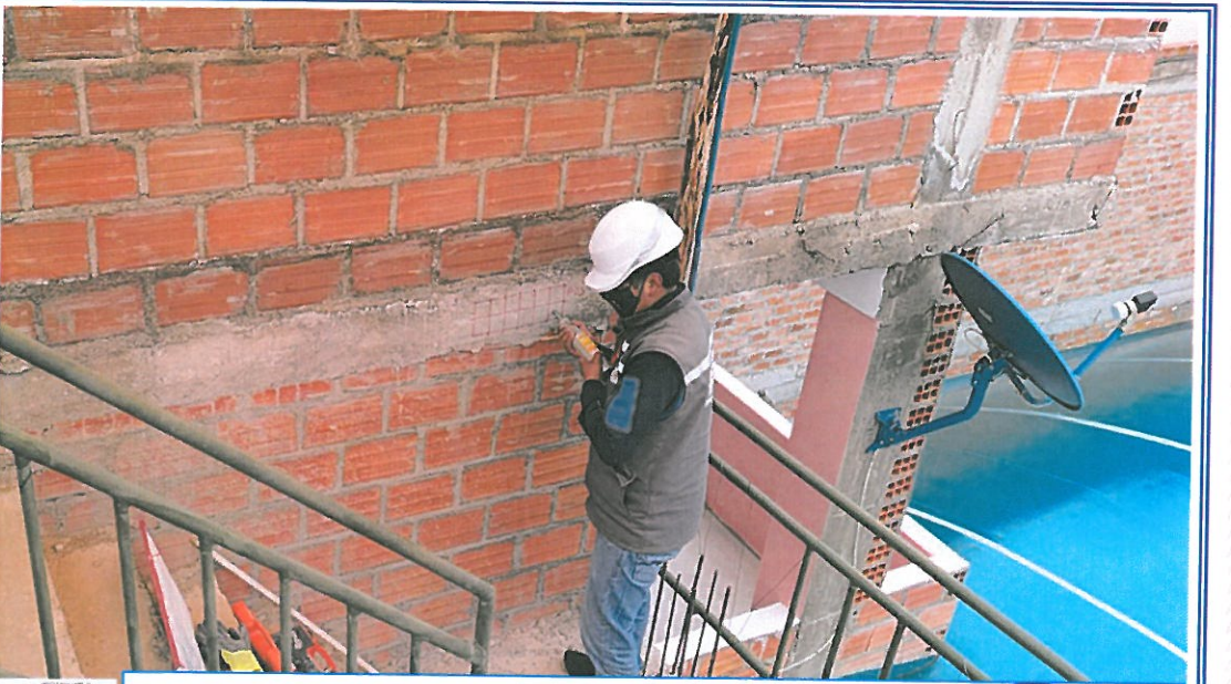
VISTA 10: REALIZANDO EL ENSAYO DE ESCLEROMETRIA PUNTO-03, PROYECTO UNIFAMILIAR URB. VALLECITO – PUNO.
