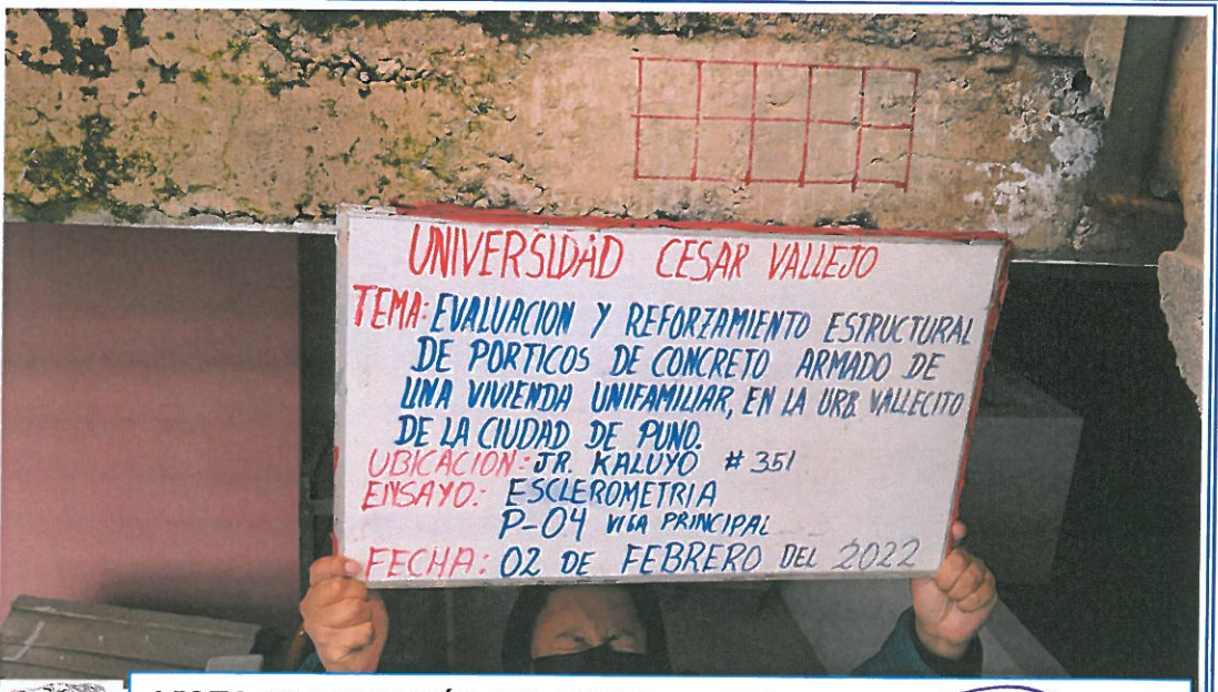
VISTA 12: UBICACIÓN DEL PUNTO-04, ENSAYO DE ESCLEROMETRIA, PROYECTO UNIFAMILIAR URB. VALLECITO – PUNO.
