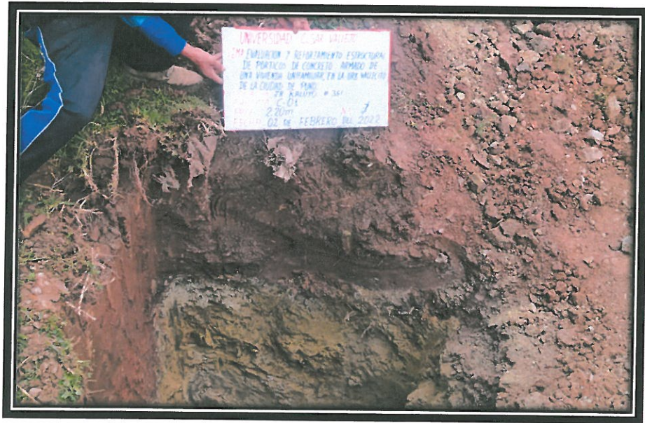
Figura 13: vista de la Calicata, en donde se registra las características físicas mecánicas del suelo.
