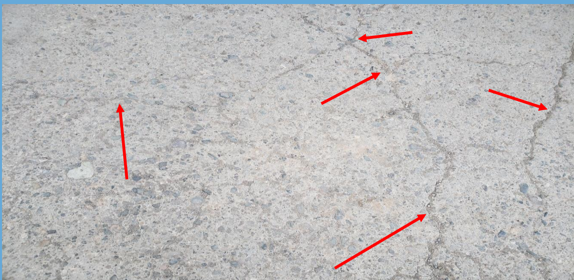
Fotografía 34. Reconocimiento de fallas tipo fisura de contraccion de severidad alta. Puno 2021.
