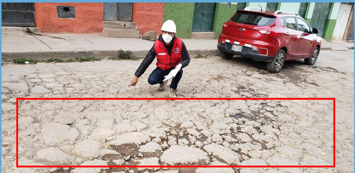
Fotografía 04. Reconocimiento de fallas tipo punzonamiento de severidad alta. Puno 2021.
