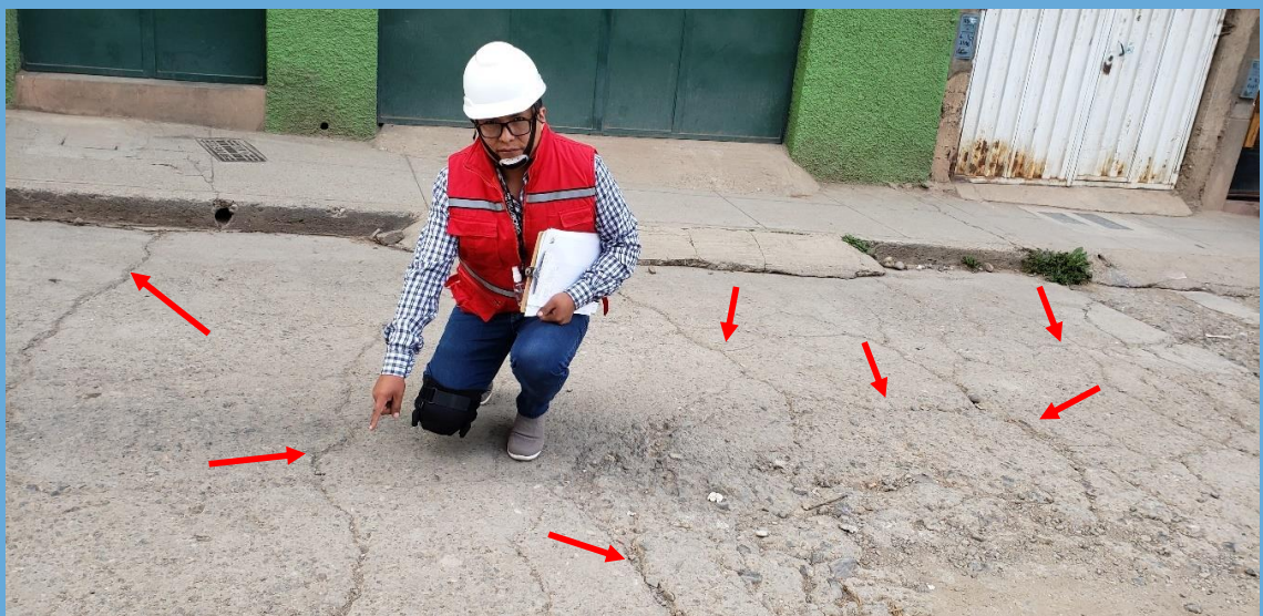
Fotografía 06. Reconocimiento de fallas tipo losa dividida de severidad alta. Puno 2021.
