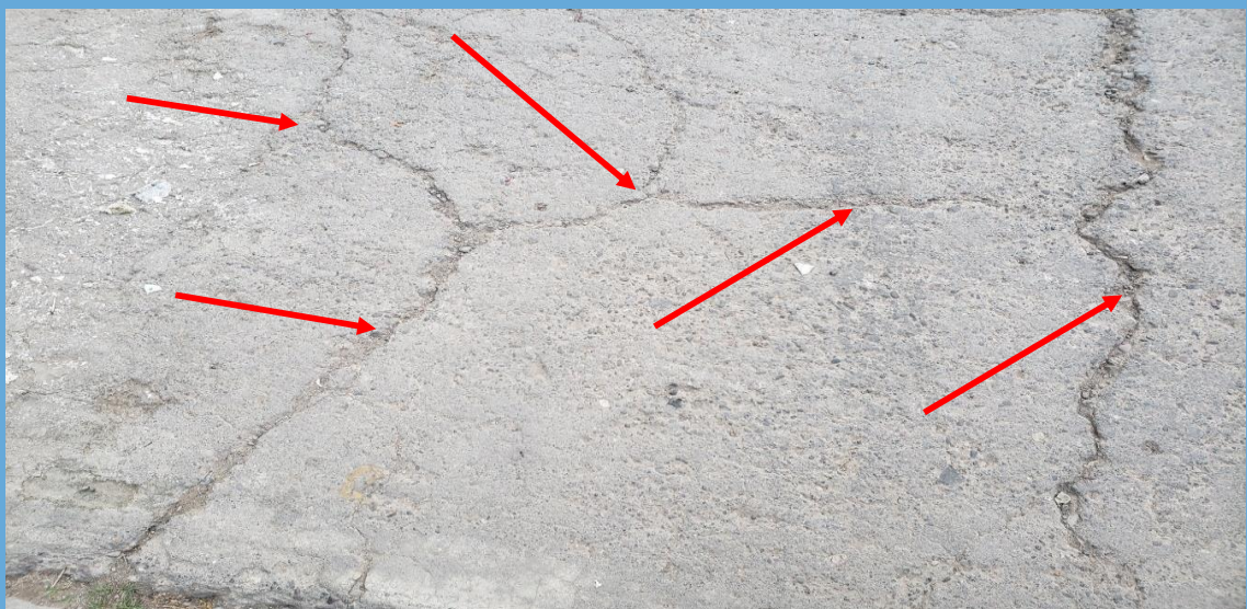
Fotografía 38. Reconocimiento de fallas tipo losa dividida de severidad media. Puno 2021.
