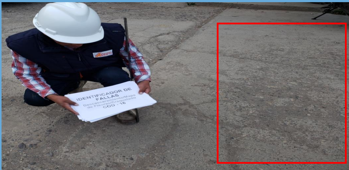
Fotografía 29. Reconocimiento de fallas tipo punzonamiento de severidad alta. Puno 2021.
