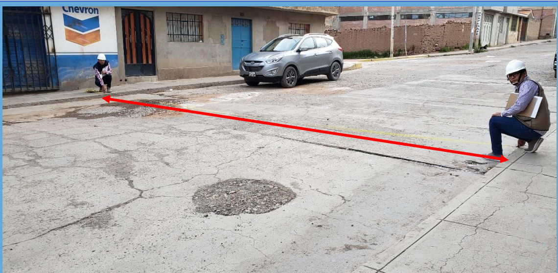
Fotografía 14. UNIDAD DE MUESTRA N° 02: Ubicado en el Jr. Dante Nava de la ciudad de Puno. Tramo 02 conformado por 34 paños (ambos sentidos).
