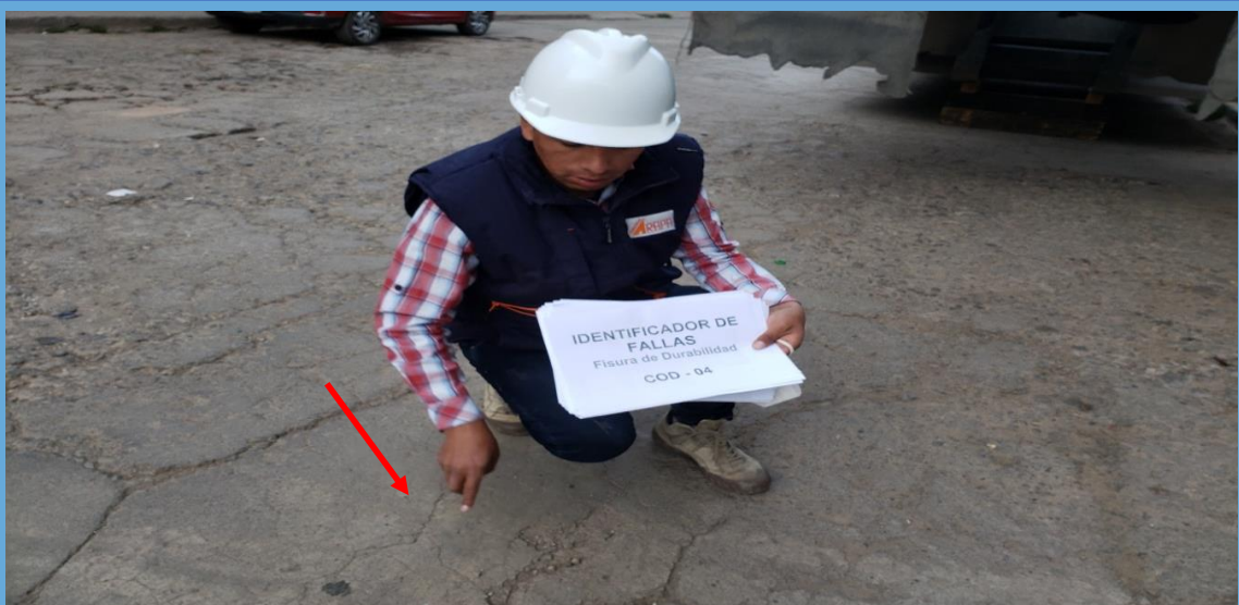
Fotografía 32. Reconocimiento de fallas tipo losa dividida de severidad alta. Puno 2021.
