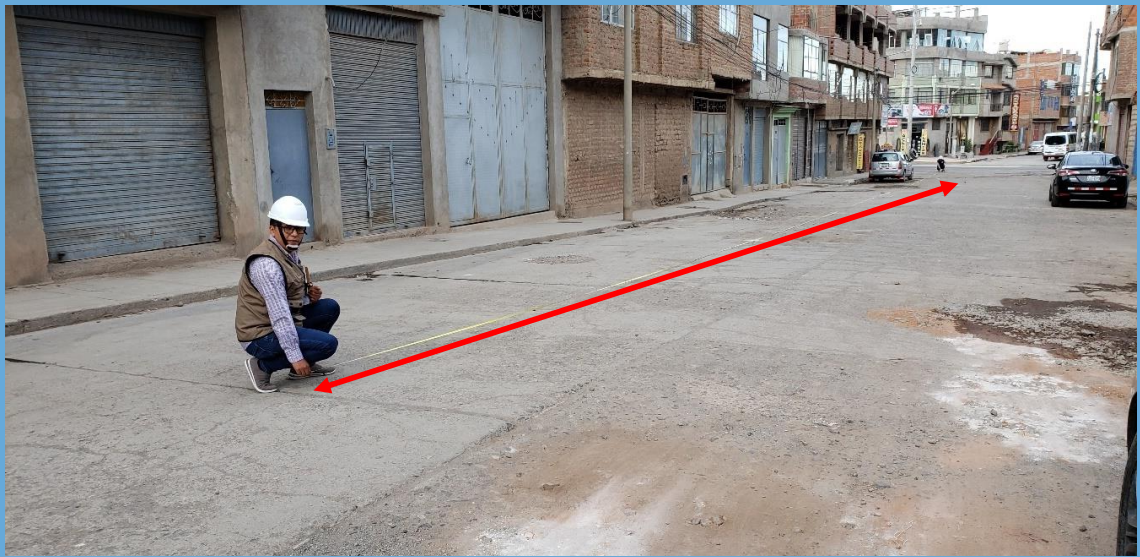
Fotografía 13. UNIDAD DE MUESTRA N° 02: Ubicado en el Jr. Dante Nava de la ciudad de Puno. Tramo 02 conformado por 34 paños (ambos sentidos).
