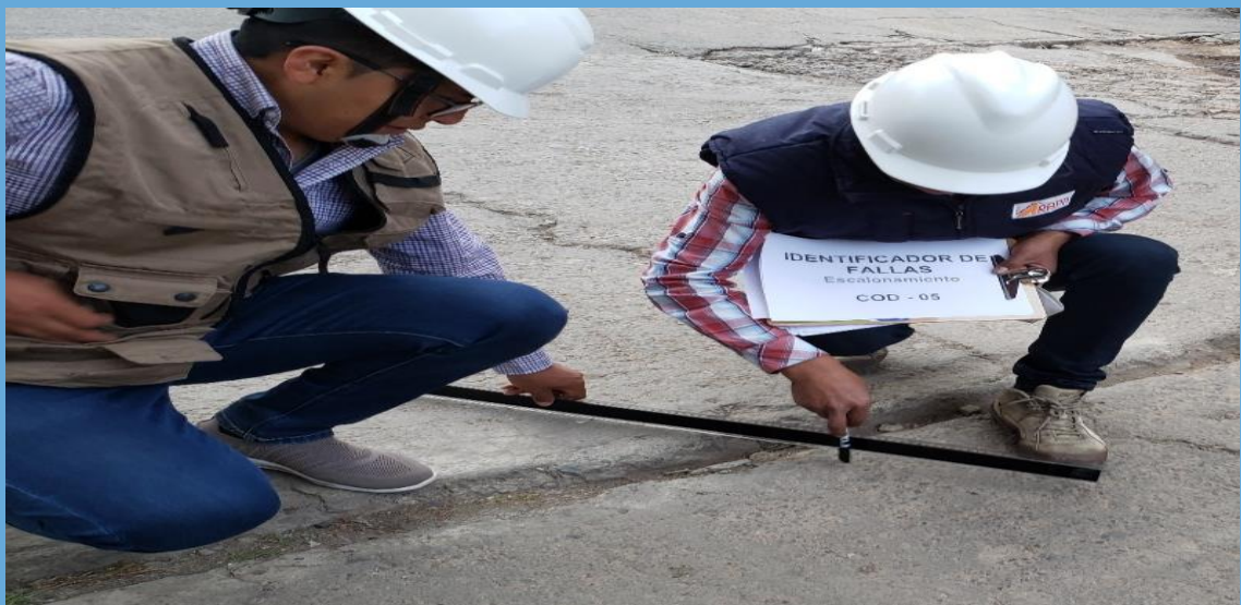
Fotografía 21. Reconocimiento de fallas tipo escalonamiento de severidad alta. Puno 2021.
