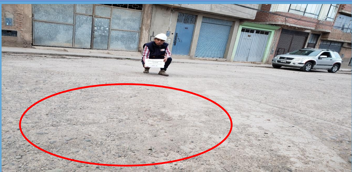
Fotografía 28. Reconocimiento de fallas tipo descascaramiento / mapa de fisuras / craquelado de severidad alta. Puno 2021.
