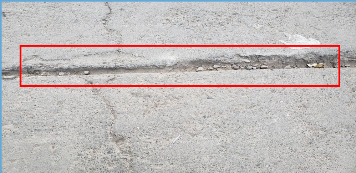
Fotografía 35. Reconocimiento de fallas tipo descascaramiento de junta de severidad media. Puno 2021.
