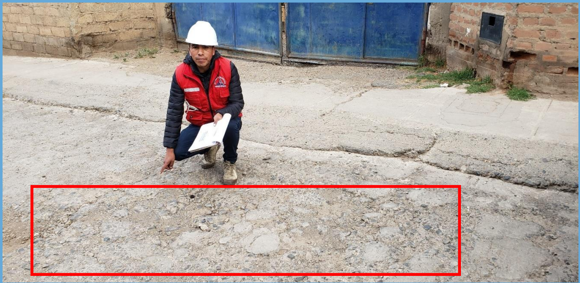
Fotografía 05. Reconocimiento de fallas tipo descascaramiento / mapa de fisuras / craquelado de severidad alta. Puno 2021.
