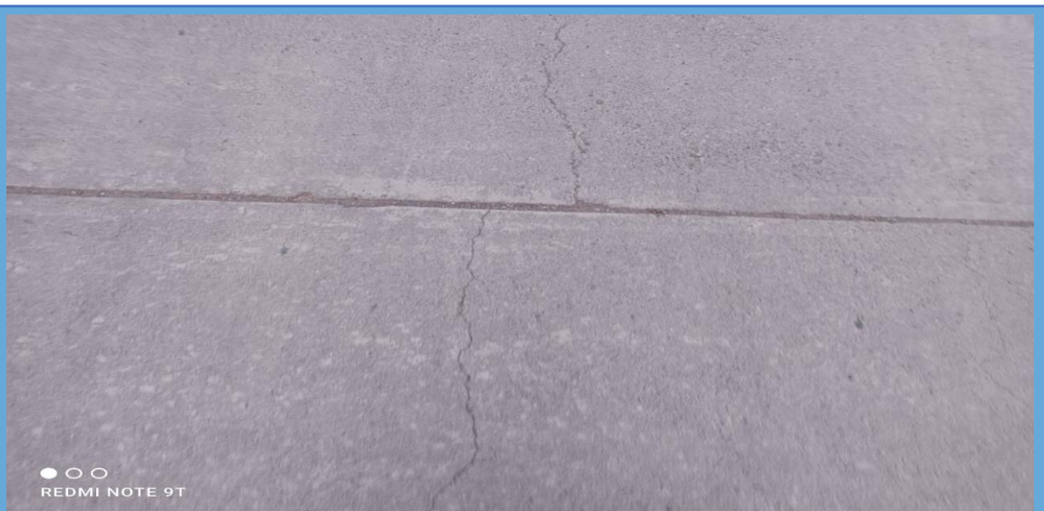
Fotografía 46. Reconocimiento de fallas tipo fisuras de contracción de severidad alta – UM 02. Puno 2021.
