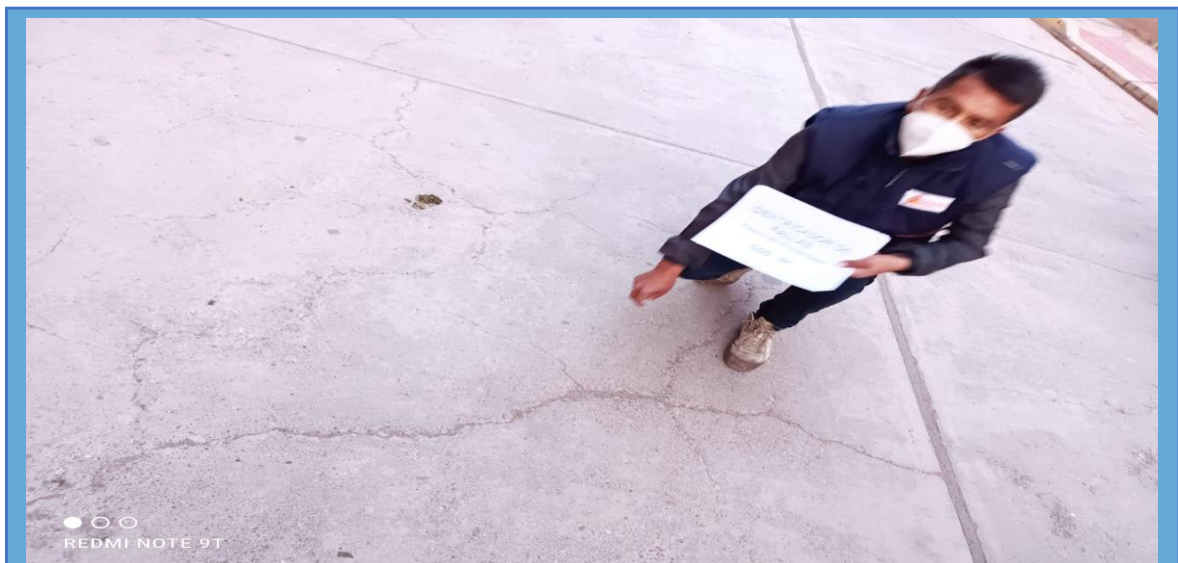
Fotografía 42. Reconocimiento de fallas tipo losa dividida de severidad alta. Puno 2021.
