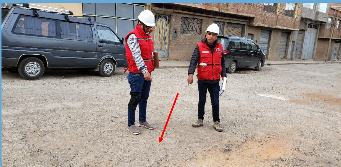
Fotografía 10. Reconocimiento de fallas tipo Levantamiento/Pandeo de severidad alta. Puno 2021.
