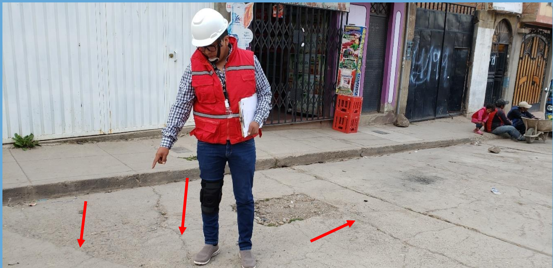
Fotografía 09. Reconocimiento de fallas tipo losa dividida de severidad alta. Puno 2021.
