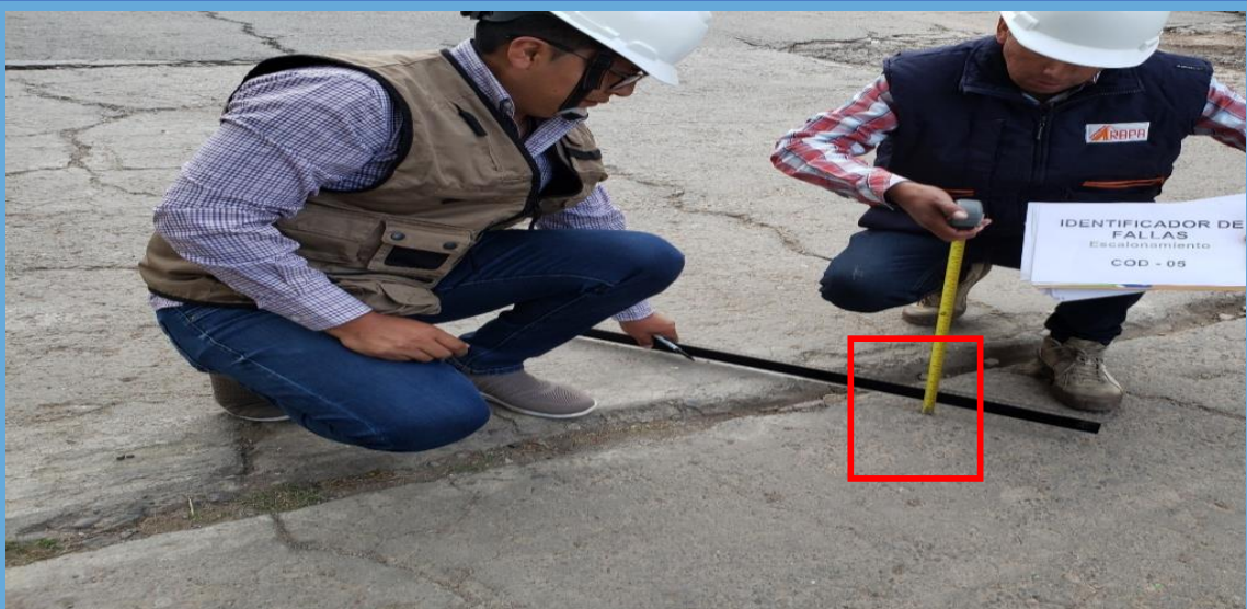
Fotografía 22. Reconocimiento de fallas tipo escalonamiento de severidad alta. Puno 2021.
