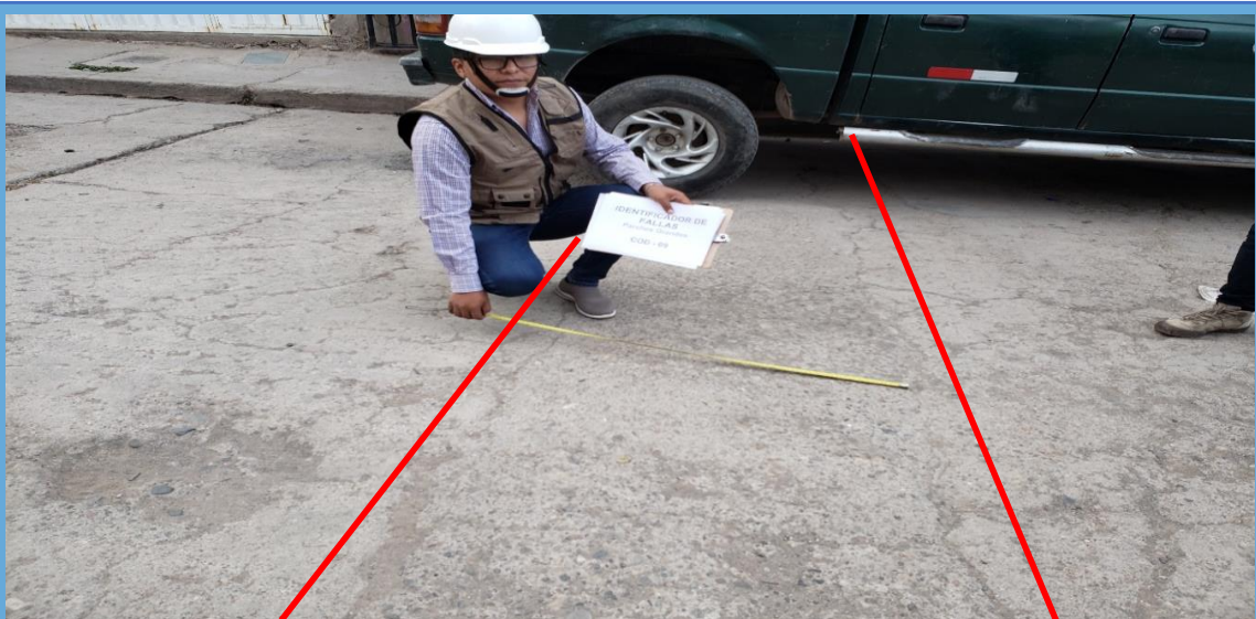
Fotografía 24. Reconocimiento de fallas tipo parches grandes de severidad alta. Puno 2021.
