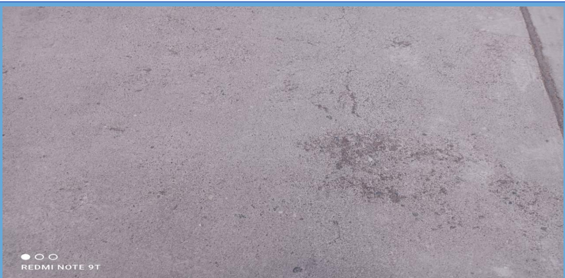
Fotografía 48. Reconocimiento de fallas descascaramiento/mapa de fisuras/craquelado de severidad baja – UM 02. Puno 2021.
