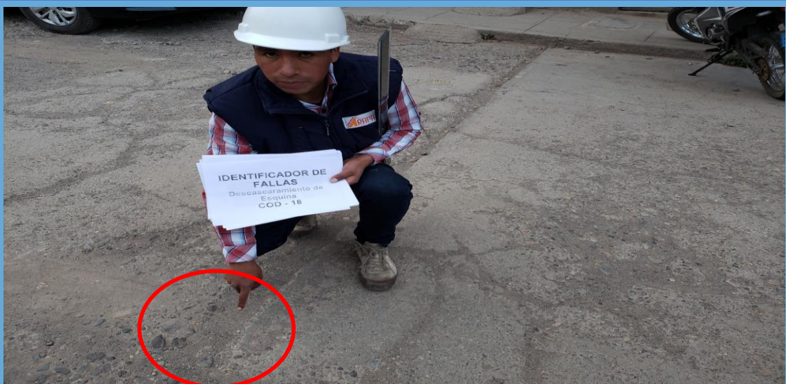
Fotografía 26. Reconocimiento de fallas tipo descascaramiento de junta de severidad alta. Puno 2021.
