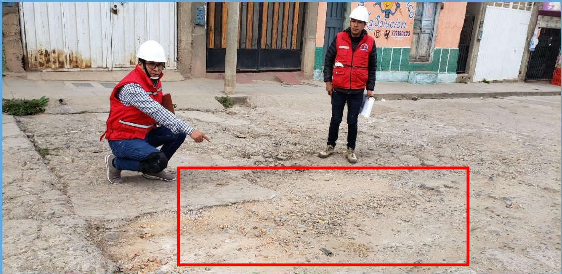
Fotografía 07. Reconocimiento de fallas tipo punzonamiento de severidad alta. Puno 2021.
