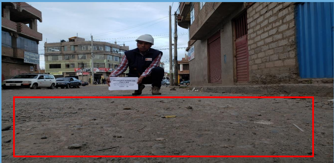
Fotografía 31. Reconocimiento de fallas tipo descascaramiento / mapa de fisuras / craquelado de severidad alta. Puno 2021.
