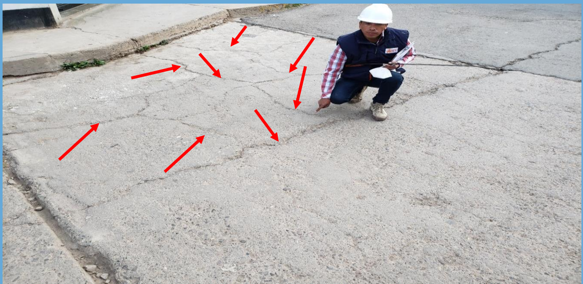
Fotografía 15. Reconocimiento de fallas tipo losa dividida de severidad alta. Puno 2021.
