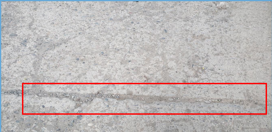
Fotografía 37. Reconocimiento de fallas tipo descascamiento de junta de severidad media. Puno 2021.
