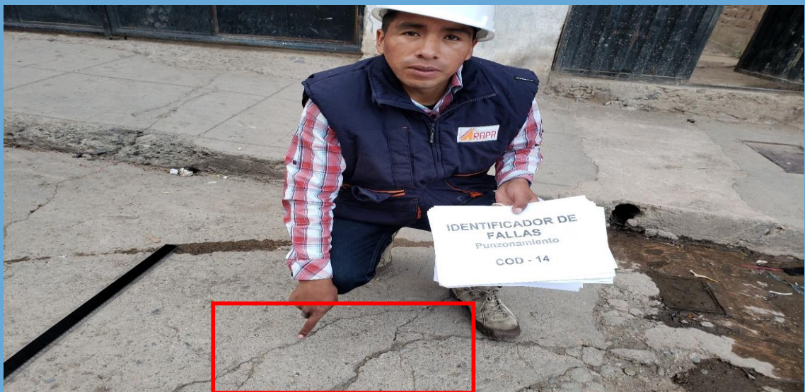
Fotografía 25. Reconocimiento de fallas tipo de severidad. Puno 2021.
