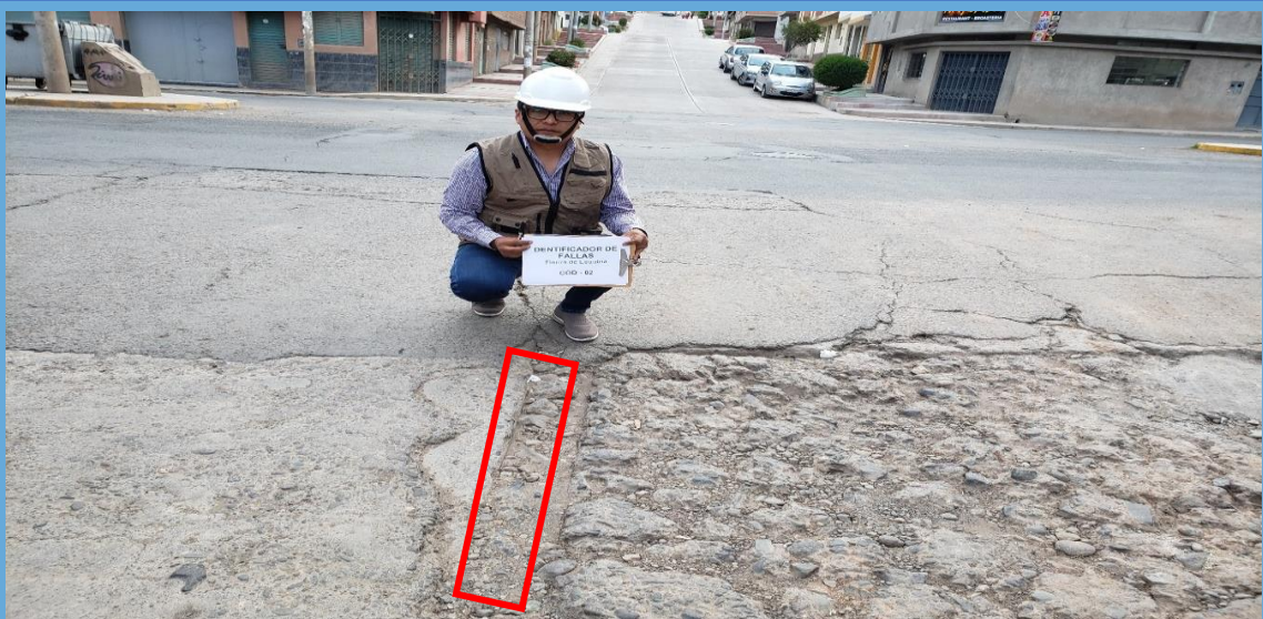
Fotografía 20. Reconocimiento de fallas tipo descascamiento de junta de severidad alta. Puno 2021.
