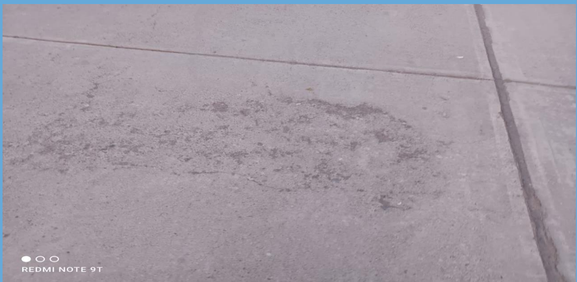
Fotografía 47. Reconocimiento de fallas descascaramiento/mapa de fisuras/craquelado de severidad baja – UM 02. Puno 2021.
