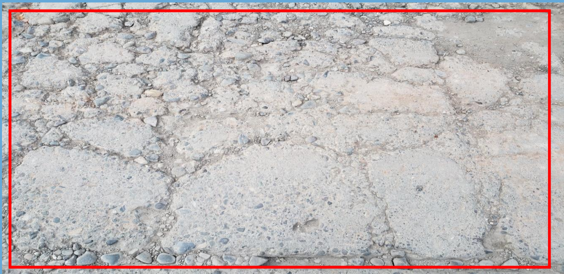
Fotografía 33. Reconocimiento de fallas tipo punzonamiento de severidad alta. Puno 2021.
