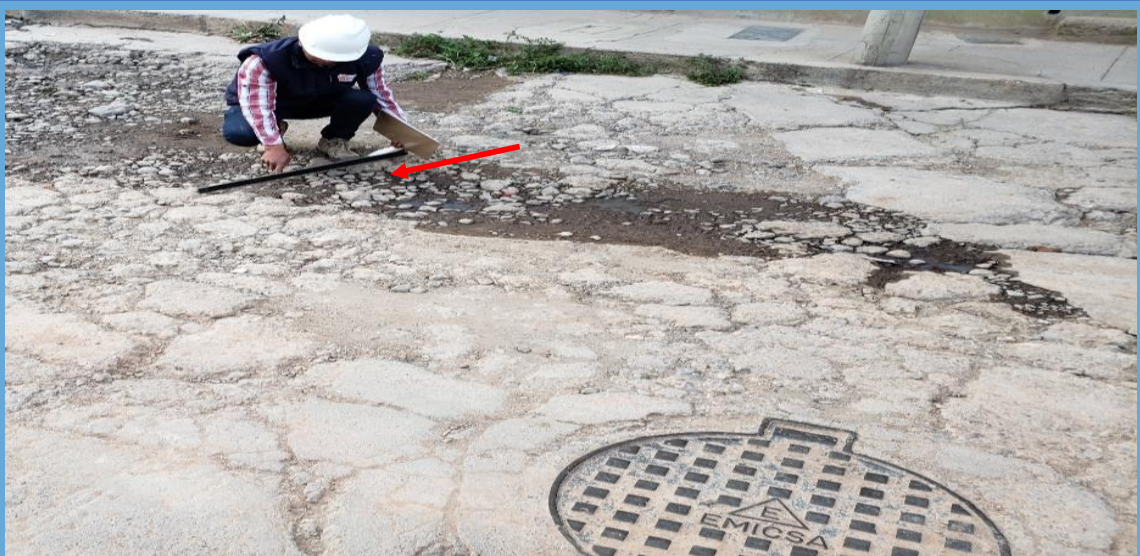
Fotografía 16. Reconocimiento de fallas tipo punzonamiento de severidad alta. Puno 2021.
