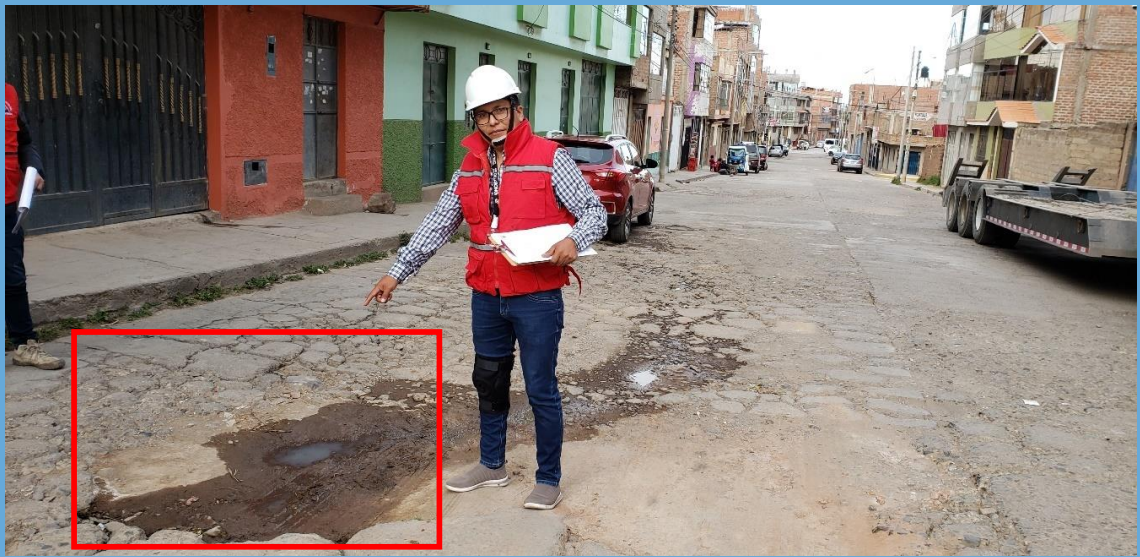
Fotografía 03. Reconocimiento de fallas tipo punzonamiento de severidad alta . Puno 2021.
