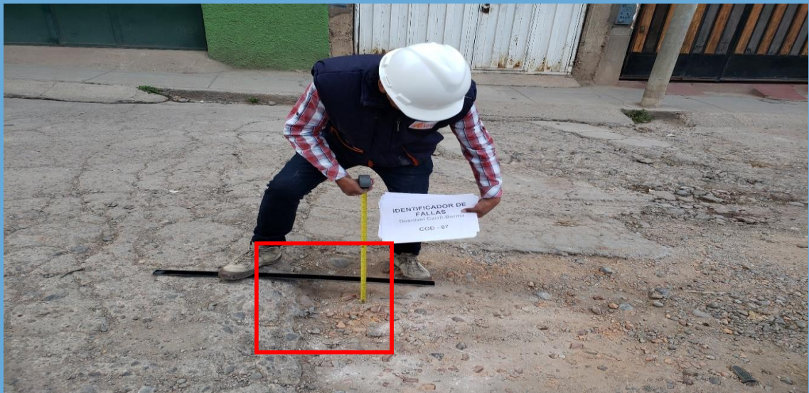
Fotografía 23. Reconocimiento de fallas tipo escalonamiento de severidad alta. Puno 2021.
