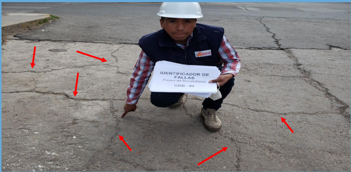
Fotografía 19. Reconocimiento de fallas tipo losa dividida de severidad – UM 02. Puno 2021.
