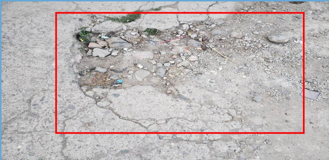
Fotografía 39. Reconocimiento de fallas tipo punzonamiento de severidad alta. Puno 2021.
