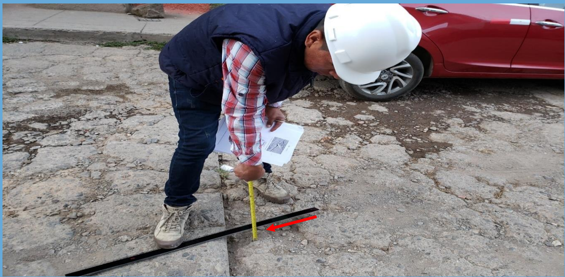
Fotografía 17. Reconocimiento de fallas tipo escalonamiento de severidad alta. Puno 2021.
