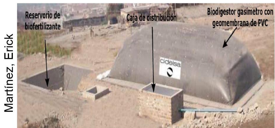
Biodigestor tipo industrial
