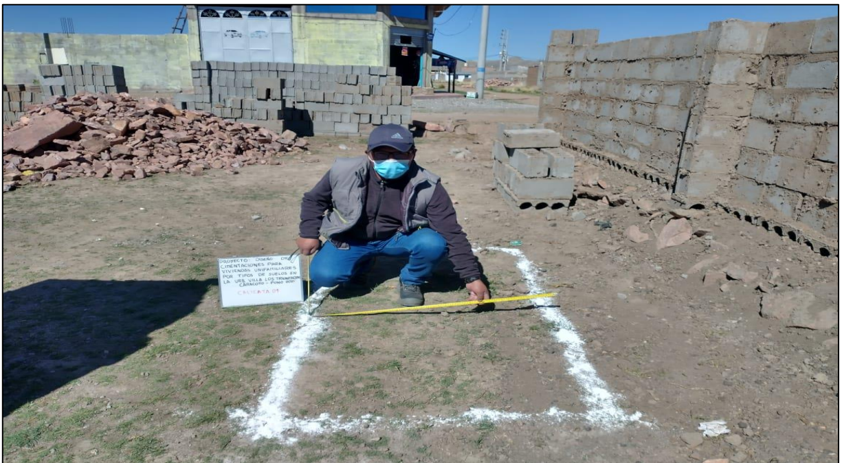
2.- Ubicación y trazo de calcatas dentro del proyecto, para determinar la capacidad portante del suelo.
