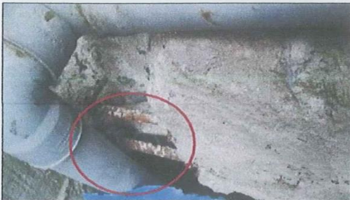
Acero de refuerzo expuesto en viga.
