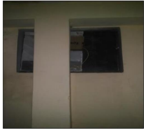
Ventanas mal ubicadas y columnas cortas
