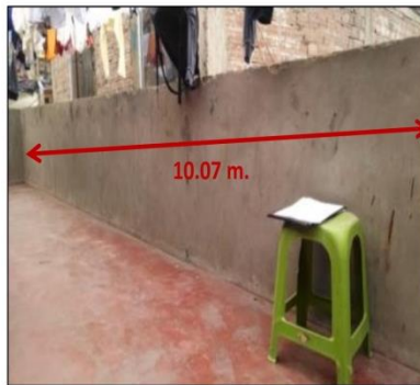
Parapetos mas de 10 metros sin confinar.
