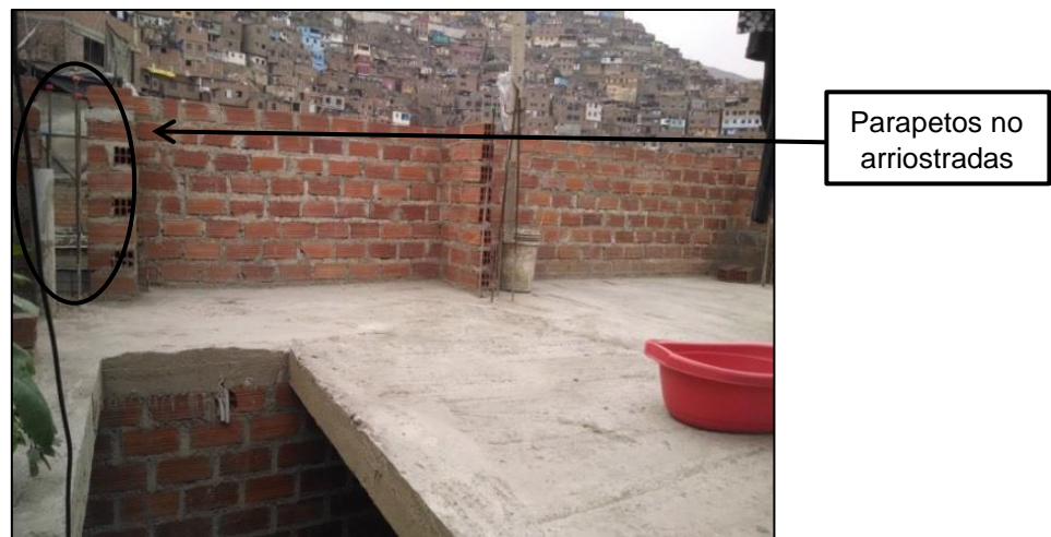
Figura 24: Viviendas con parapetos sin arrioste.
