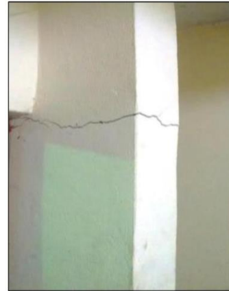
Grietas en muros
