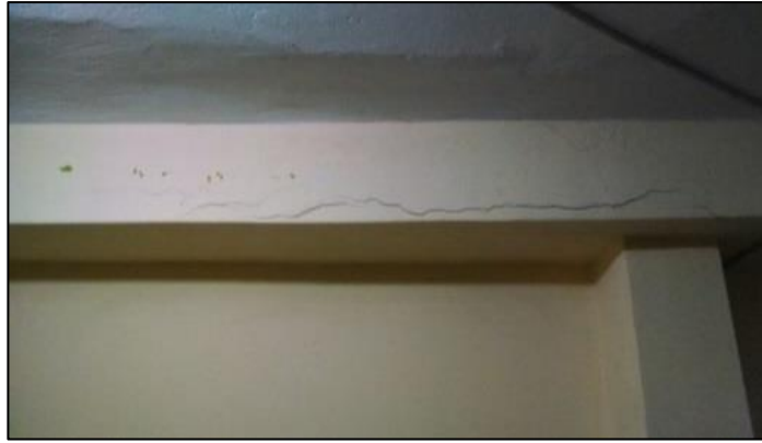
Figura 39: Fisuras en vigas.
