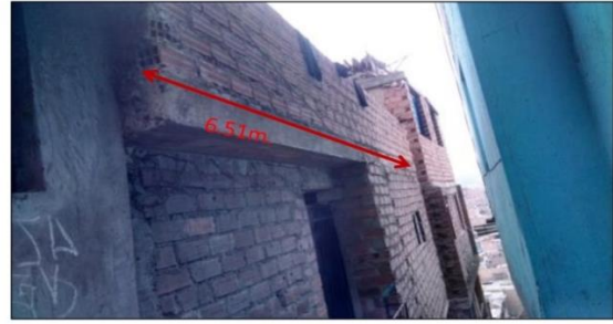
Parapetos no arriostrados.
