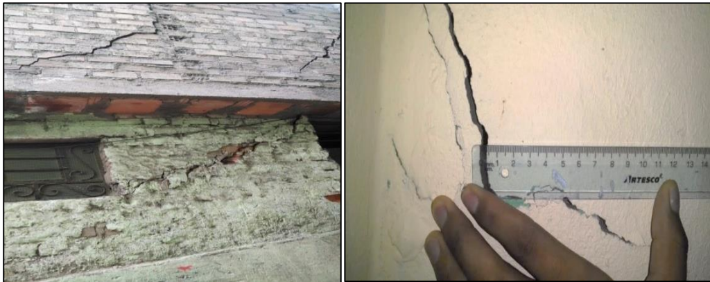
Figura 38: Viviendas con muros agrietados.
