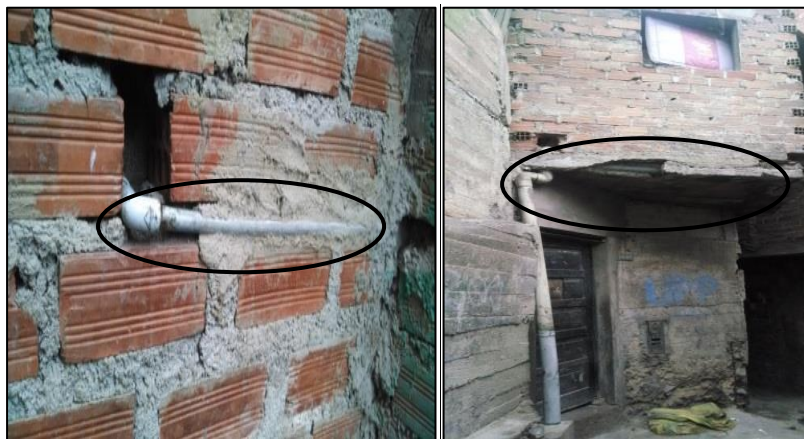
Figura 36: Mala instalación de las tuberías de agua y desagüe.
