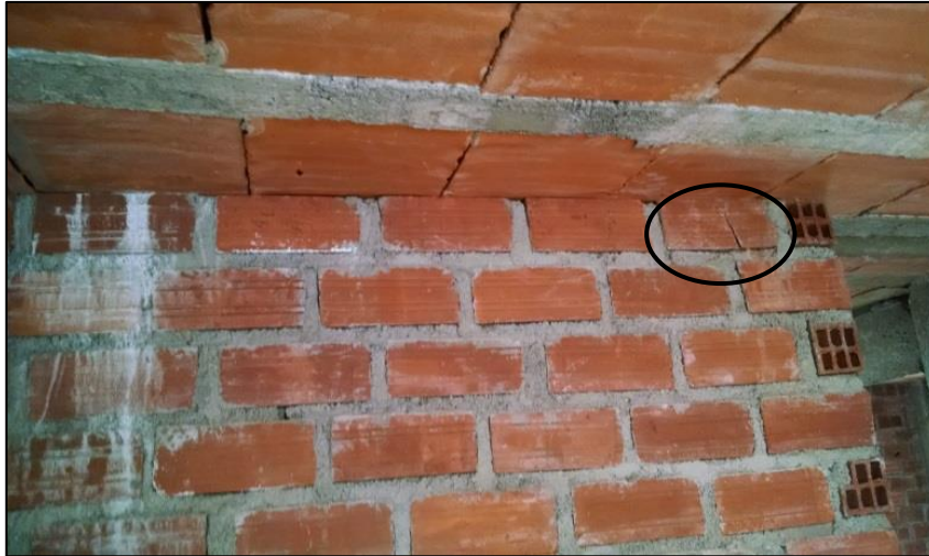
Figura 25: Viviendas sin viga solera.
