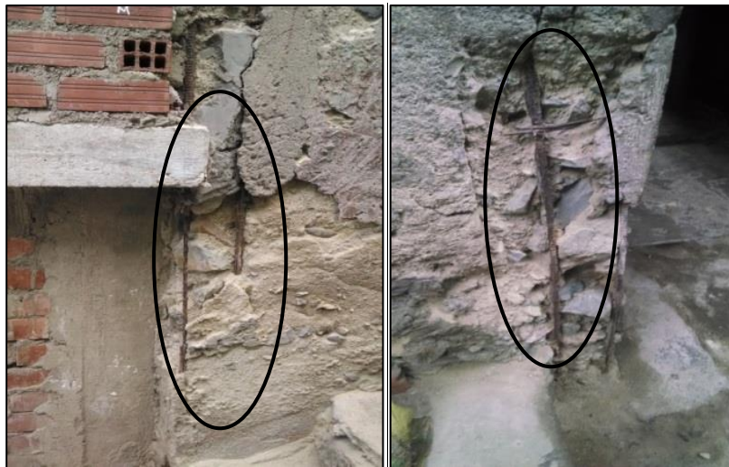
Figura 32: Exposición de acero de refuerzo en columna.
