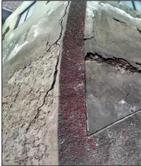
Figura 28: Muros inadecuados para soportar las fuerzas laterales.
