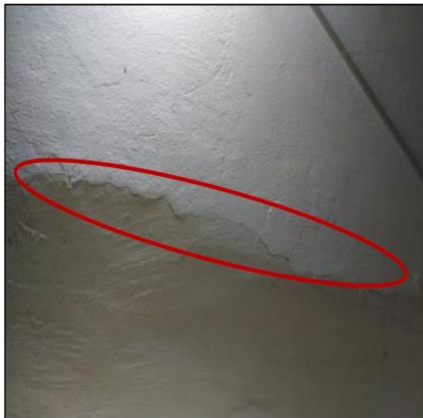
Fisuras en techo
