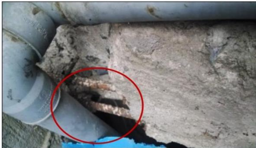
Acero de refuerzo expuesto en viga.
