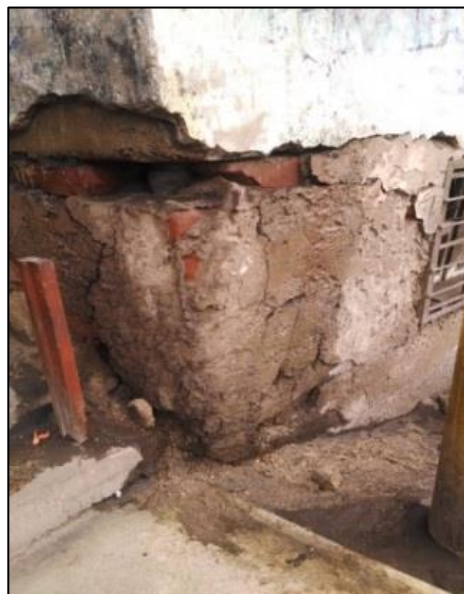
Figura 40: Viviendas con muros húmedos.
