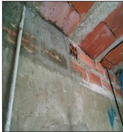
Tubería de desagüe al aire libre.
