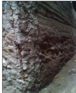
Cimientos descubiertos y aceros de re refuerzo corroídos.
