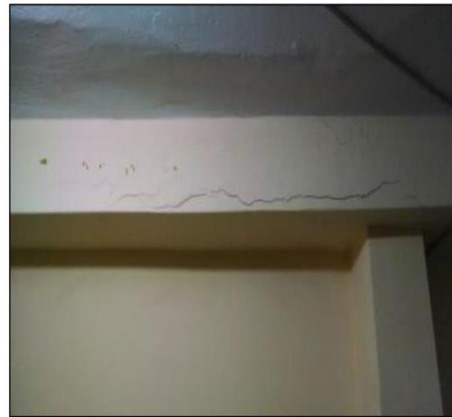
Grietas en vigas
