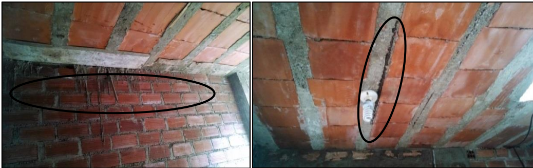
Figura 34: Exposición de acero de refuerzo en el techo por inadecuado mano de obra en el encofrado.
