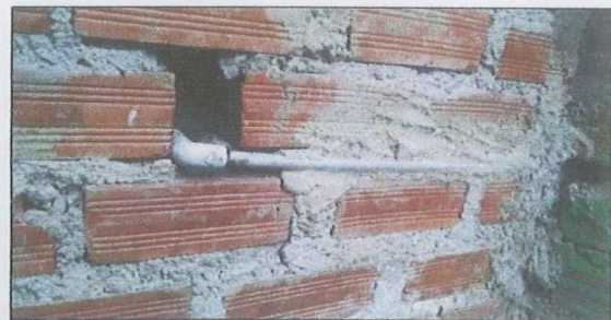
Mala instalación de tuberías de agua.
