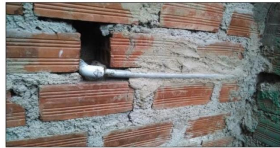
Mala instalación de tuberías de agua.
