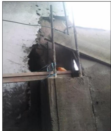
Exposición de acero de refuerzo a la intemperie
