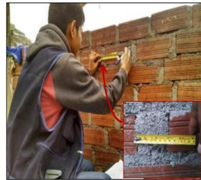
Muros con juntas verticales y horizontales mayores a 1.5 cm.
