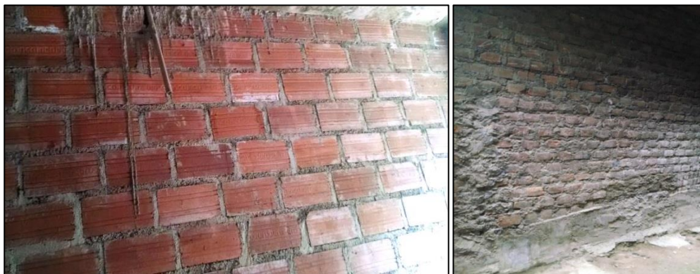
Figura 42: Viviendas con mala calidad de ladrillos.
