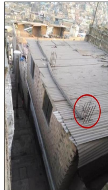
Aceros de refuerzo expuestos a la intemperie
