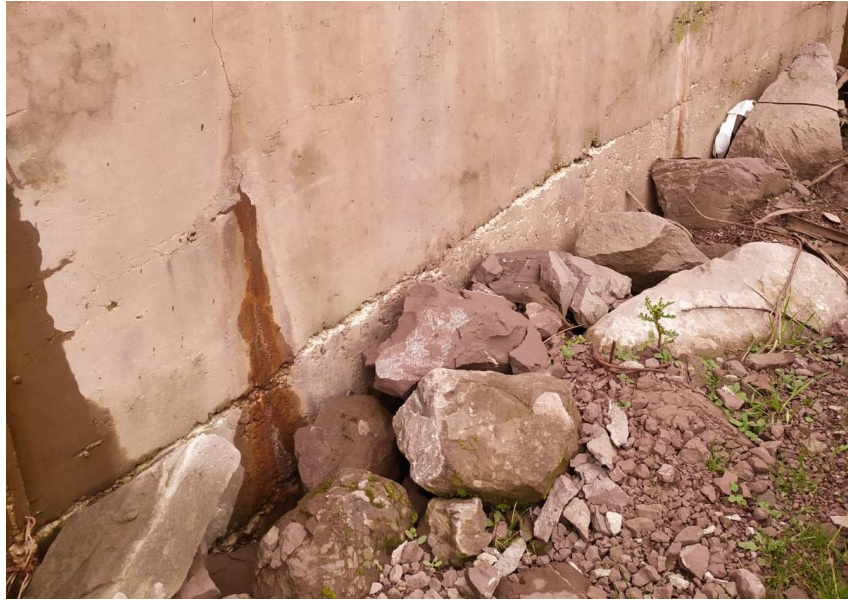
Figura 3. Agrietamiento de la pantalla de la represa Chuspiyoc
