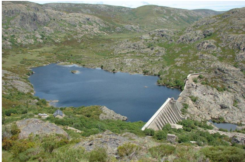
Figura 1. Restos de la presa de contrafuerte Vega de Tera
