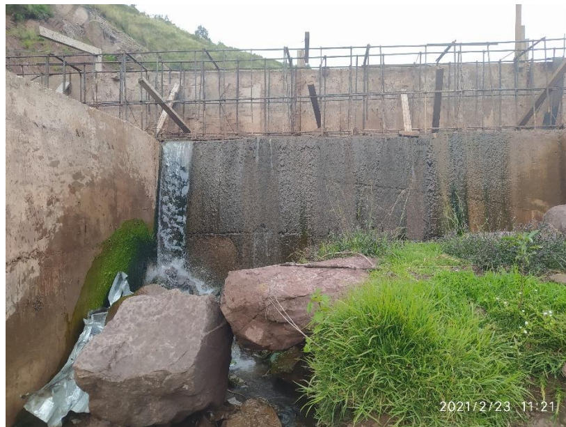
Figura 2. Desbordamiento del embalse entre contrafuertes de la represa Chuspiyoc
