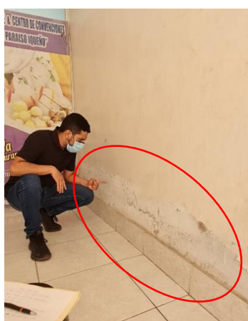
Figura 7. Identificación de eflorescencia en muros
