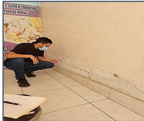
Foto 4: Pared con humedad
