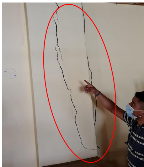
Figura 24. Identificación de patologías en columnas.
