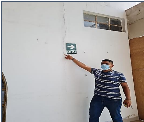
Foto 3: Pared con fisuramiento
