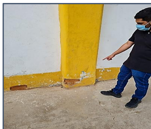
Foto 6: Pared presentando desprendimiento
