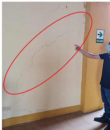
Figura 25. Identificación de patologías en muros.
