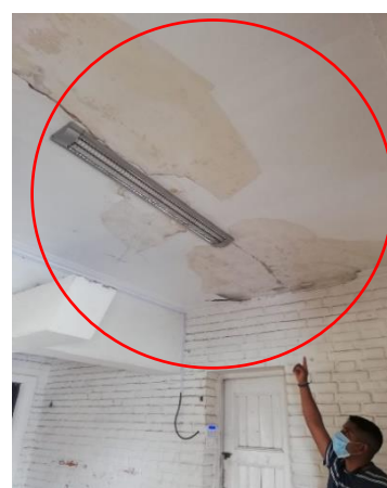
Figura 8. Identificación de humedad en losas.
