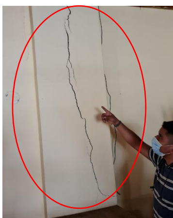
Figura 6. Identificación de grietas en columnas.
