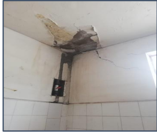
Foto 2: Losa con problema patológico.
