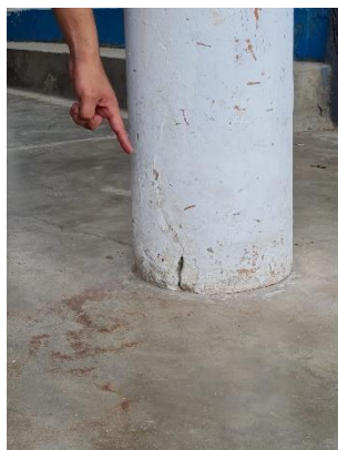
Foto 5: Base de columna con grietas
