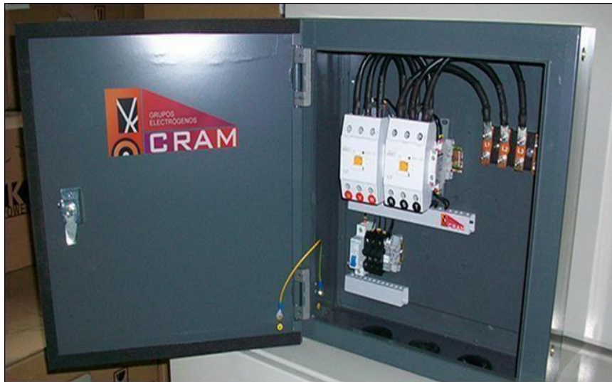
FIGURA 8: TABLERO DE TRANSFERENCIA DE POTENCIA
