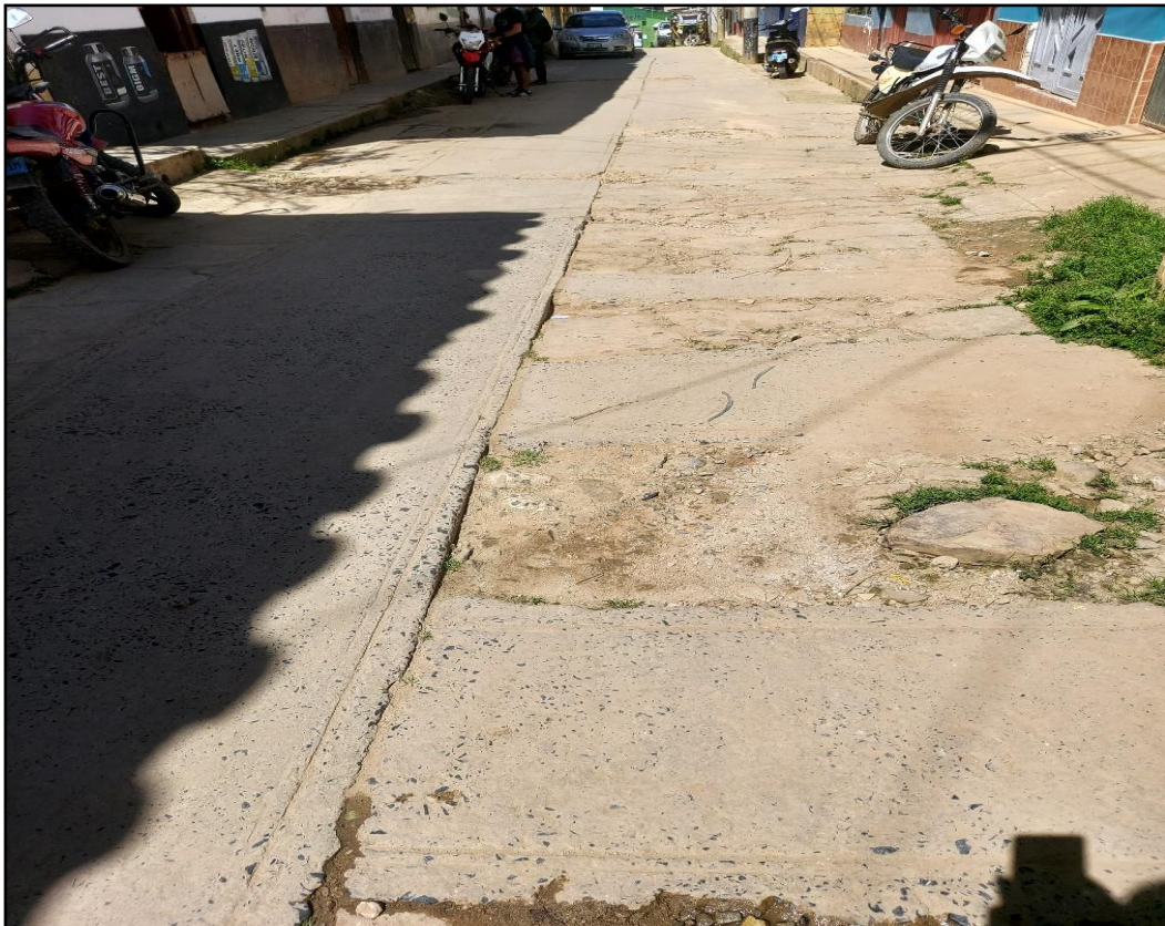
FOTOGRAFÍA 40: DESCONCHAMIENTO, PARCHEO (GRANDE)
