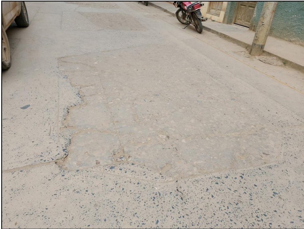
FOTOGRAFÍA 05: FALLA DE DESCONCHAMIENTO EN PAVIMENTO
