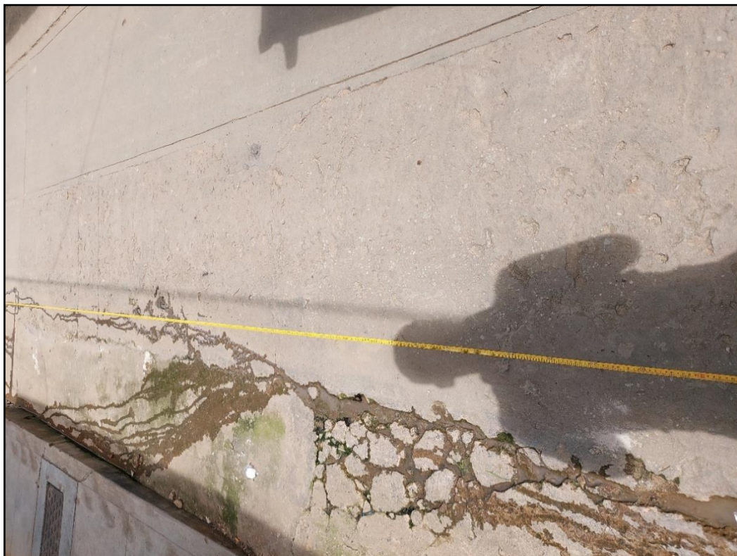
FOTOGRAFÍA 26: GRIETA DE DURABILIDAD "D", GRIETA LINEAL
