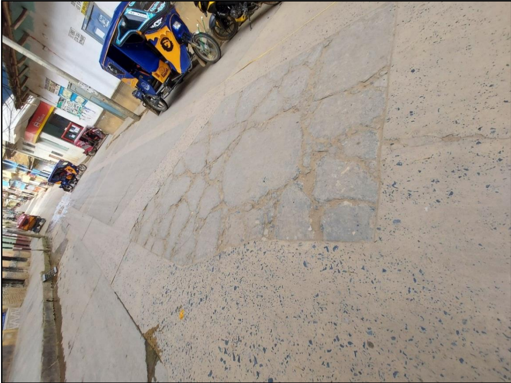
FOTOGRAFÍA 03: FALLA DE PARCHEO GRANDE EN PAVIMENTO
