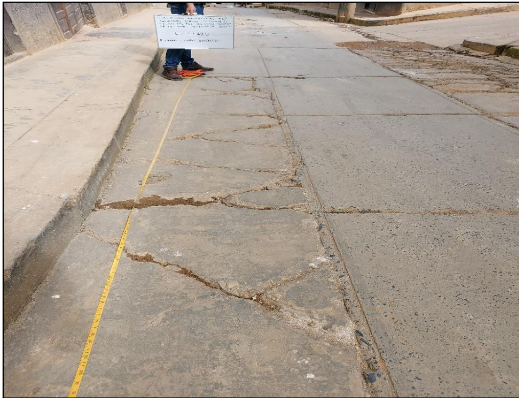
FOTOGRAFÍA 13: LOSA DIVIDIDA Y GRIETA DE DURABILIDAD "D"
