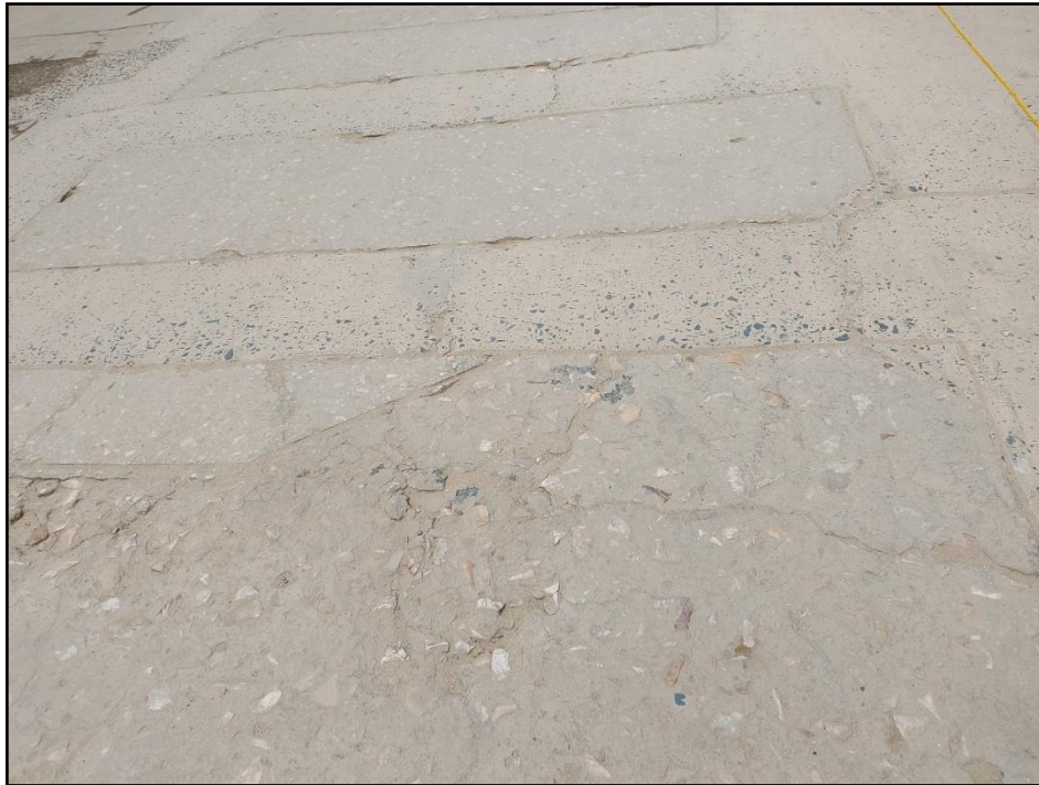
FOTOGRAFÍA 07: PARCHEO GRANDE, POPOUTS Y GRIETA LINEAL
