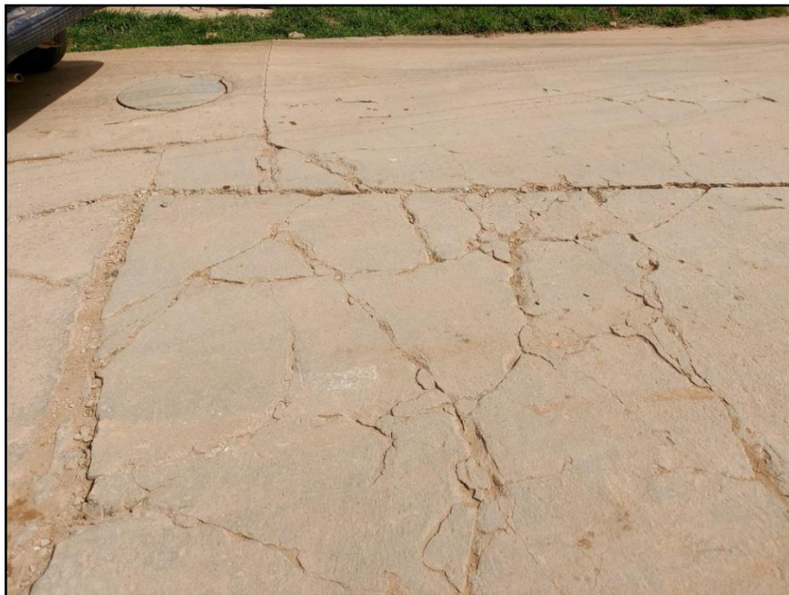
FOTOGRAFÍA 19: SELLO DE JUNTA, LOSA DIVIDIDA Y GRIETA DE DURABILIDAD "D"
