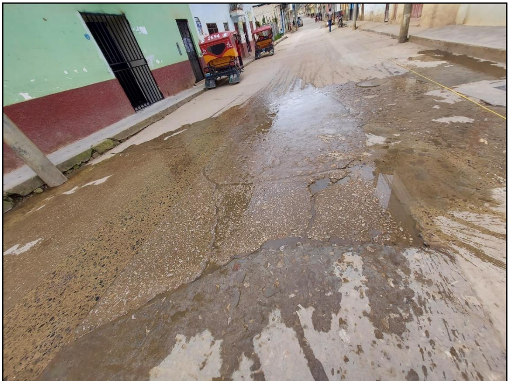
FOTOGRAFÍA 04: FALLA DE GRIETA LINEAL EN PAVIMENTO
