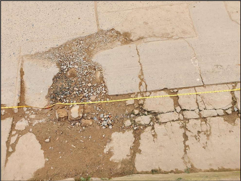
FOTOGRAFÍA 22: LOSA DIVIDIDA Y GRIETA DE DURABILIDAD "D", DESCONCHAMIENTO, PULIMENTO DE AGREGADOS
