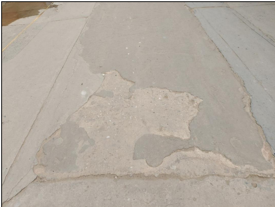
FOTOGRAFÍA 32: PULIMENTO DE AGREGADOS, DESCONCHAMIENTO, GRIETA LINEAL, LOSA DIVIDIDA.
