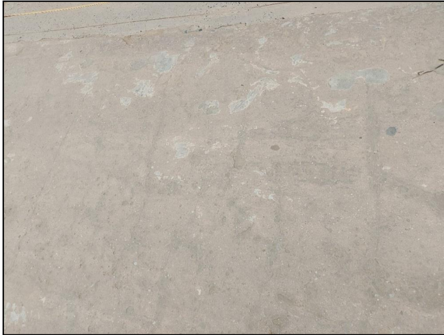
FOTOGRAFÍA 31: PULIMENTO AGREGADOS, GRIETA DE DURABILIDAD "D"
