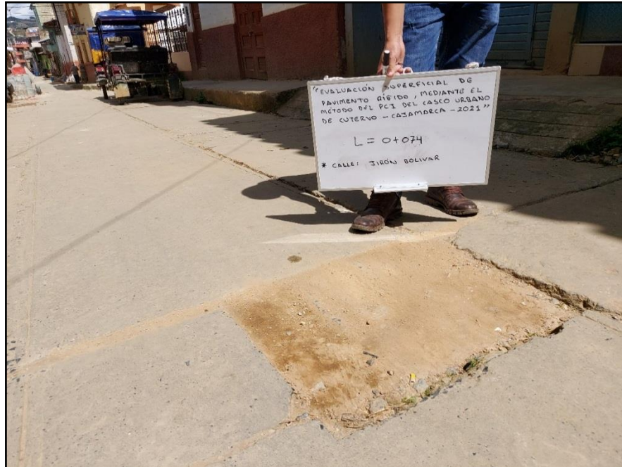
FOTOGRAFÍA 25: DESCONCHAMIENTO, PULIMENTO DE AGREGADOS
