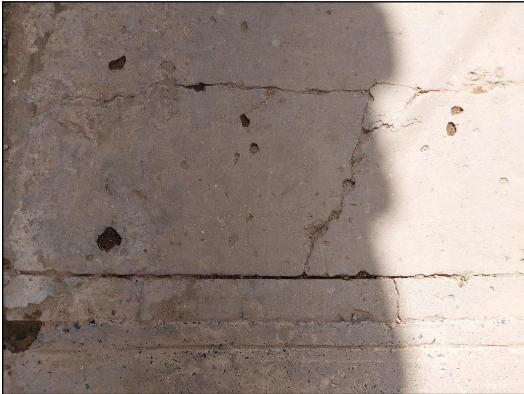
FOTOGRAFÍA 27: DESNIVEL CARRIL/BERMA, GRIETA DE DURABILIDAD "D"
