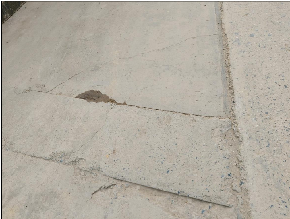
FOTOGRAFÍA 45: PULIMENTO DE AGREGADOS, GRIETA LINEAL SELLO DE JUNTA, LOSA DIVIDIDA, GRIETA EN ESQUINA
