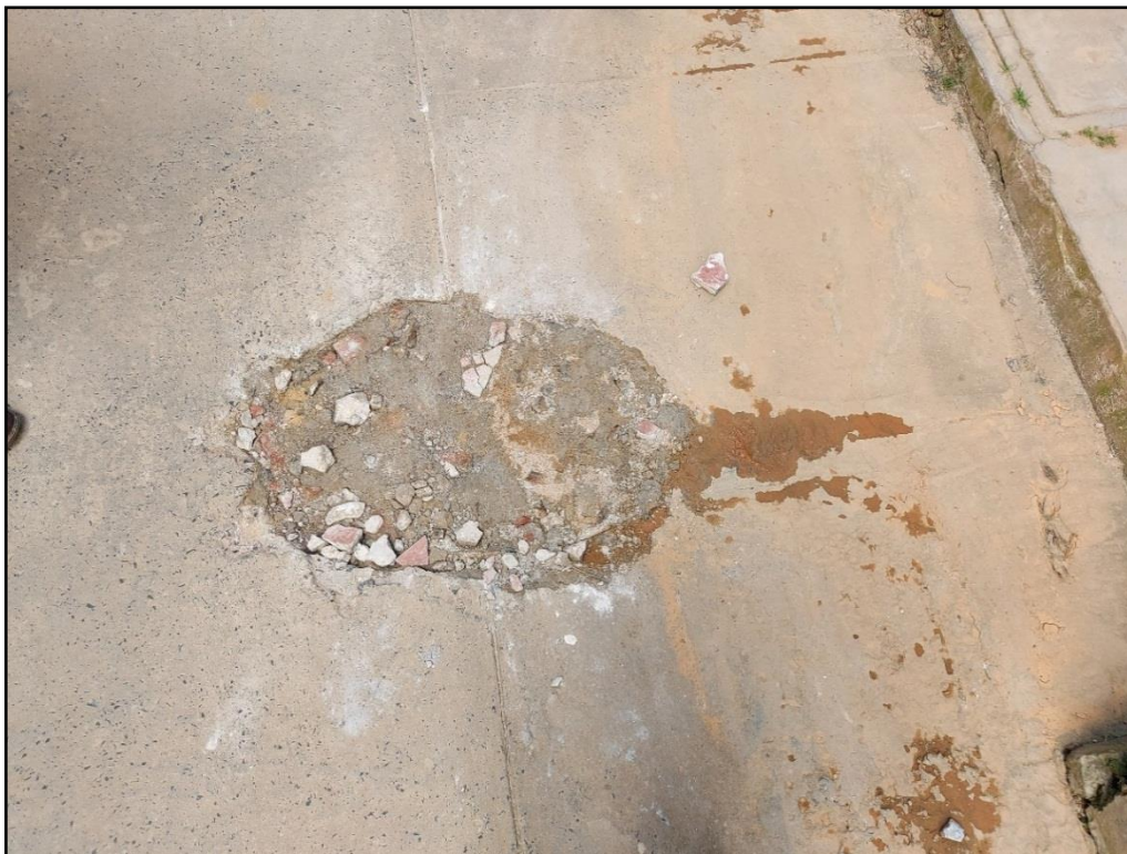
FOTOGRAFÍA 38: DESCONCHAMIENTO, GRIETA LINEAL
