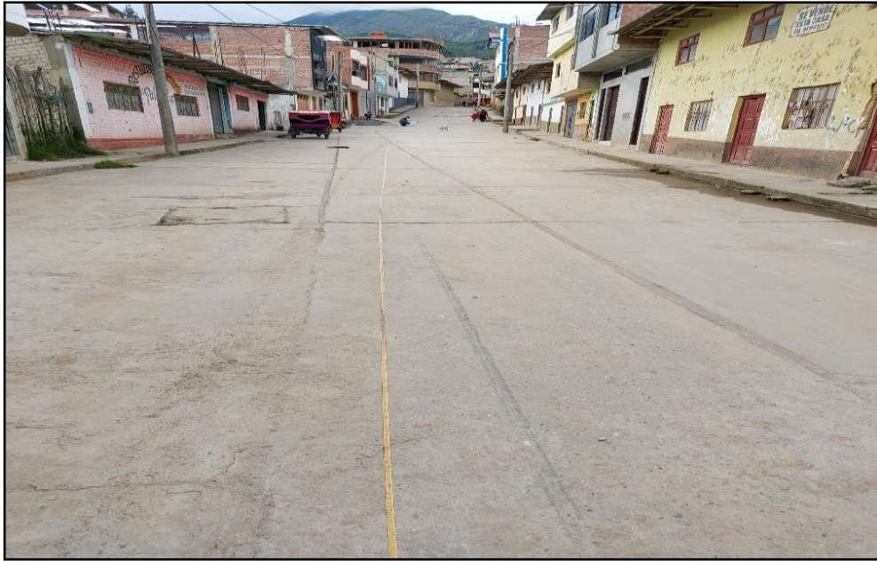
FOTOGRAFÍA 43: PULIMENTO DE AGREGADOS, GRIETA LINEAL SELLO DE JUNTA
