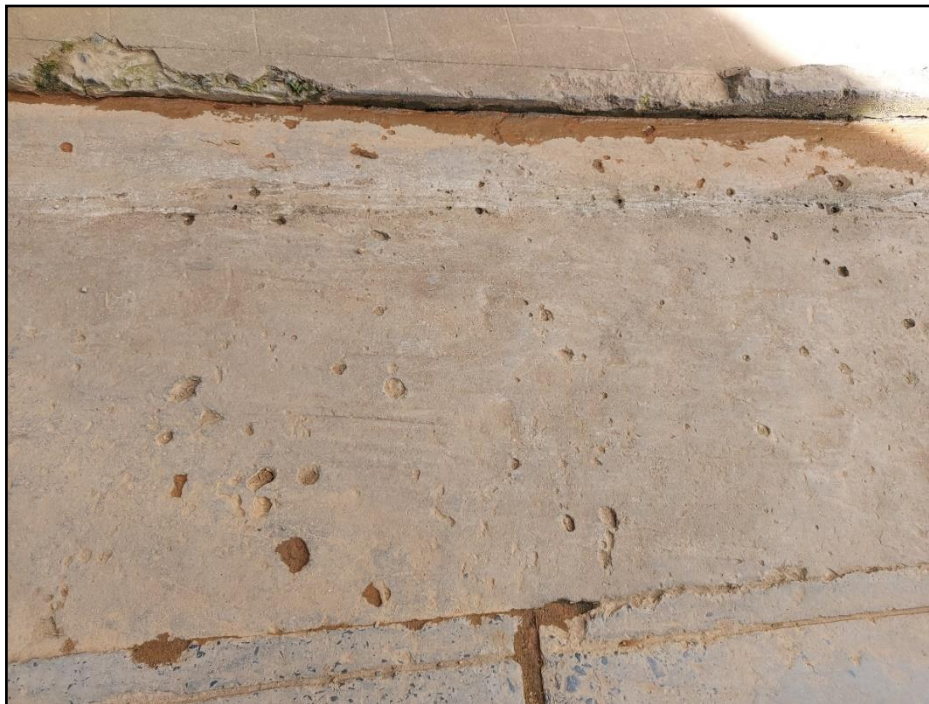
FOTOGRAFÍA 37: POPOUTS, GRIETA LINEAL
