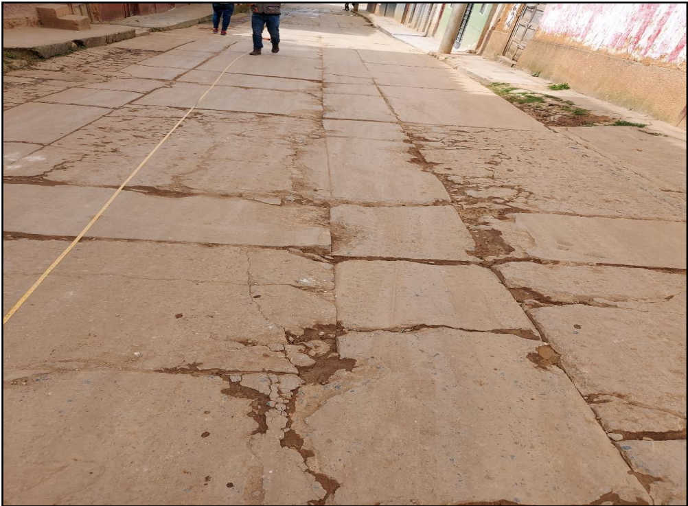
FOTOGRAFÍA 21: LOSA DIVIDIDA Y GRIETA DE DURABILIDAD "D", GRIETA EN ESQUINA
