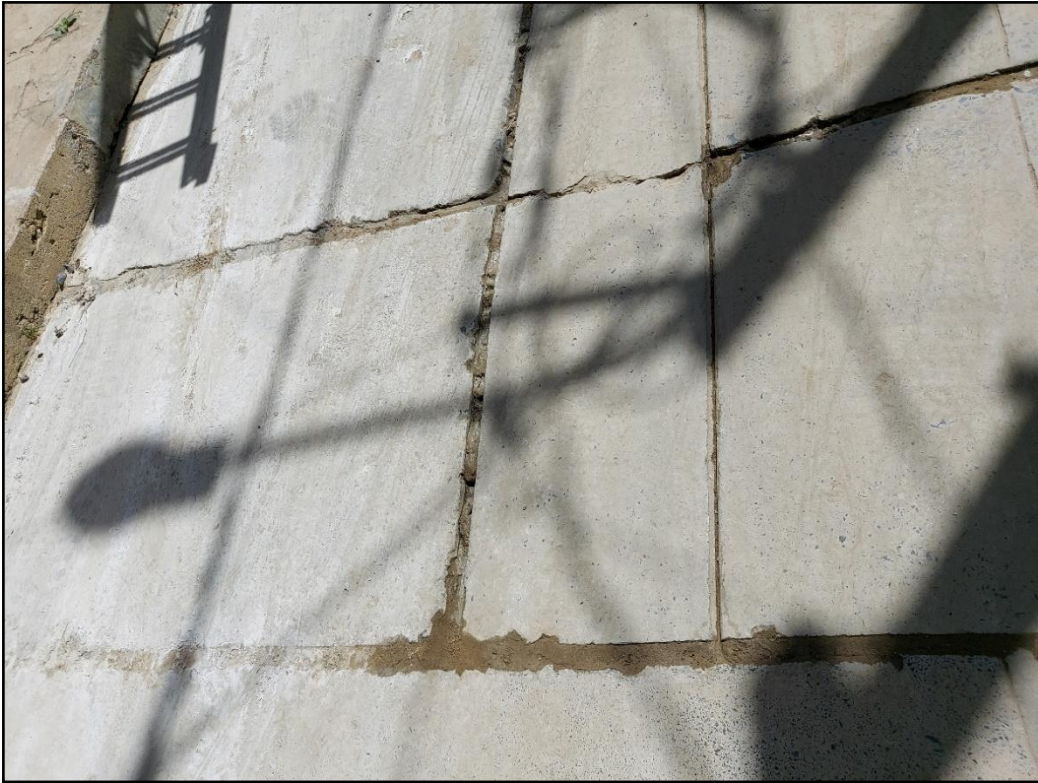
FOTOGRAFÍA 41: GRIETA LINEAL, PARCHEO (GRANDE)
