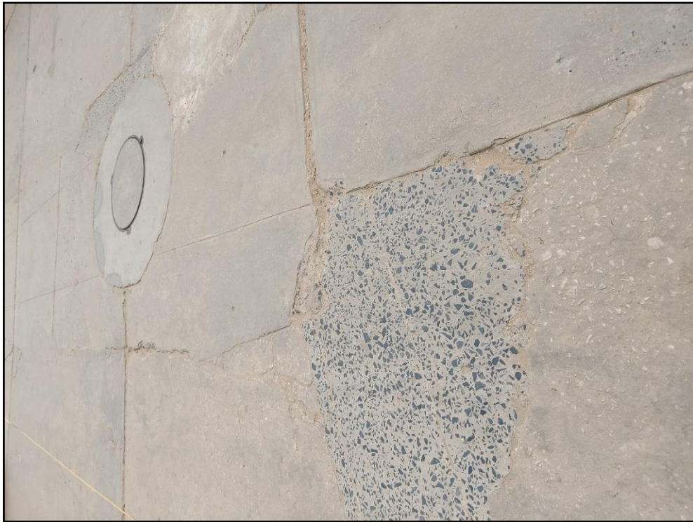
FOTOGRAFÍA 33: PULIMENTO DE AGREGADOS, DESCONCHAMIENTO, GRIETA LINEAL, GRIETA DE DURABILIDAD "D"
