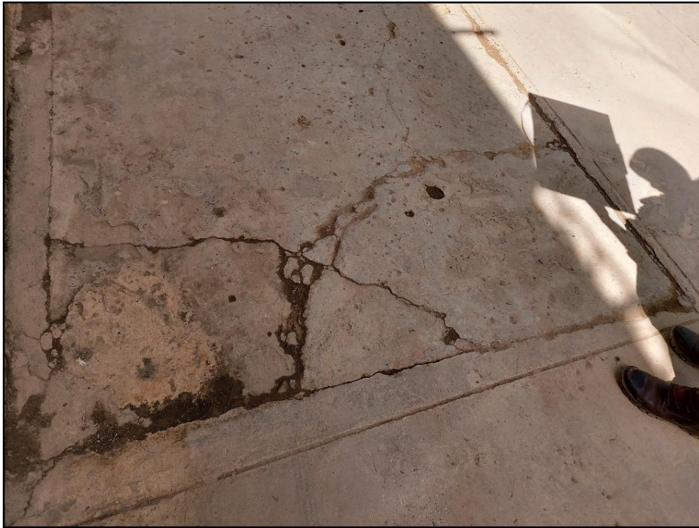
FOTOGRAFÍA 39: GRIETA LINEAL, DESCASCARAMIENTO DE ESQUINA
