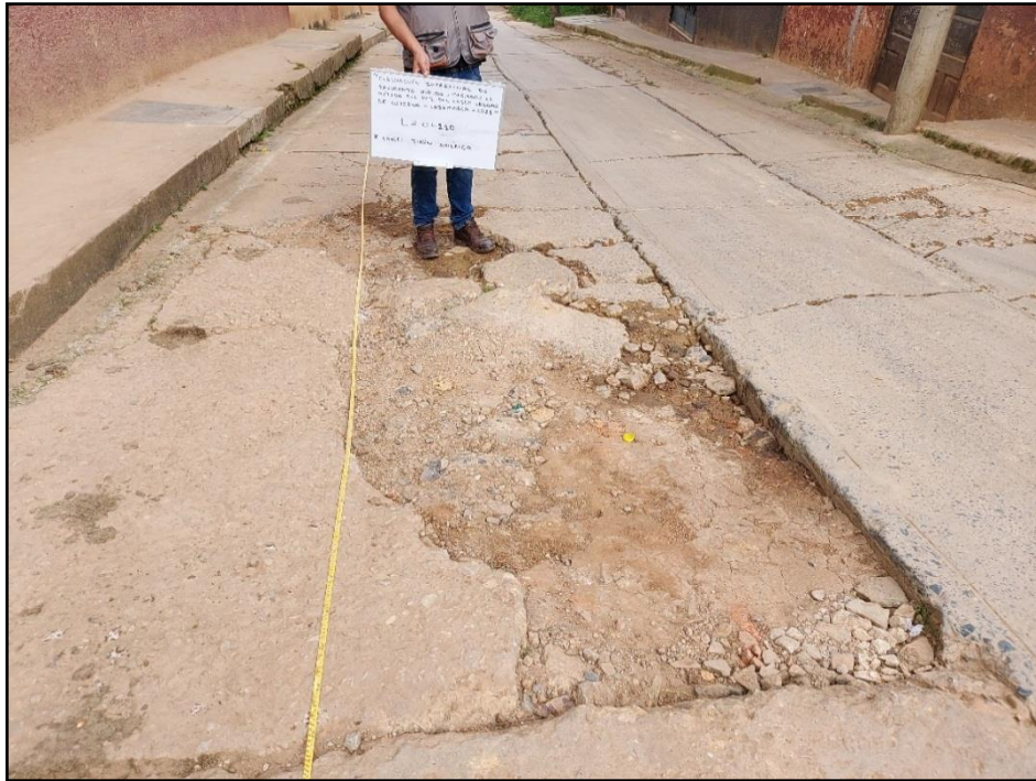
FOTOGRAFÍA 11: FALLA DE DESCONCHAMIENTO EN PAVIMENTO
