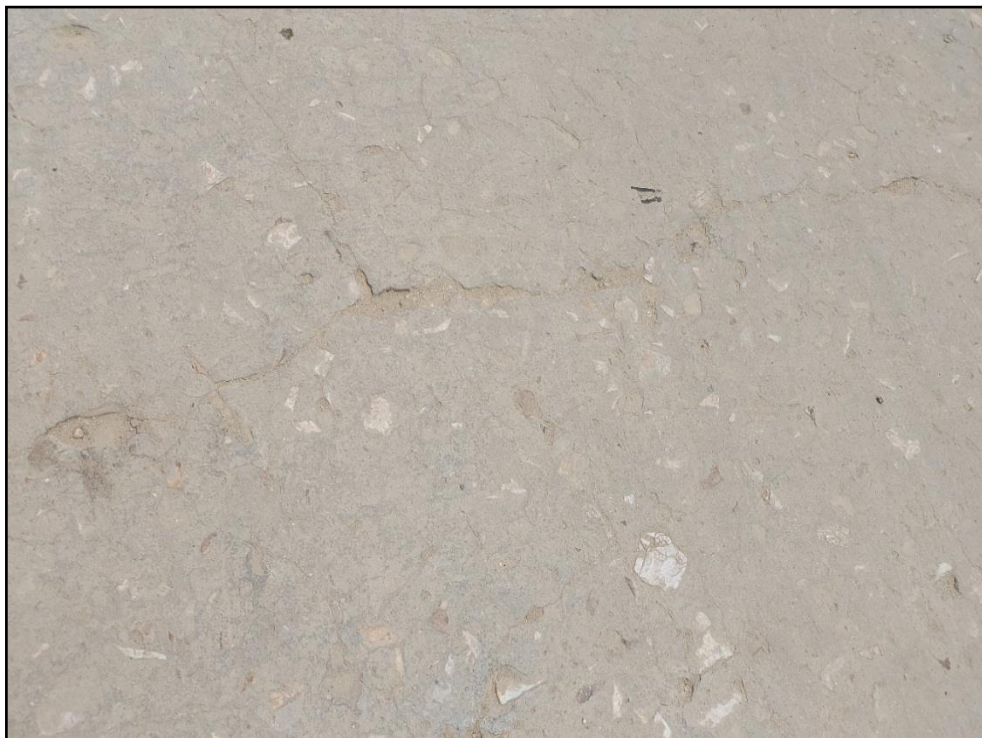
FOTOGRAFÍA 06: FALLA DE GRIETA LINEAL Y POPOUTS EN PAVIMENTO
