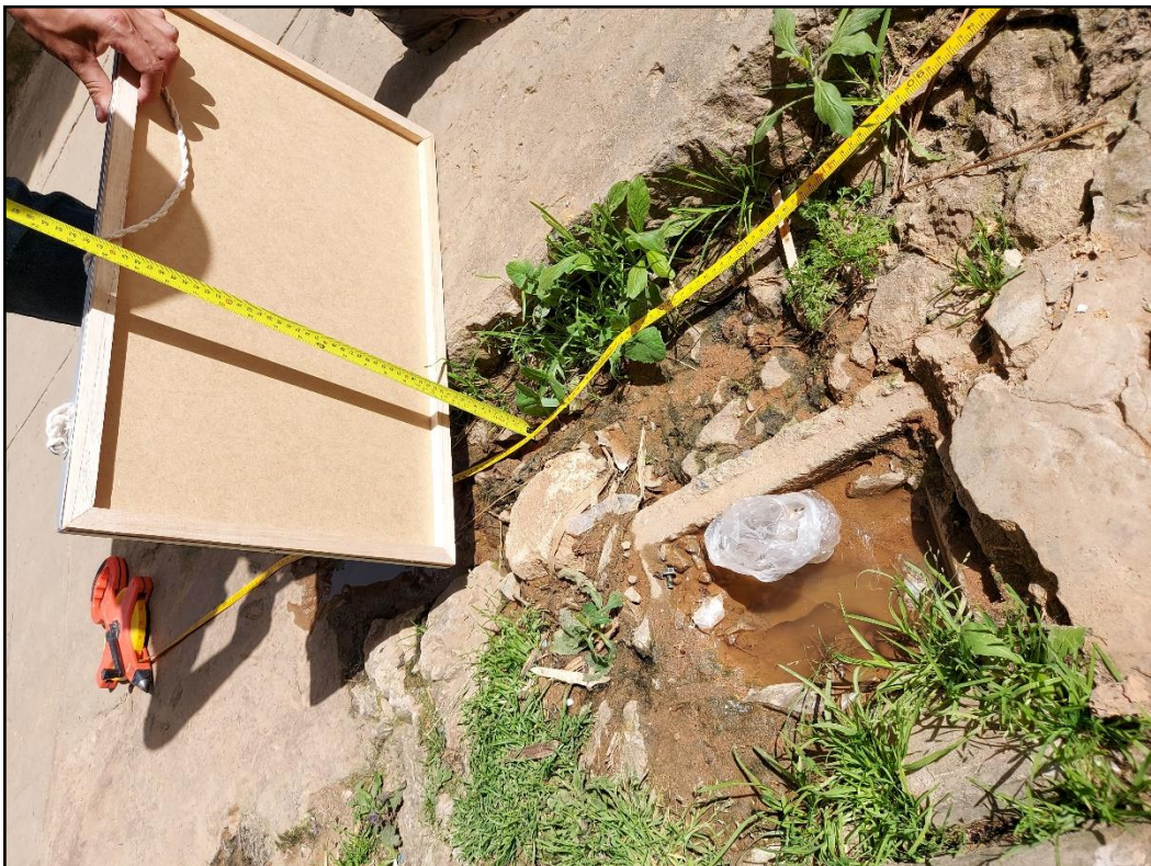
FOTOGRAFÍA 48: LOSA DIVIDIDA, DESCONCHAMIENTO, GRIETA EN ESQUINA
