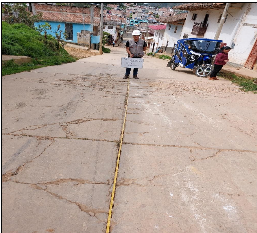
FOTOGRAFÍA 20: SELLO DE JUNTA, LOSA DIVIDIDA Y GRIETA DE DURABILIDAD "D", GRIETA EN ESQUINA
