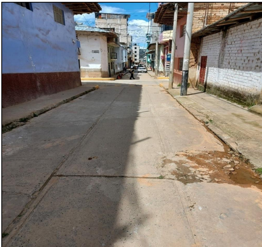
FOTOGRAFÍA 08: DESCONCHAMIENTO, DESCASCARAMIENTO DE ESQUINA, DESCASCARAMIENTO DE JUNTA
