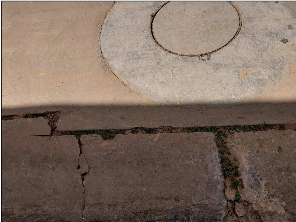
FOTOGRAFÍA 29: BOMBEO, GRIETA DE DURABILIDAD "D", GRIETA LINEAL
