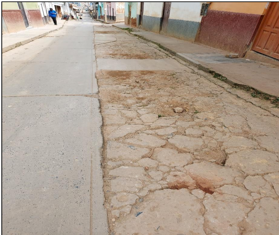
FOTOGRAFÍA 12: LOSA DIVIDIDA Y DESCONCHAMIENTO
