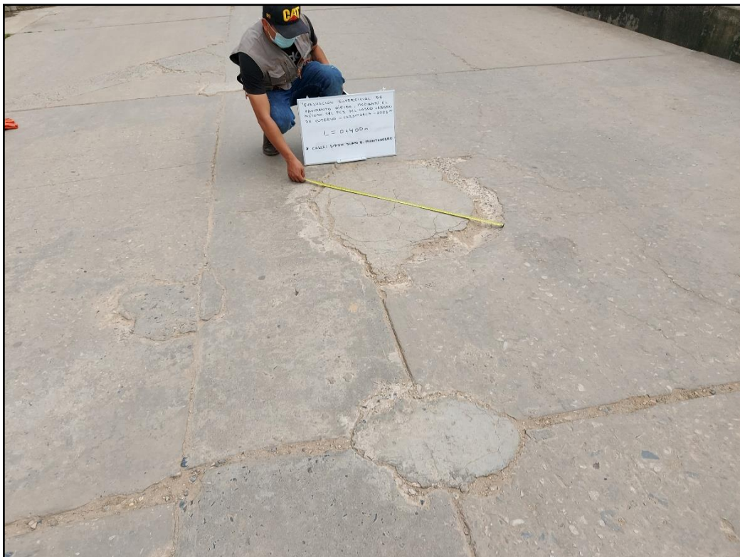
FOTOGRAFÍA 34: PULIMENTO DE AGREGADOS, DESCONCHAMIENTO.
