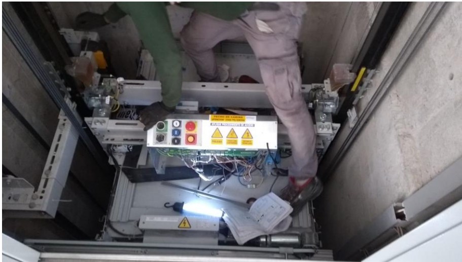
Figura 15. Instalación eléctrica en el techo de la cabina de manera desordenada
