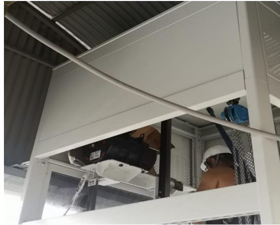
Figura 20. Personal trabajando sin indumentaria adecuada
