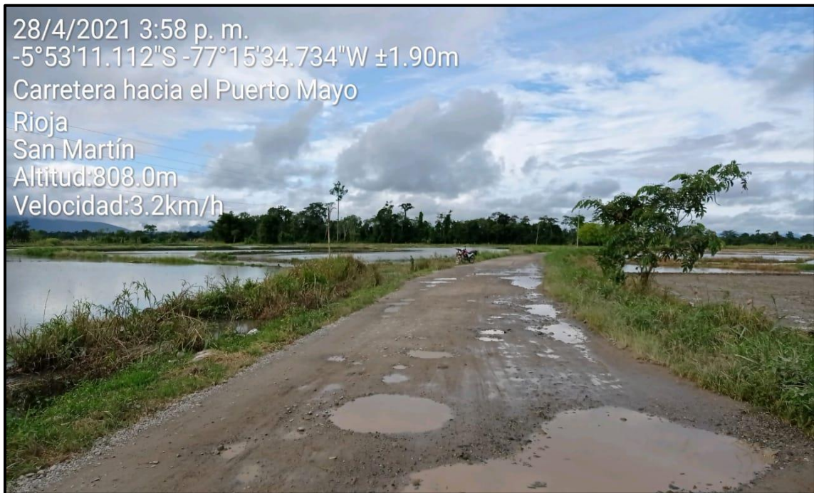
Figura 10: Estado situacional de la carretera ante la presencia de las lluvias.
