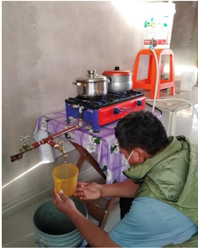
Punto de salida de agua caliente
