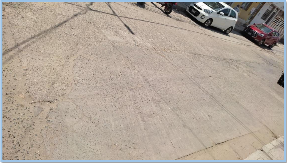
Figura 25: Agrietamiento en Bloque
