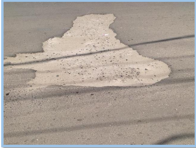
Figura 19: Desprendimiento de agregados
