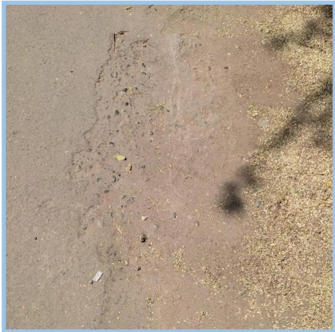
Figura 16: Desprendimiento de agregados
