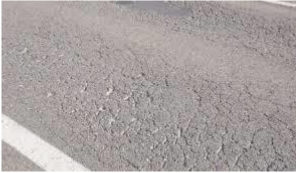
Figura 3: Patología por fatiga.
