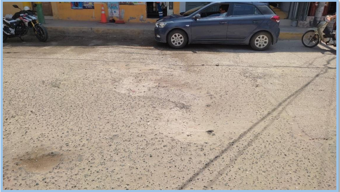
Figura 23: Desprendimiento de agregados
