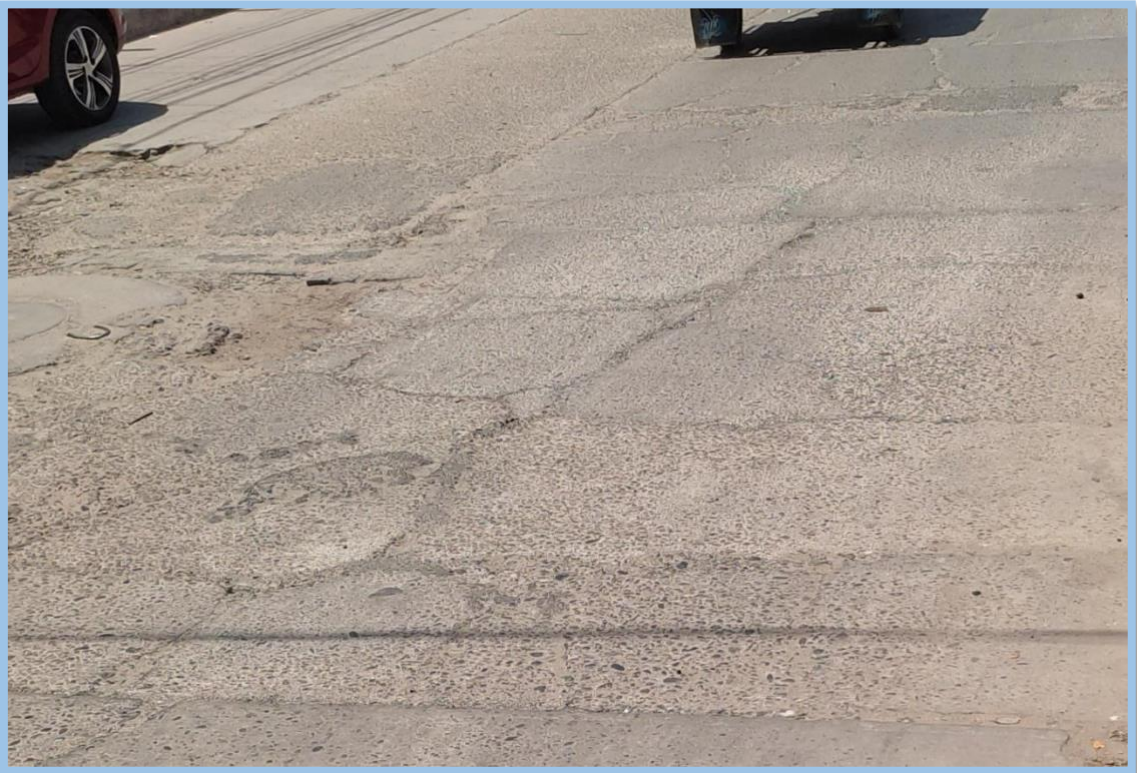
Figura 26: Agrietamiento en bloque.
