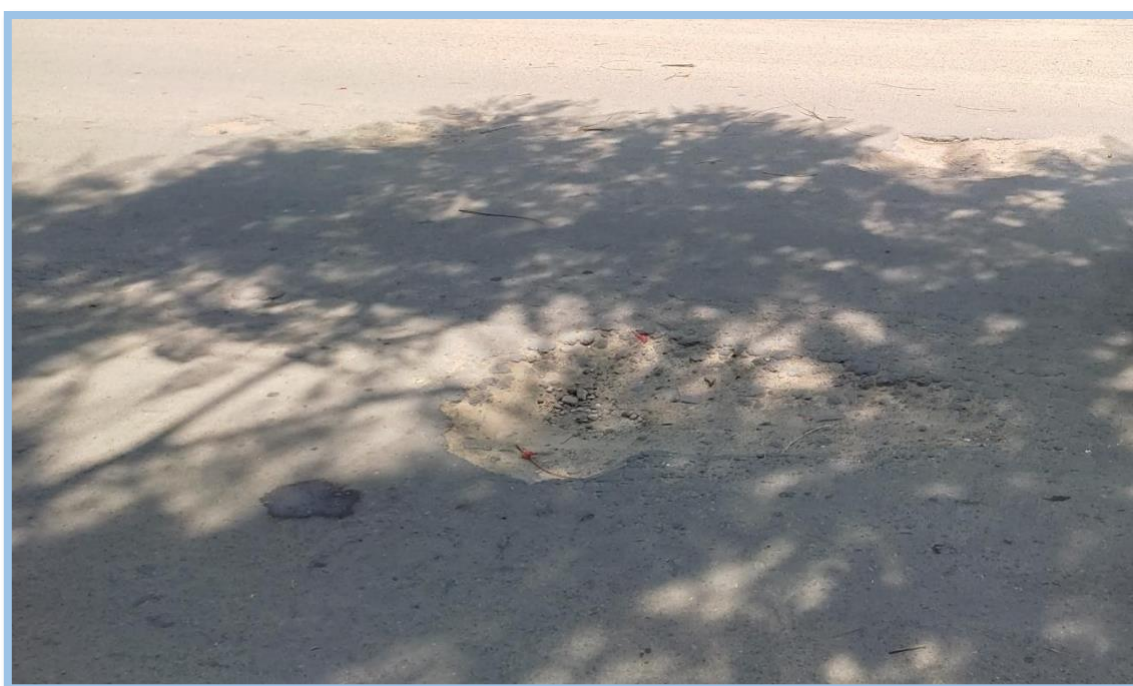
Figura 12: Desprendimiento de agregados.
