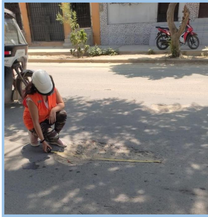
Figura 13: Desprendimientos de agregados
