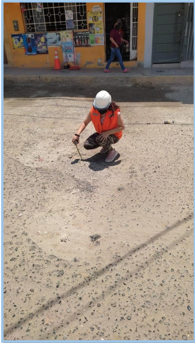
Figura 24: Desprendimiento de agregados
