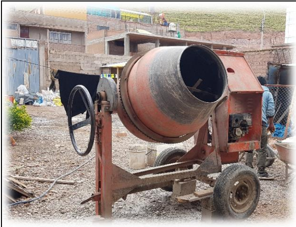
FECHA DE LA FOTOGRAFÍA 08 DE FEBR DEL 2022 Evidencia Fotográfica Nº 19 Mezcladora del laboratorio.
