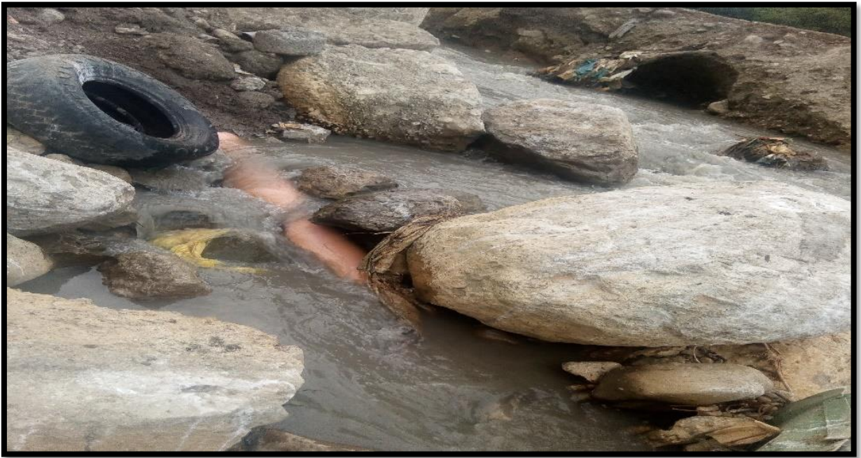
Figura 46 Tubería de desagüe del camal municipal de la Ciudad de Bambamarca al Río Llaucano.
