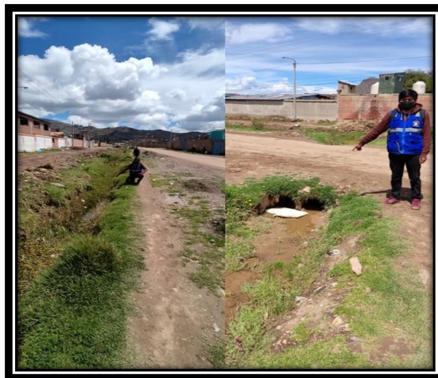
Figura 5 Vista de canales en mal estado Km. 1+300
