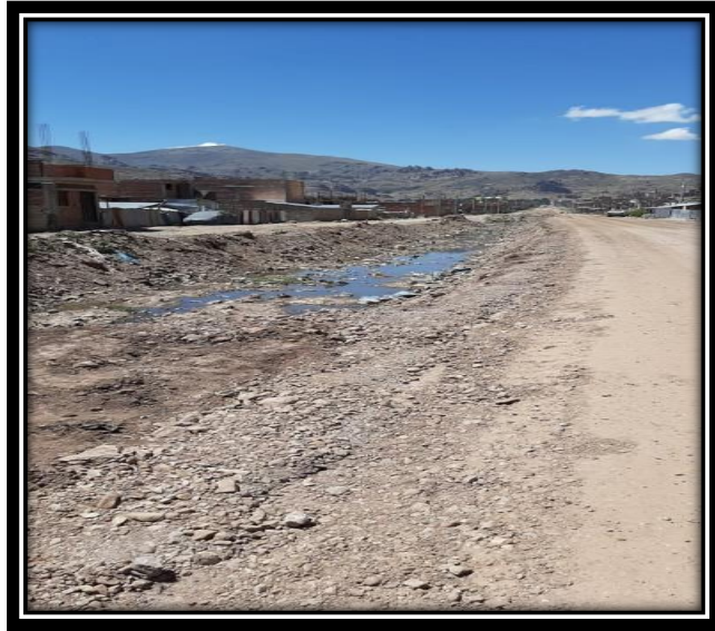
Figura 2 estado de la carretera Km. 0+200
