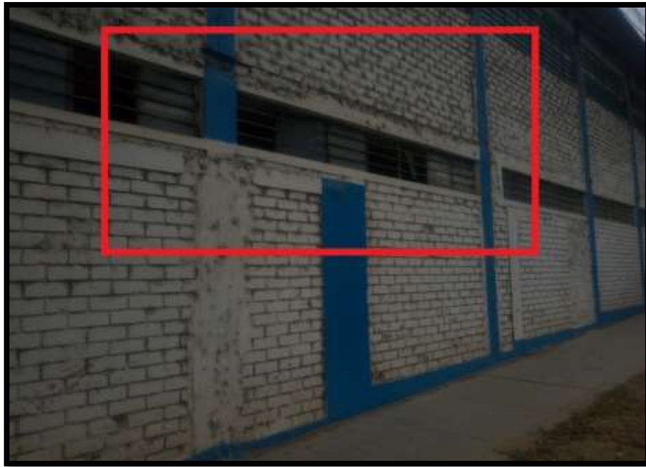
Imagen 7. No hay continuidad de elementos de concreto armado, se nota la presencia de suciedad, además hay aberturas en el muro que puede producir una falla por columna corta
