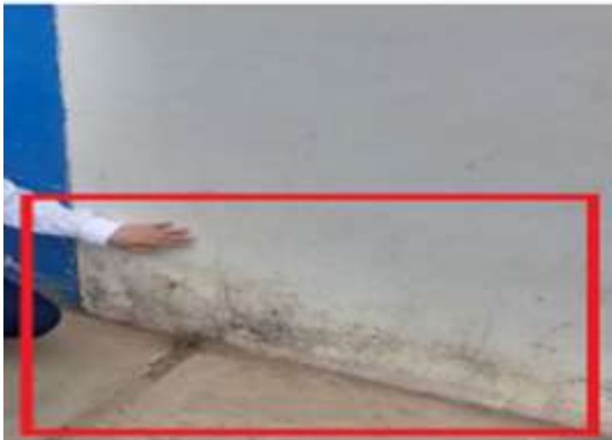
Imagen 20. Presencia de fisuras y erosión en la unidad muestral 1.
