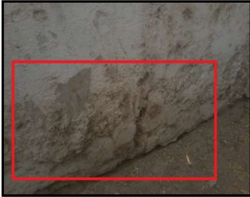
Imagen 13. Parte interior de la unidad 11 presenta desgaste y desprendimiento del tarrajeo y parte del concreto del sobrecimiento.
