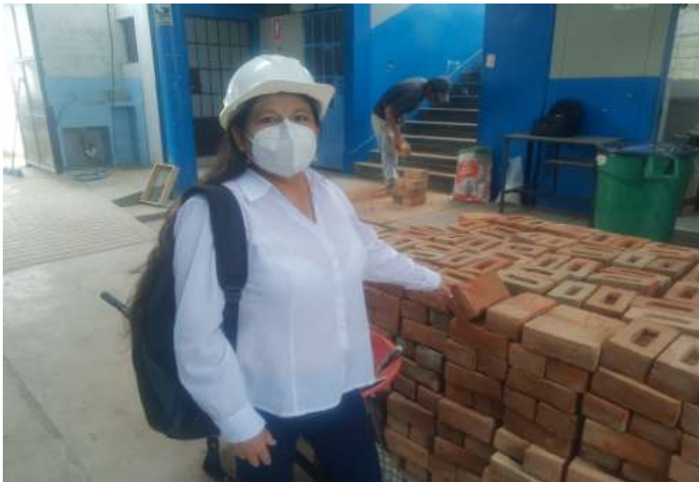
Imagen 16. Ladrillo artesanal de baja resistencia empleado en la ampliación del cerco perimétrico de la unidad muestral 8.
