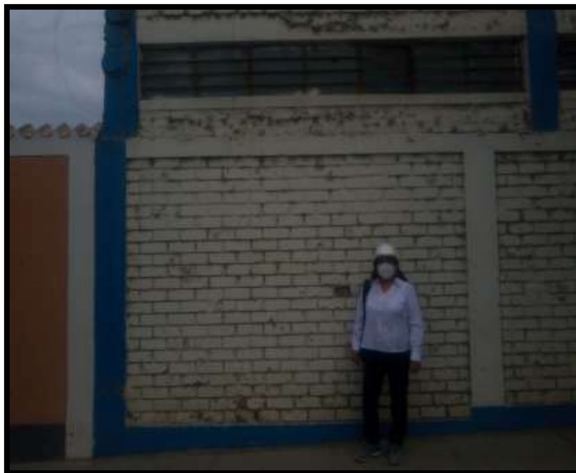
Imagen 8. Construcción deficiente, sin continuidad de elementos estructurales, sin supervisión y con suciedad materiales de distinta calidad y resistencia, posible colapso ante un sismo.
