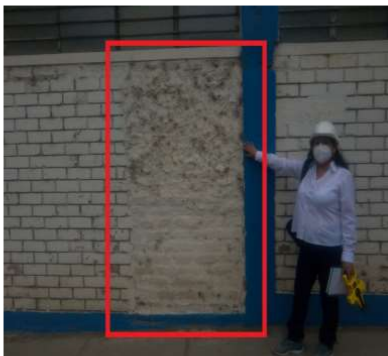
Imagen 12. Se observa la clausura de puerta realizada sin criterio y de mala manera, además de la ampliación del cerco hacia arriba en la unidad 11 del cerco perimétrico.
