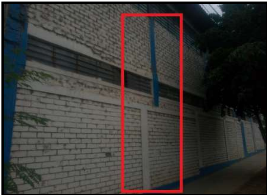
Imagen 4. También en la unidad de muestra número 12 se observa la discontinuidad de la columna en el segundo nivel lo que ocasiona una fuerza puntual sobre el muro de albañilería del primer nivel.
