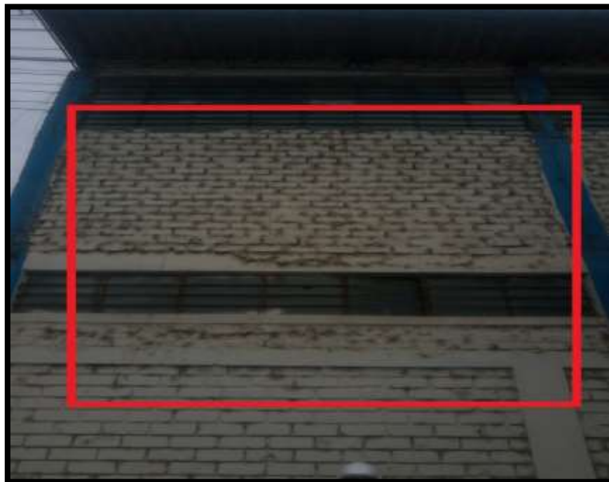
Imagen 6. En la unidad de muestra 12 se observa una ampliación del cerco perimétrico, muy deficiente que genera se acumule suciedad en toda su superficie y afecte las estructuras.
