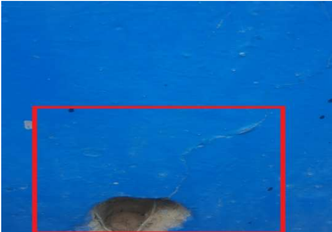
Imagen 19. Fisura en sobrecimiento en unidad muestral 2.
