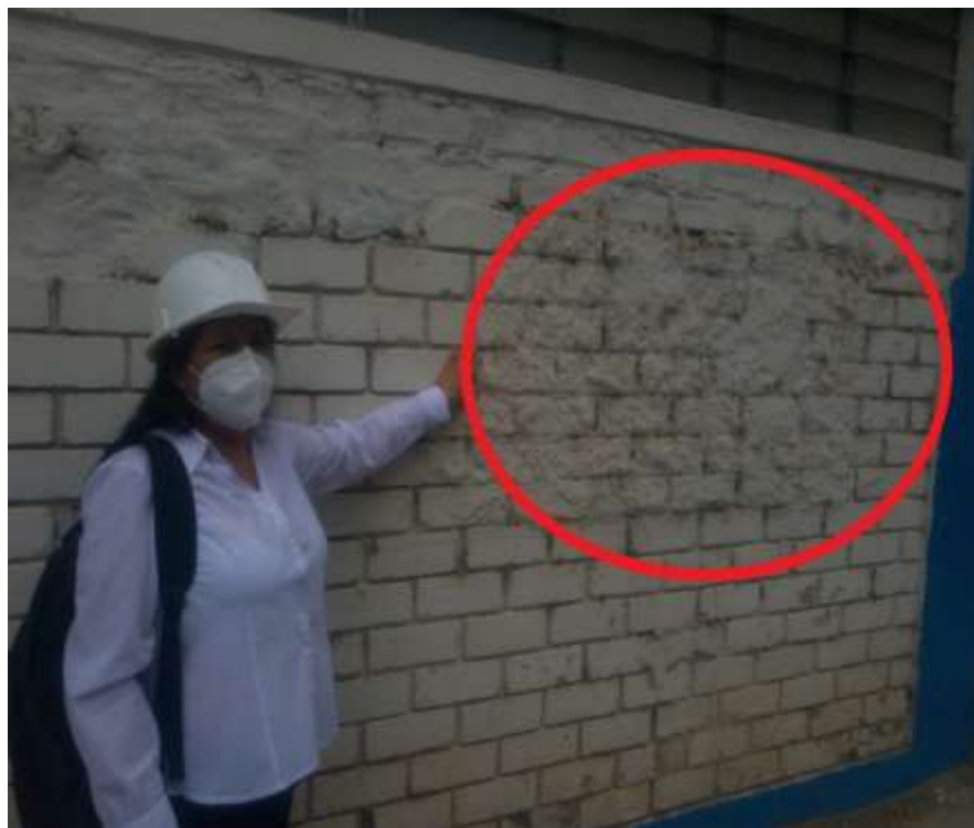
Imagen 11. Se observa la clausura de ventanas realizada sin criterio y de mala manera, además de la ampliación del cerco hacia arriba en la unidad 11 del cerco perimétrico.
