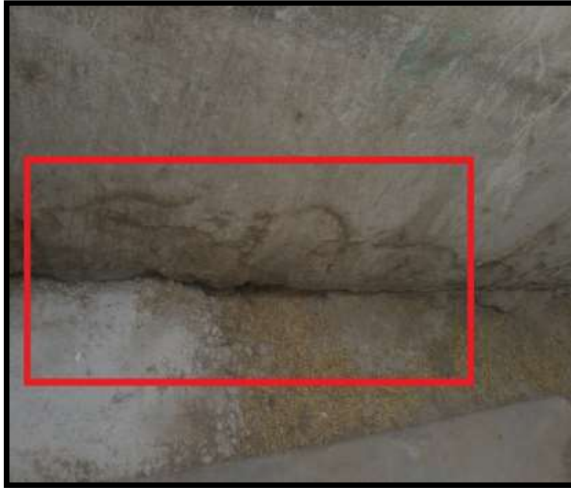
Imagen 9. Parte interior del cerco perimétrico de la unidad 12, con presencia de eflorescencia y desgaste del concreto
