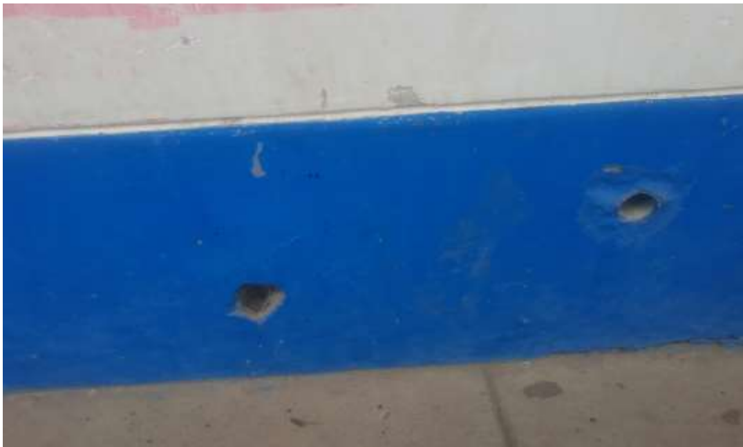
Imagen 18. Abertura en el sobrecimiento para drenaje que ocasionan fisuras en dicho elemento en unidad muestral 2.
