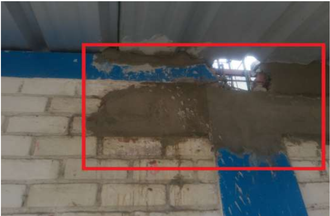
Imagen 14. Se nota la rotura y ampliación de columna sin respetar la ubicación ni la longitud de empalme del acero de refuerzo.
