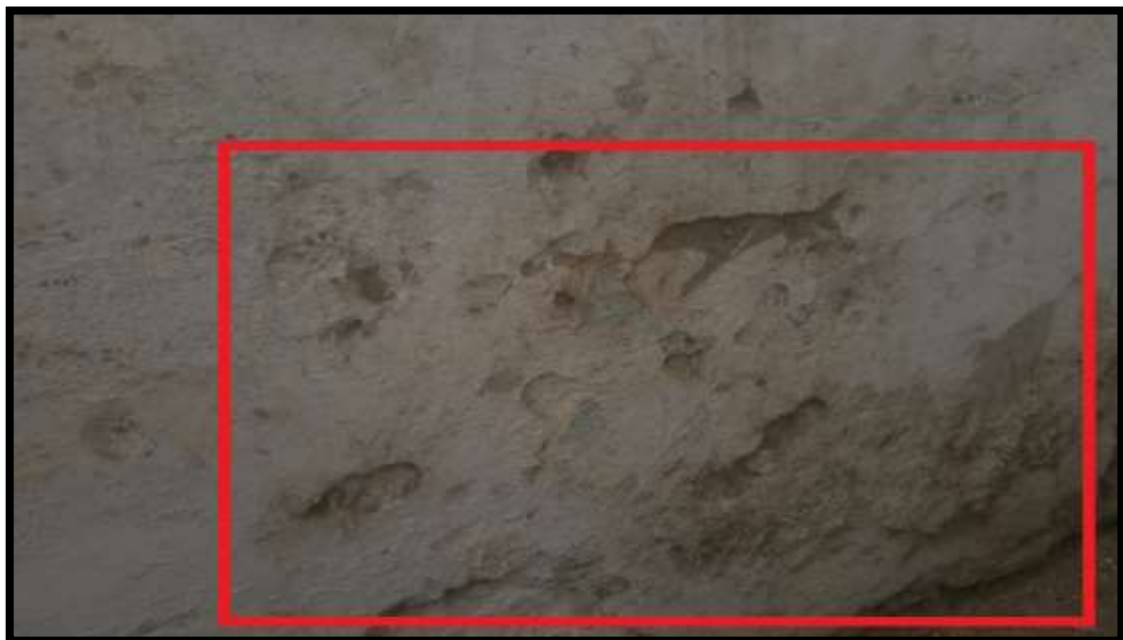
Imagen 10. Parte interior de la unidad 12 presenta desgaste del concreto en la parte del sobrecimiento
