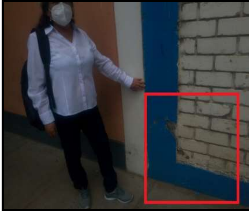
Imagen 5. En la unidad de muestra 12 se observa el desprendimiento del tarrajeo y parte del concreto de la columna.
