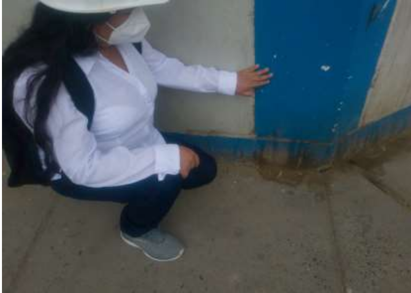
Imagen 17. Suciedad y deterioro en la pintura de la unidad muestral 4 ocasionado por el orín de perros callejeros.
