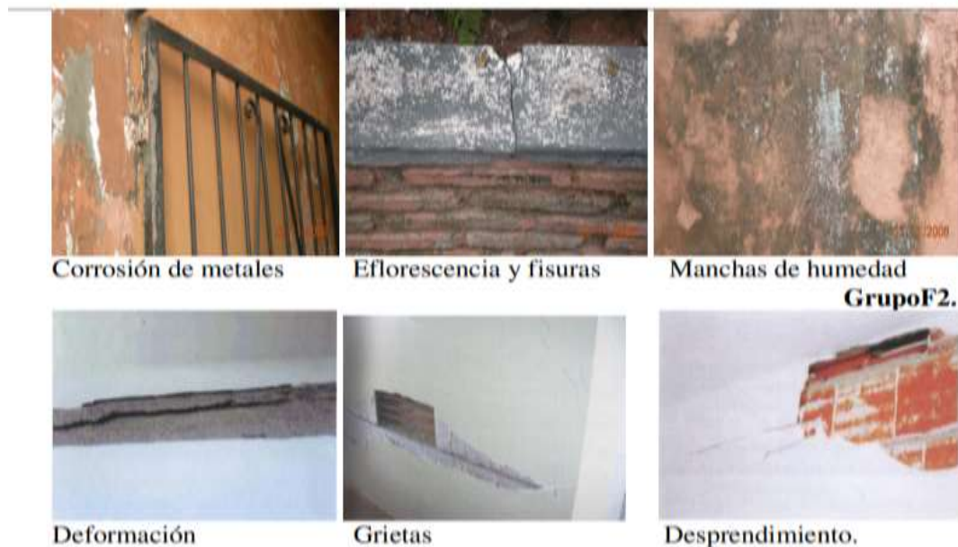
Figura N°06.- Patologías más comunes.
