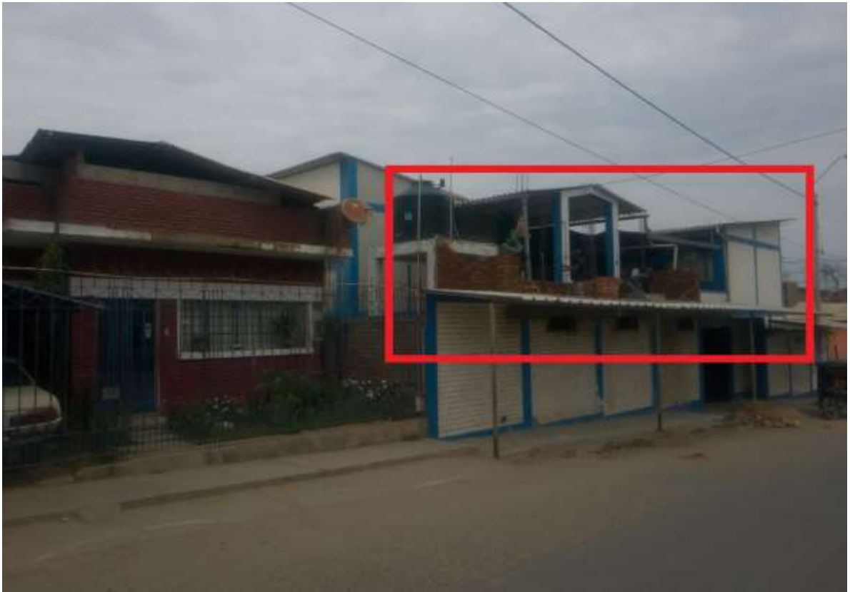
Imagen 15. Se está ampliando en altura, el cerco perimétrico en la unidad de muestra 8; sin supervisión y con materiales de baja calidad.
