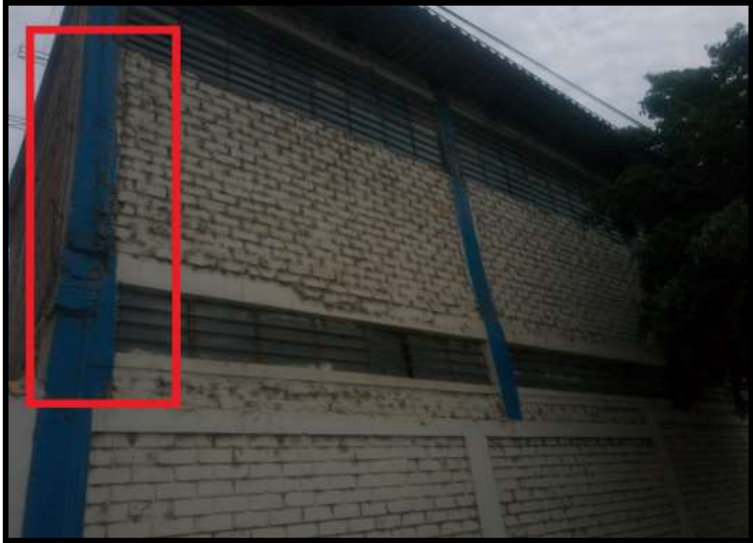
Imagen 3. Se verificó desplome y mala construcción de columna, además de la presencia de suciedad en toda la unidad de muestra "12", causando deterioro en las unidades de albañilería
