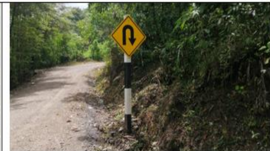
Fotografía 122: Prog. 05+310, señal preventiva en buen estado, ubicado en el lado derecho de la vía.
