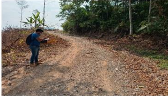
Fotografía 104: Tamo prog. 04+515 al 05+550, superficie de rodadura que presenta daños de deformación y erosión de nivel de gravedad 1; con un ancho de vía de 4.20 m.
