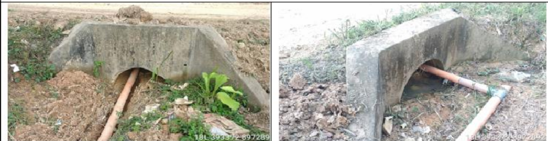
Fotografía 11 Y 12: Prog. 00+585, alcantarilla definitiva TMC de 36 pulg. en excelente condición estructural y en regular estado de condición funcional (parcialmente obstruida), por lo que es necesario hacer el mantenimiento de limpieza; con un ancho de vía es de 5.90 m. observando una instalación de tubería dentro de la alcantarilla, se recomienda realizar una inspección juntamente con las autoridades y tomar las medidas adecuadas.
