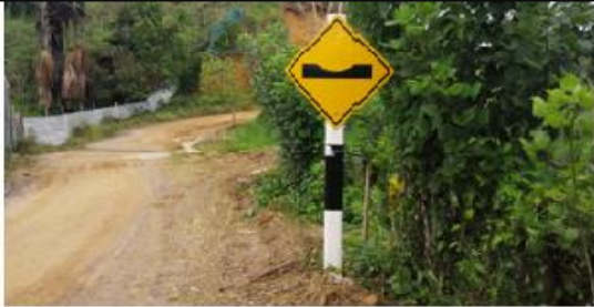
Fotografía 19: Prog. 0+952, señal preventiva en buen estado, ubicado en el lado izquierdo de la vía
