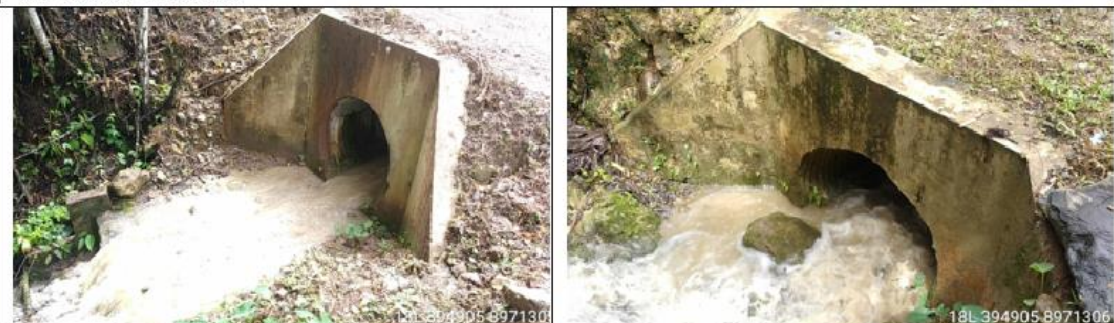
Fotografía 94 y 95: Prog. 04+291, alcantarilla definitiva TMC de 48 pulg. en excelente condición estructural y estado de condición funcional bueno (limpio); con un ancho de vía es de 5.90 m.
