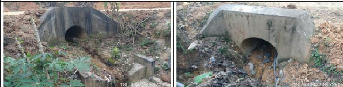
Fotografía 13 Y 14: Prog. 00+689, alcantarilla definitiva TMC de 36 pulg. en excelente condición estructural y en regular estado de condición funcional (parcialmente obstruida), por lo que es necesario hacer el mantenimiento; con un ancho de vía es de 5.00 m.
