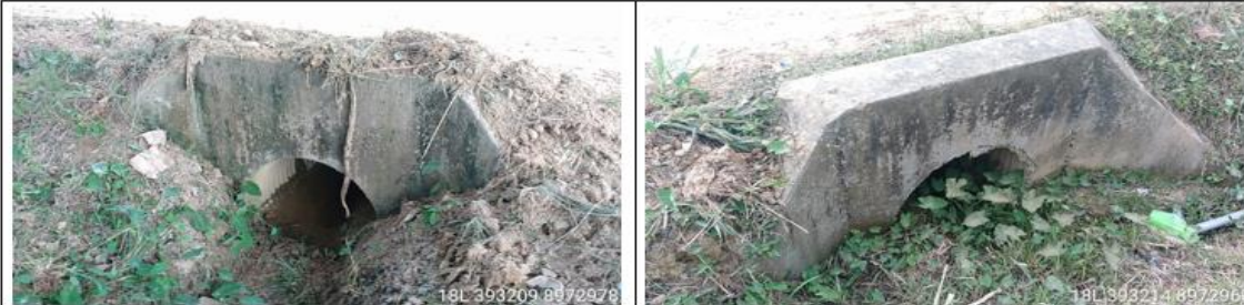
fotografía 08 Y 09: Prog. 00+387, alcantarilla definitiva TMC de 36 pulg. en excelente condición estructural y en regular estado de condición funcional (parcialmente obstruida), por lo que es necesario hacer el mantenimiento de limpieza; con un ancho de vía es de 5.00 m.
