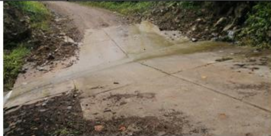
Fotografía 114: Prog. 05+082, badén de concreto en excelente condición estructural y estado de condición funcional bueno (limpio); con un ancho de 4.50 m y 12.00 m de largo.
