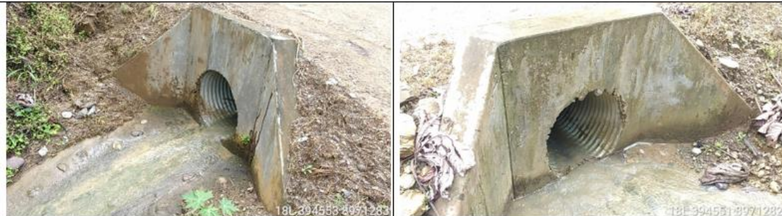
Fotografía 78 y 79: Prog. 03+902, alcantarilla definitiva TMC de 36 pulg. en excelente condición estructural y estado de condición funcional bueno (limpio); con un ancho de vía es de 5.15 m.
