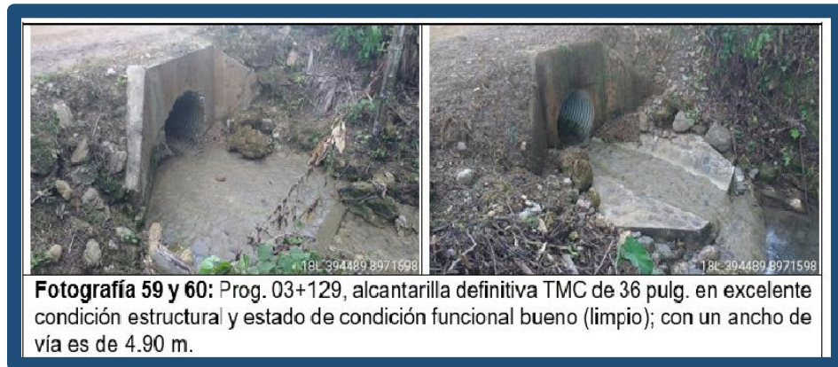
figura 9. Parte de la evaluación del estado actual de las obras de drenaje
