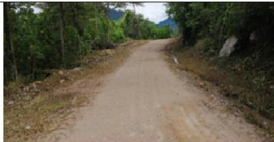
Fotografía 143: Prog. 06+320, superficie de rodadura en buen estado, con un ancho de vía de 3.85 m.
