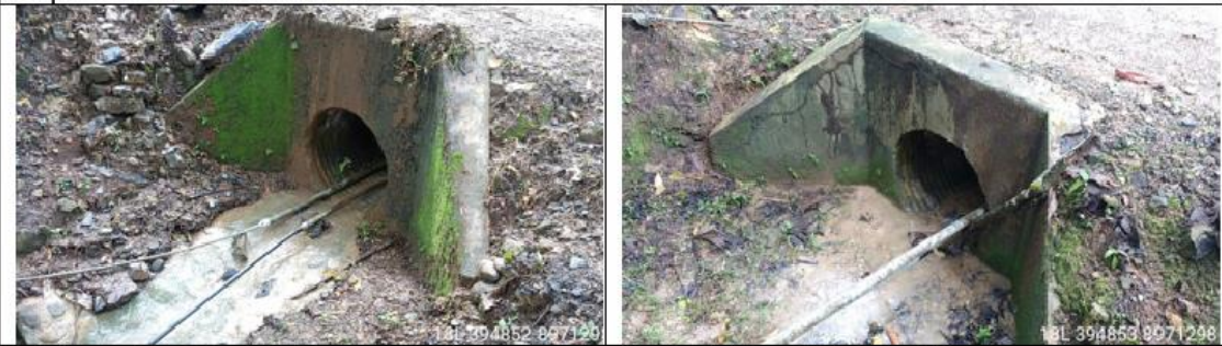
Fotografía 92 y 93: Prog. 04+234, alcantarilla definitiva TMC de 36 pulg. en excelente condición estructural y estado de condición funcional bueno (limpio); con un ancho de vía es de 5.20 m.
