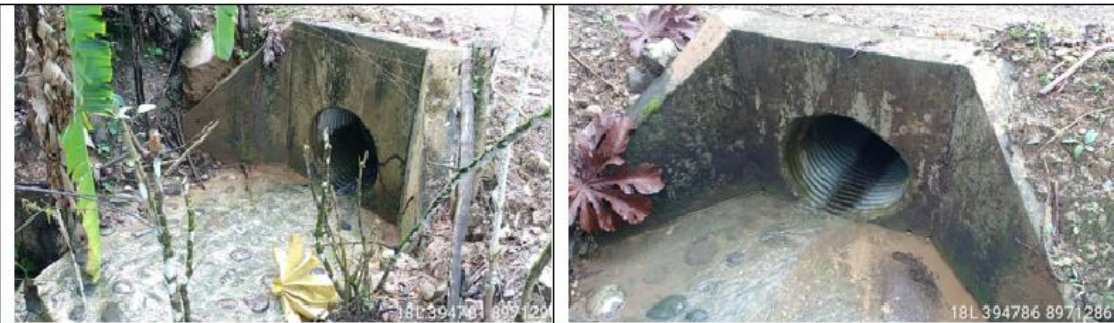
Fotografía 89 y 90: Prog. 04+170, alcantarilla definitiva TMC de 36 pulg. en excelente condición estructural y estado de condición funcional bueno (limpio); con un ancho de vía es de 6.80 m.
