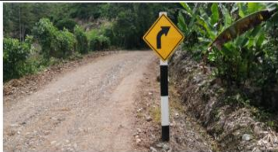
Fotografía 55: Prog. 02+984, señal preventiva en buen estado, ubicado en el lado derecho de la vía.
