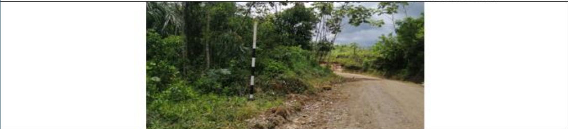
Fotografía 28: Prog. 1+736, señal preventiva en mal estado, ubicado a lado izquierdo de la vía.
