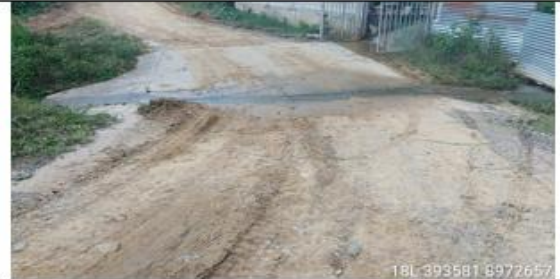
Fotografía 18: Prog. 00+930, badén de concreto en excelente condición estructural y en regular condición funcional (parcialmente obstruida), por lo que es necesario hacer el mantenimiento; con un ancho de vía es de 4.00 m.
