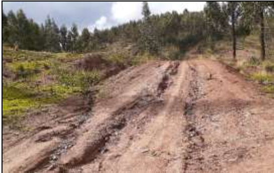
Fotografía 09. Estado actual de la carretera CU-1110.
