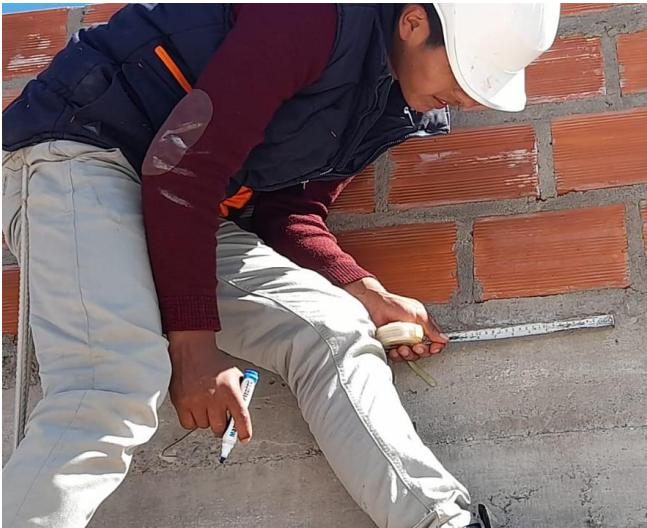
Delimitación del área y determinación de puntos para el ensayo de esclerómetro (vigas).
