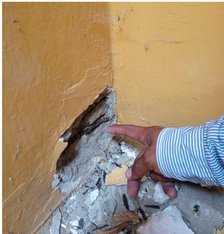
Figura 21. Corrosión del acero en columnas.
