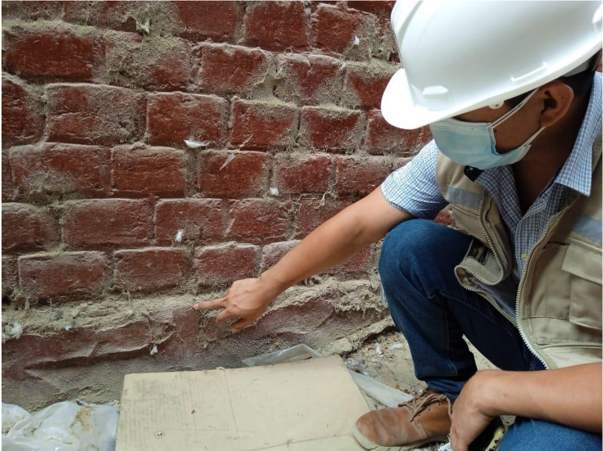
Figura 22. suciedad y fisuras en muros y sobrecimiento.
