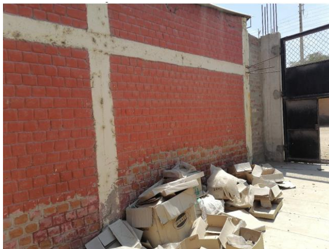
Figura 11.Presencia de humedad con eflorescencia.
