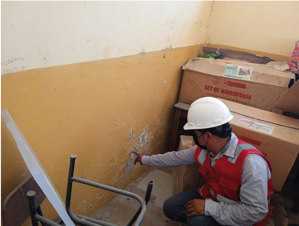
Figura 20. Presencia de eflorescencia.
