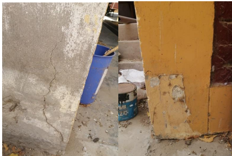
Figura 6. Agrietamiento en columnas.
