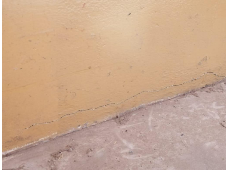
Figura 12. Grietas en muros de albañilería.
