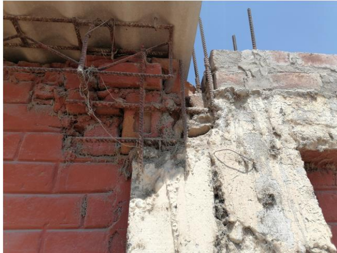
Figura 7. Discontinuidad y pérdida de material en las columnas.
