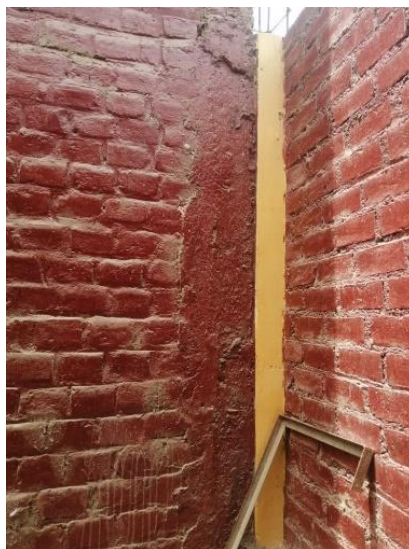
Figura 8. Ausencia de juntas sísmicas.
