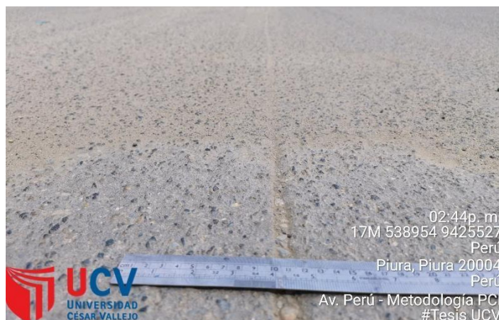
Nivel de Severidad Media. Progresiva 0+647
