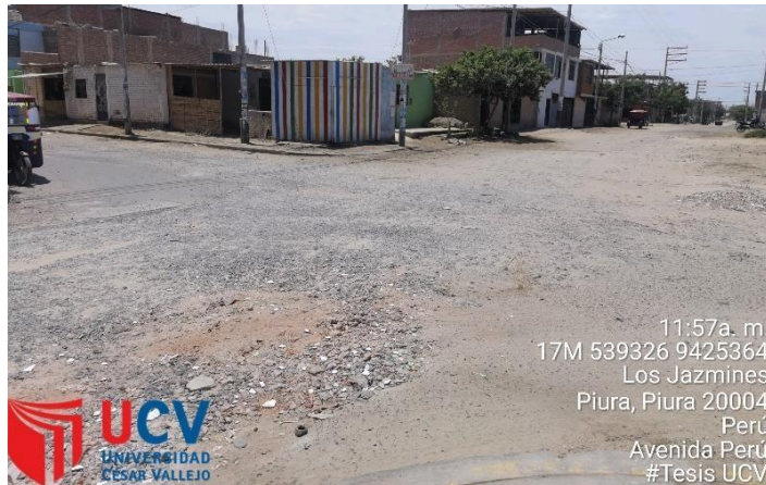
Nivel de Severidad Grave. Progresiva 1+040
