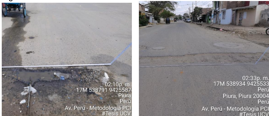
Nivel de Severidad Grave. Progresiva 0+483.5 y 0+544.2
