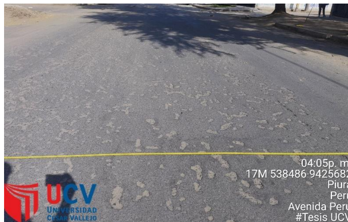
Nivel de Severidad Medio. Progresiva 0+200
