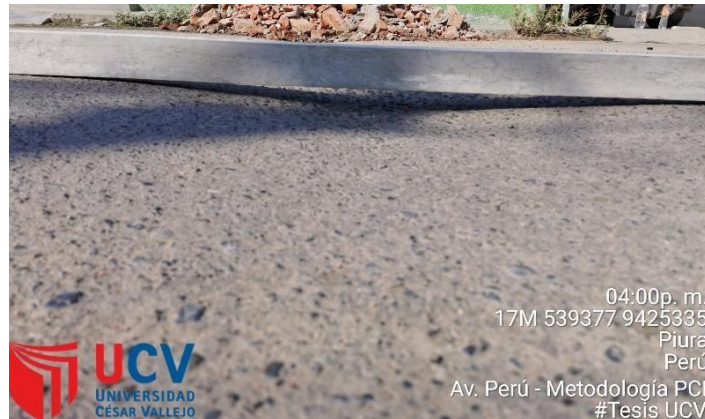
Nivel de Severidad Media. Progresiva 1+125
