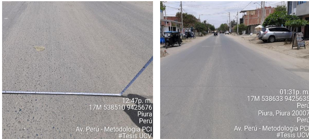
Nivel de Severidad Leve. Progresiva 0+186 y 0+320
