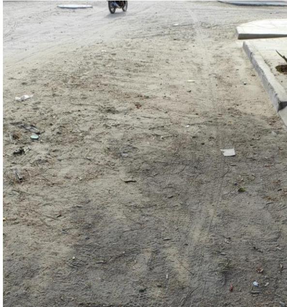
Figura 43. DESPRENDIMIENTO DE AGREGADOS Y HUECOS
