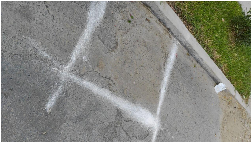
Figura 32. DESPRENDIMIENTO DE AGREGADOS
