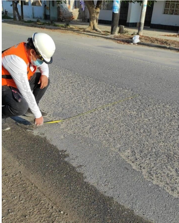
Figura 33. DESPRENDIMIENTO DE AGREGADOS
