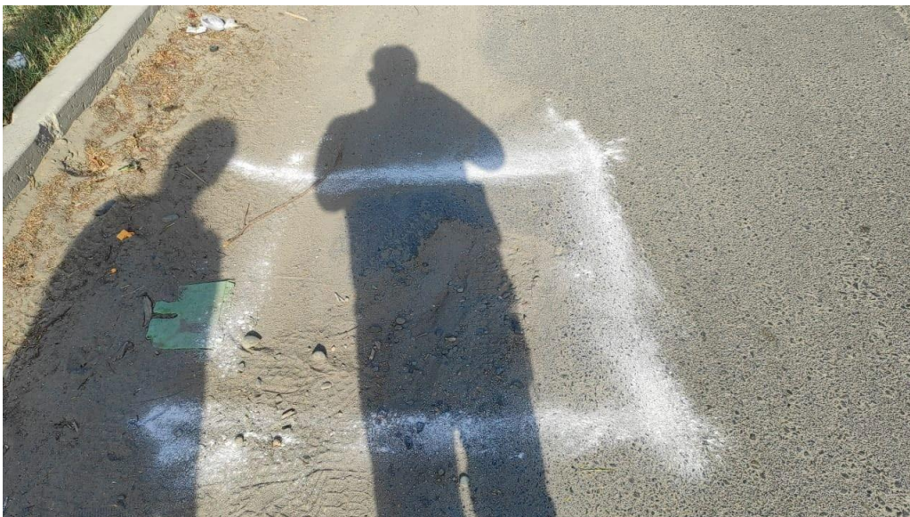
Figura 34. DESPRENDIMIENTO DE AGREGADOS
