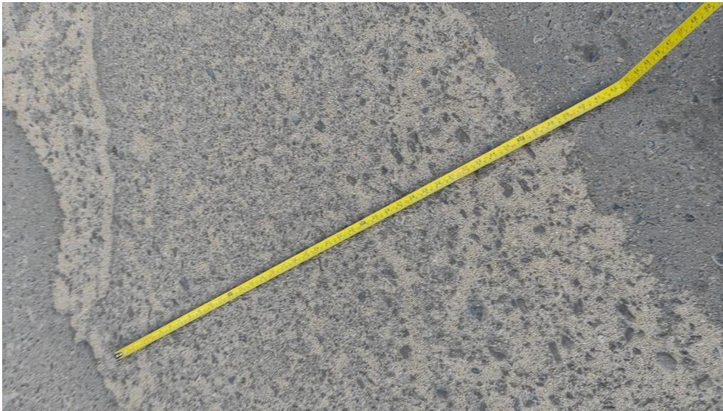
Figura 30. DESPRENDIMIENTO DE AGREGADOS
