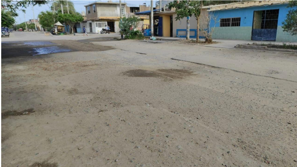
Figura 41. DESPRENDIMIENTO DE AGREGADOS
