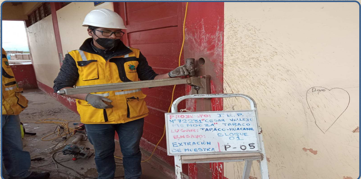
VISTA DE LA EXTRACCIÓN DE NUCLEOS MEDIANTE PERFORACIÓN DIAMANTINA P-05 REALIZADA EN LA COLUMNA
