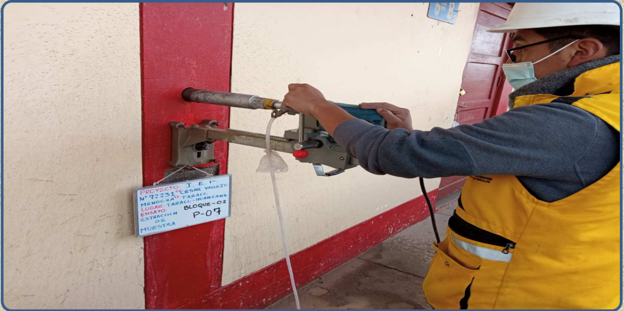
VISTA DE LA EXTRACCIÓN DE NUCLEOS MEDIANTE PERFORACIÓN DIAMANTINA P-07 REALIZADA EN LA COLUMNA
