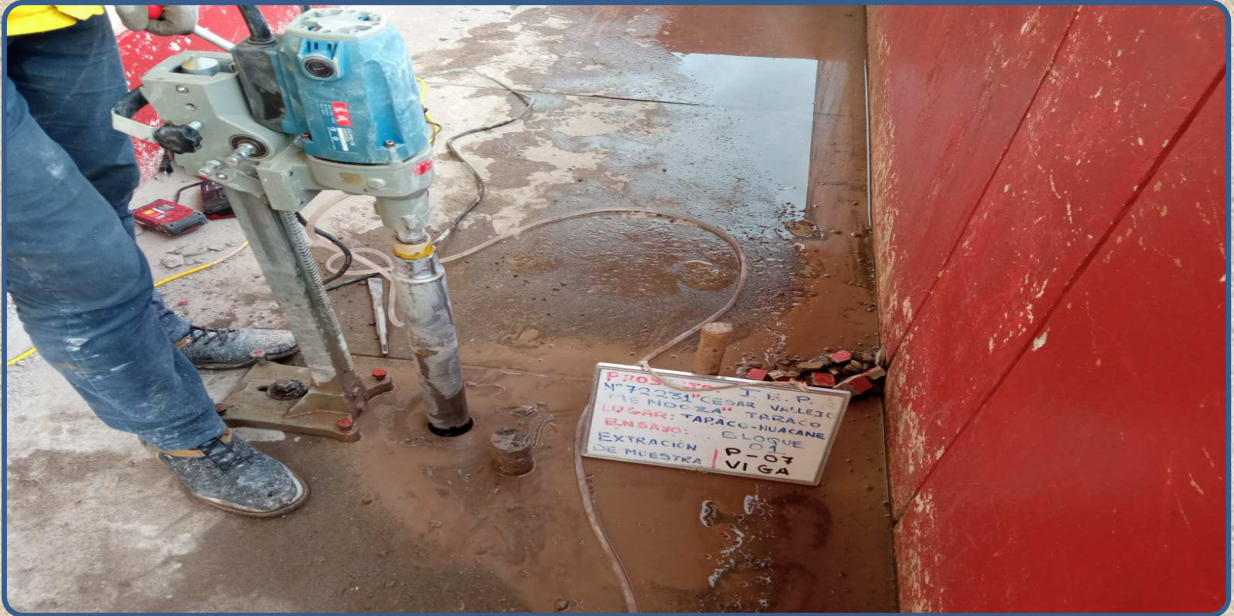
VISTA DE LA EXTRACCIÓN DE NUCLEOS MEDIANTE PERFORACIÓN DIAMANTINA P-07 REALIZADA EN LA VIGA-LOSA
