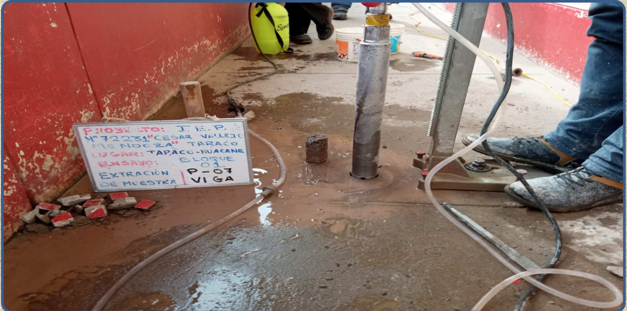
VISTA DE LA EXTRACCIÓN DE NUCLEOS MEDIANTE PERFORACIÓN DIAMANTINA P-07 REALIZADA EN LA VIGA-LOSA
