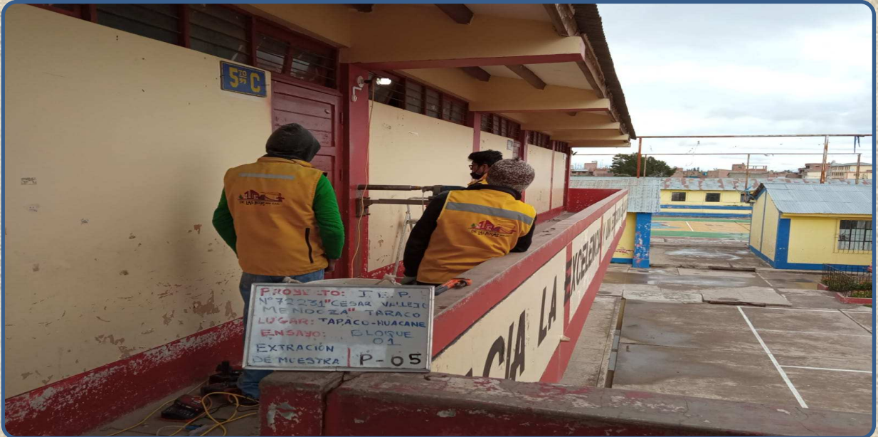
VISTA DE LA EXTRACCIÓN DE NUCLEOS MEDIANTE PERFORACIÓN DIAMANTINA P-05 REALIZADA EN LA COLUMNA
