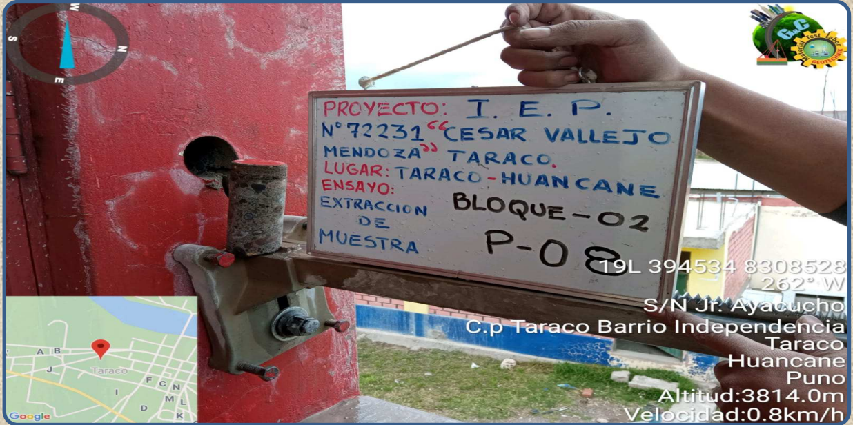
VISTA DE LA EXTRACCIÓN DE NUCLEOS MEDIANTE PERFORACIÓN DIAMANTINA P-08 REALIZADA EN LA COLUMNA
