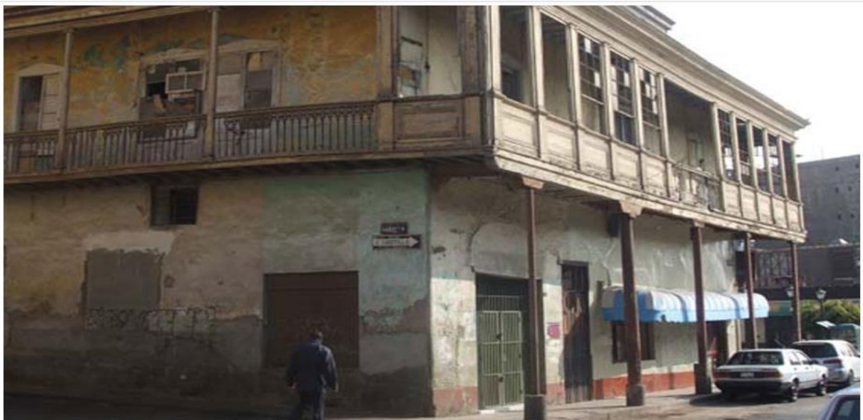
Figura 10. Viviendas de construcción precaria e inadecuadas del centro histórico de lima.
