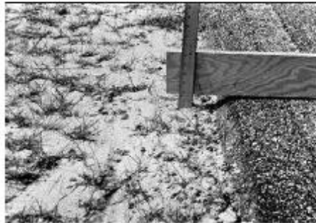
Fig. X1.25 Desnivel Carril-Berma – Baja Severidad
