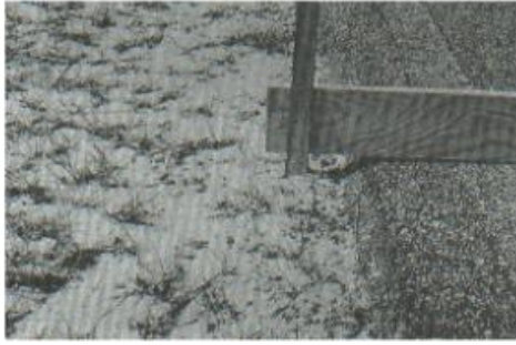
Figura 11. Falla Desnivel Carril / Berma
