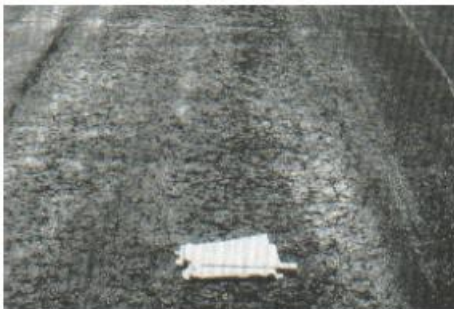
Figura 12. Falla Desprendimiento de agregados
