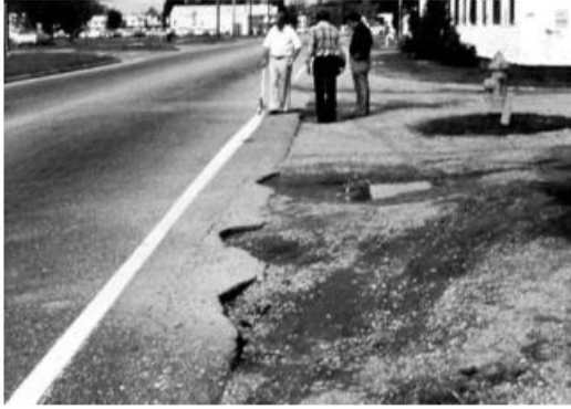
Figura 5. Falla Grieta de Borde
