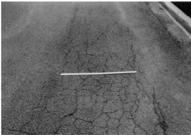
Figura 4. Falla Piel de Cocodrilo
