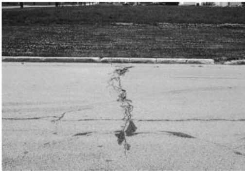
Figura 10. Grietas longitudinales y transversales
