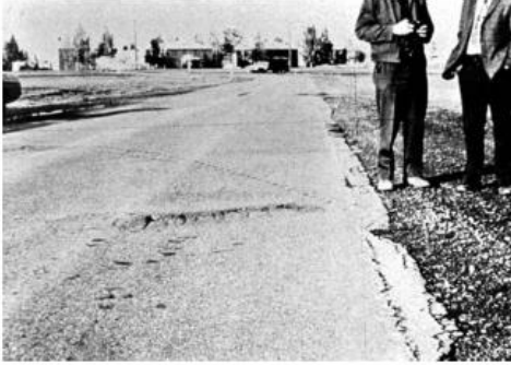
Figura 8. Falla Abultamientos y Hundimientos
