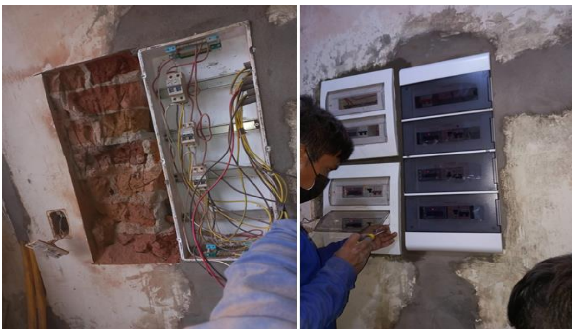
Figura 17: Implementación de medidores eléctricos PRE TEST.
