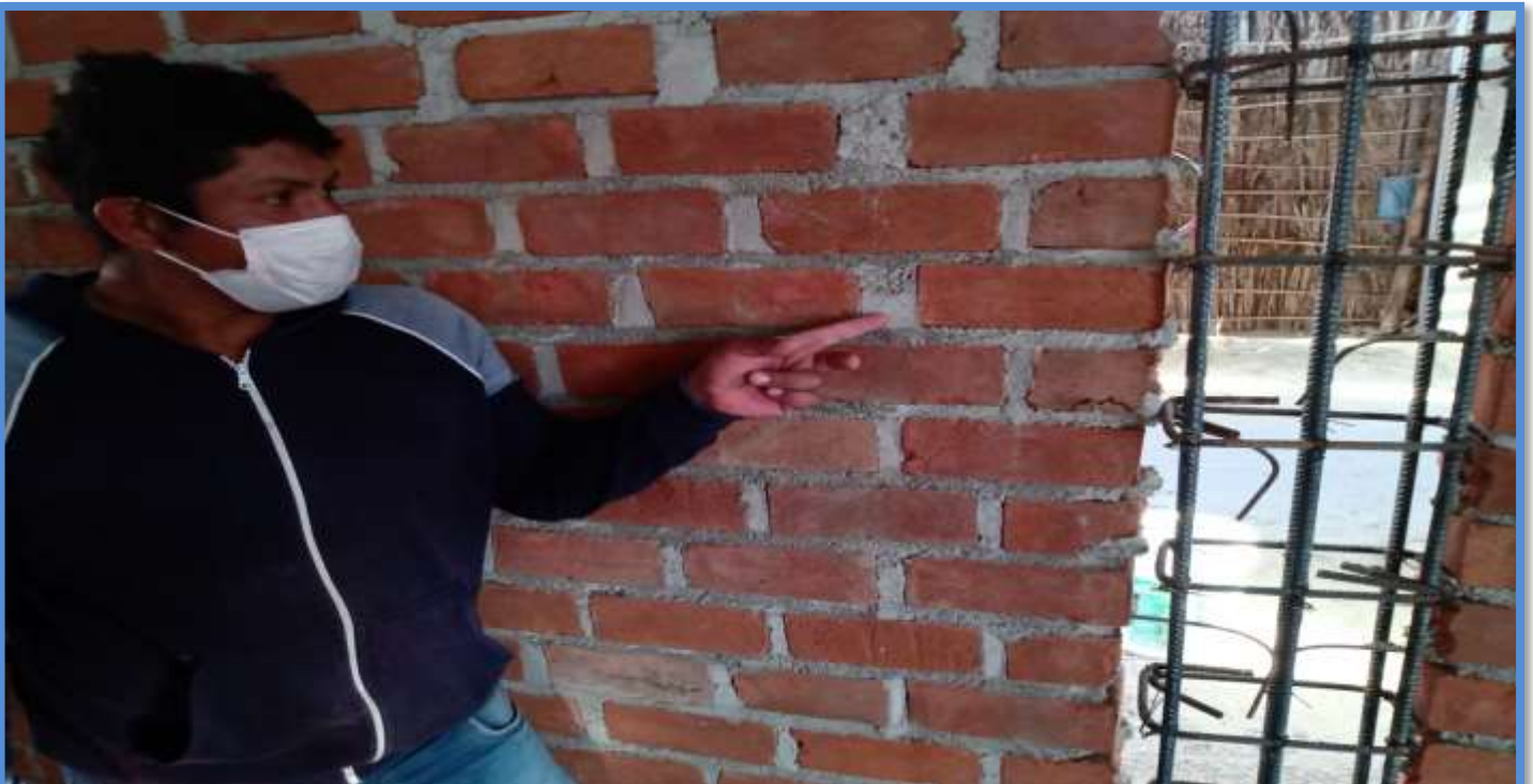
Observacion de Juntas verticales y horizontales en muro
