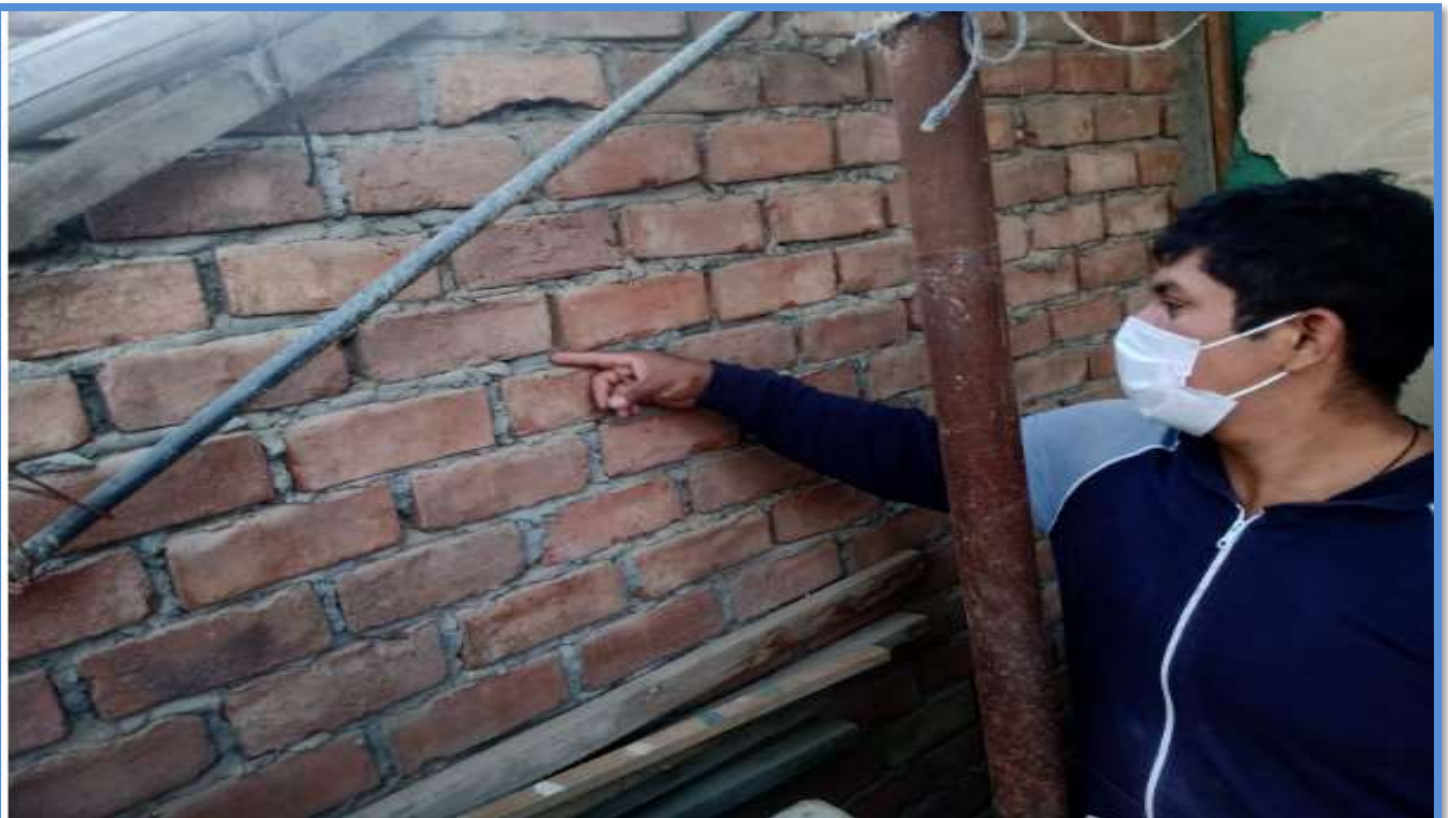
Observacion de deficiencias en procedimiento constructivo
