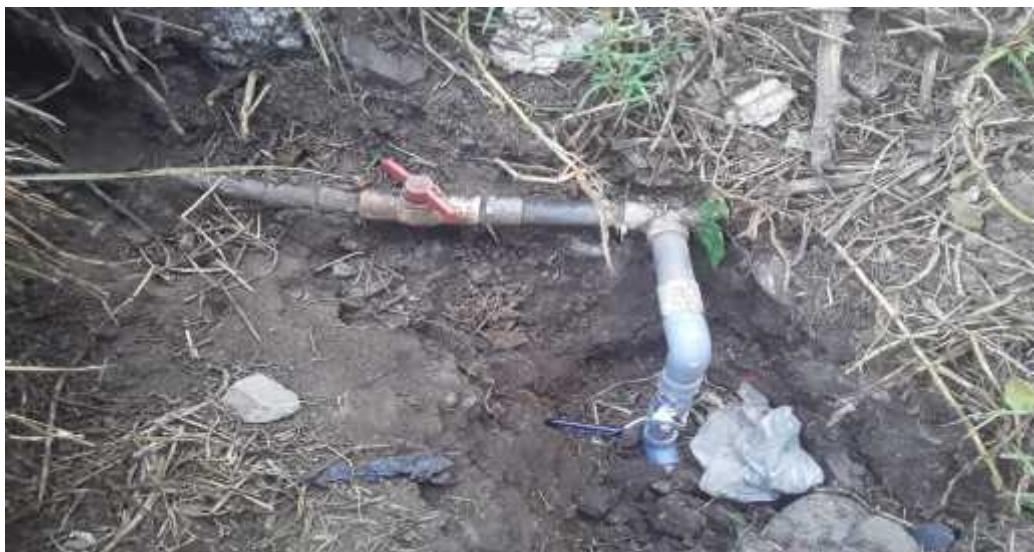
Figura 4. Línea de conducción
