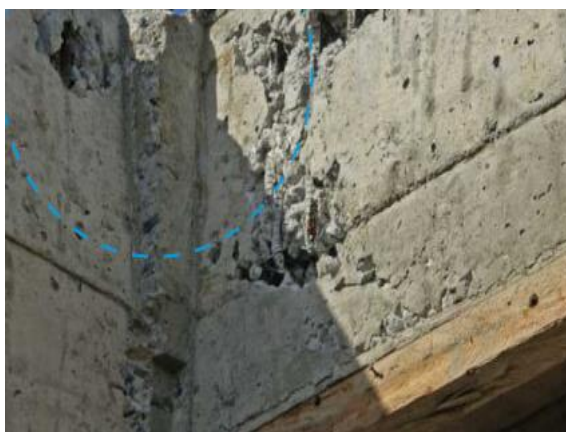
Figura 19. Determinación de segregación del concreto
