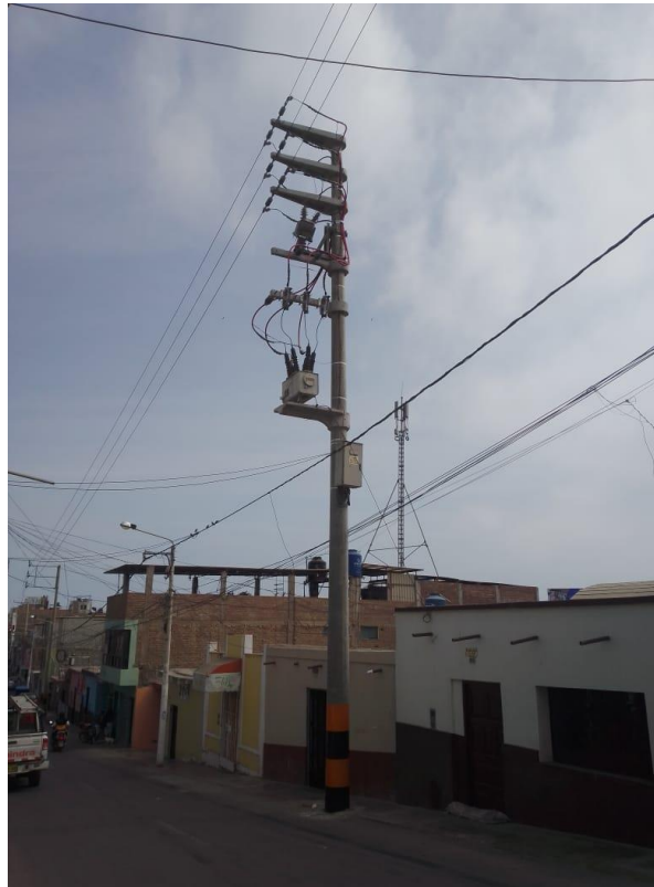
Figura 16: Ubicación del Recloser zona B
