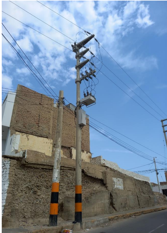
Figura 17: Ubicación del Recloser zona C
