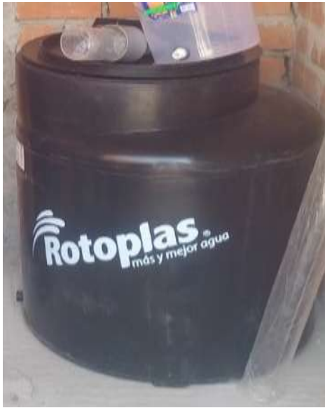
Tanque de agua (250L)
