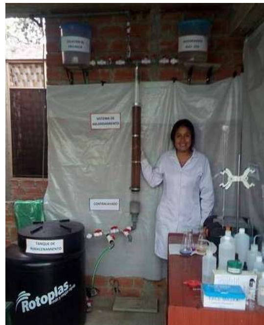
Sistema de ablandamiento
