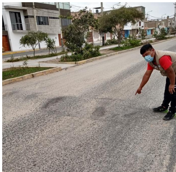
Fotografía N°02: Se muestra que hay un deterioro crítico del rompemueller y adicionalmente la pintura de color amarillo para reducir los límites de velocidad de los vehículos.
