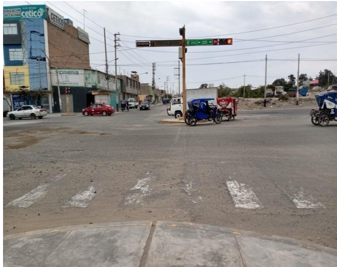
Fotografía N°05: Se muestra que hay un deterioro de la señalización de la zona peatonal que a simple vista se observa que solo existen unas cuadrillas existentes.
