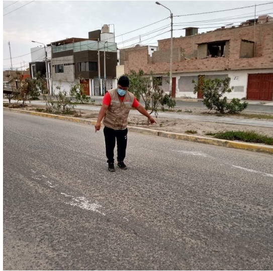
Fotografía N°01: Se muestra que hay una carencia de señalizaciones verticales encima del pavimento a causa del deterioro de la pintura de tráfico color blanco.
