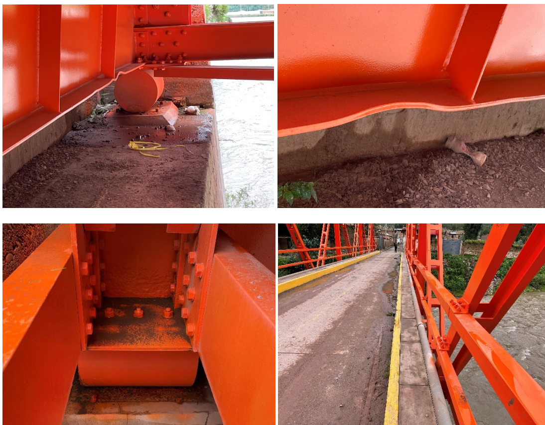
Figura 8: Elementos estructurales dañados.
