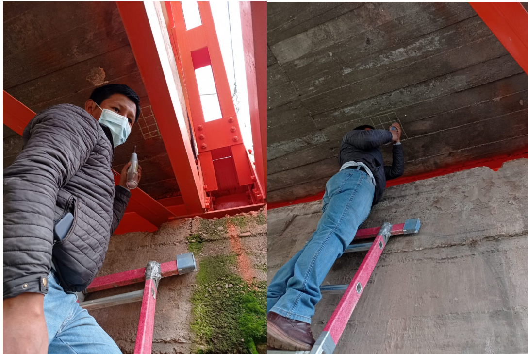
Ensayos de esclerometría para diagnosticar la capacidad de resistencia del tablero de concreto.
