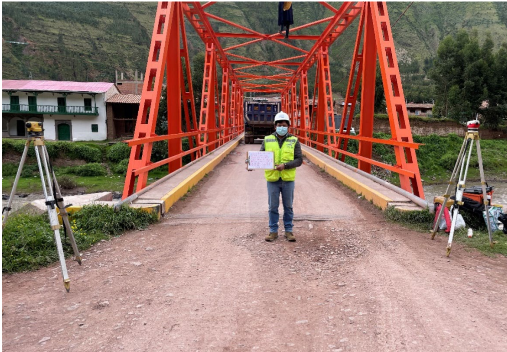
Equipos topográficos (nivel) utilizados para la toma de las mediciones de las deformaciones verticales
