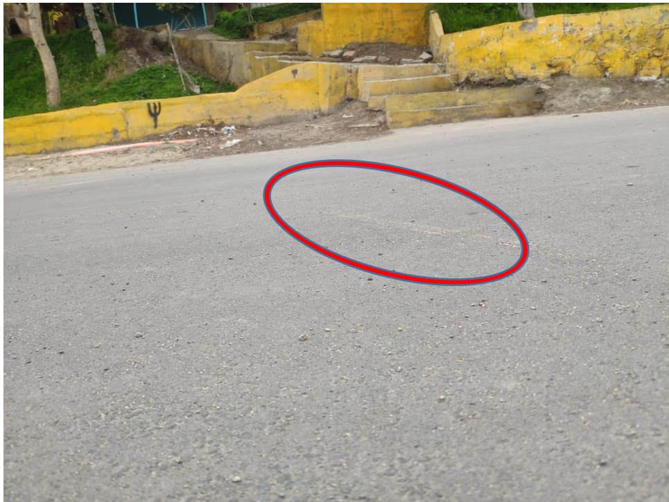
Evaluación de patologías existentes (Ahuellamiento)
