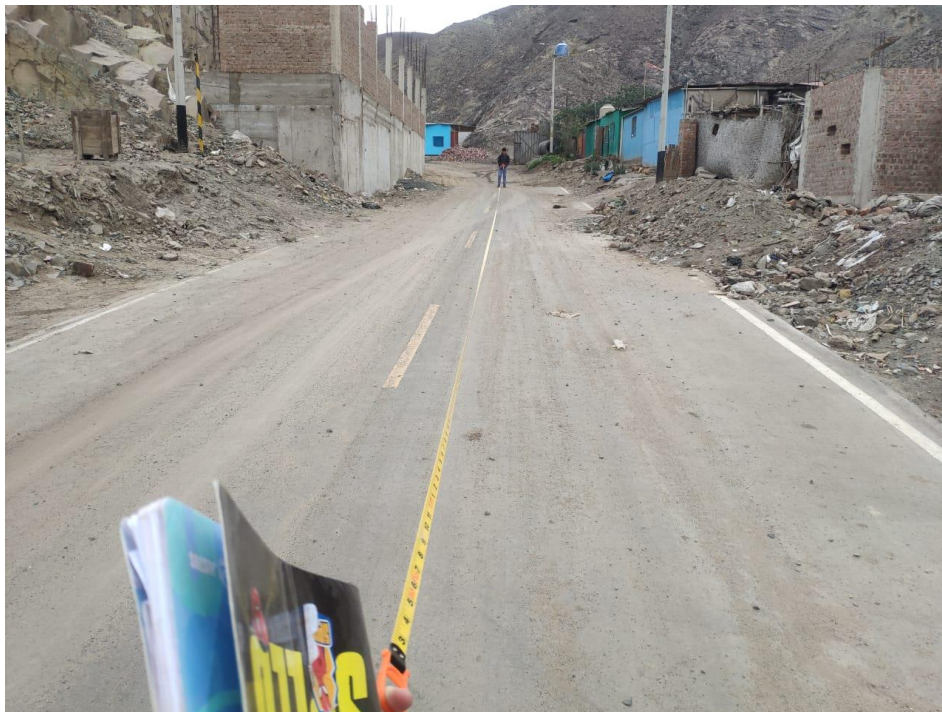
Evaluación de patologías existentes
