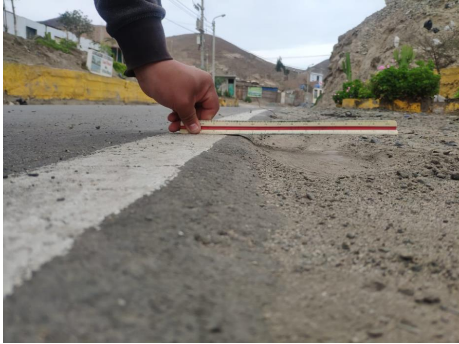
Evaluación de patologías existentes (Desnivel Carril – Berma)
