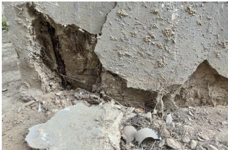
Figura 14: Columna externa con exposición de acero en Pabellón A.
