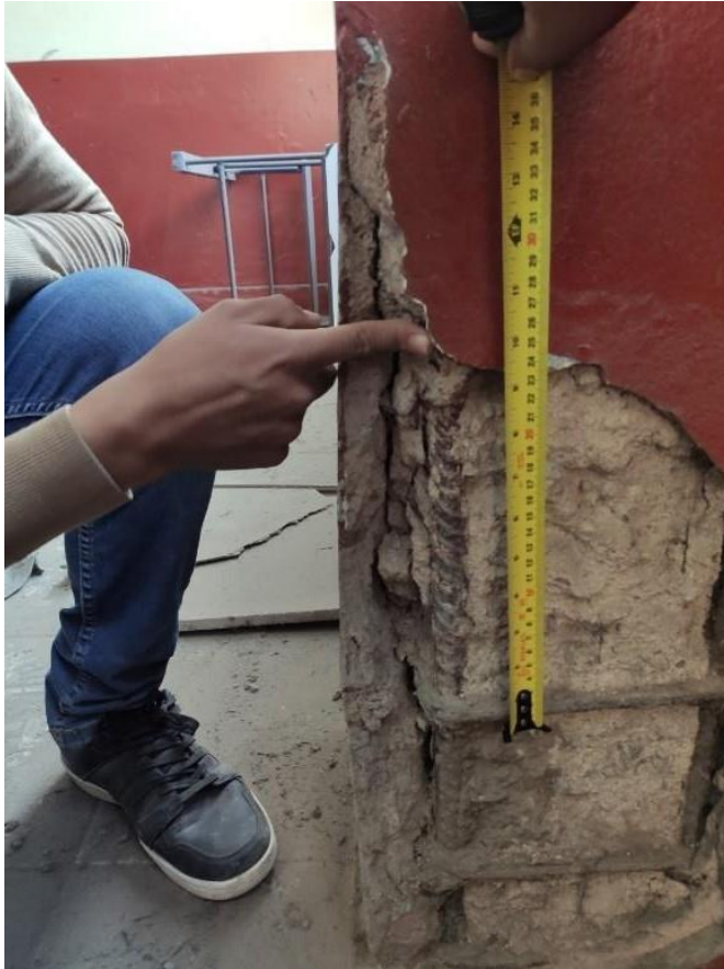
Figura 17: Columna interior con falla estructural grave en Pabellón B.
