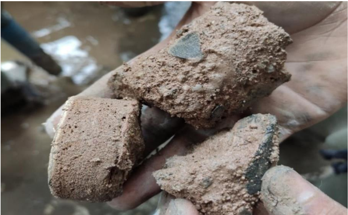
Figura T: Muestra de mal estado de elemento estructural modulo B.
