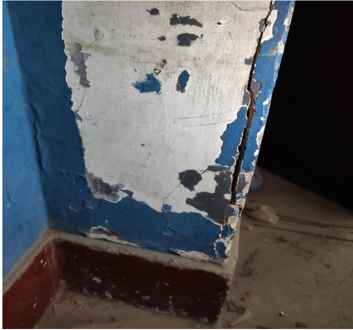
Figura 15: Columna con fallas en el Módulo B. Fuente. Elaboración propia.
