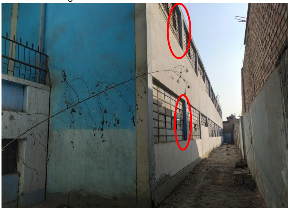
Figura 12: Muros de albañilería sin separación sísmica Pabellón A y B.
