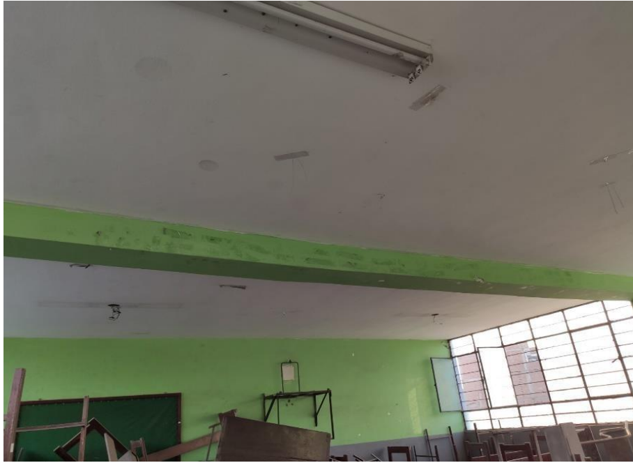
Figura 26: Inclinación de cubierta (losa aligerada) y viga principal.
