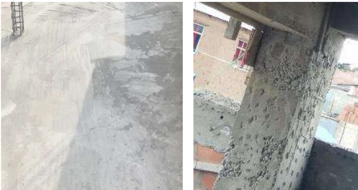
Figura 2. Presencia de fisuración y cangrejas.
