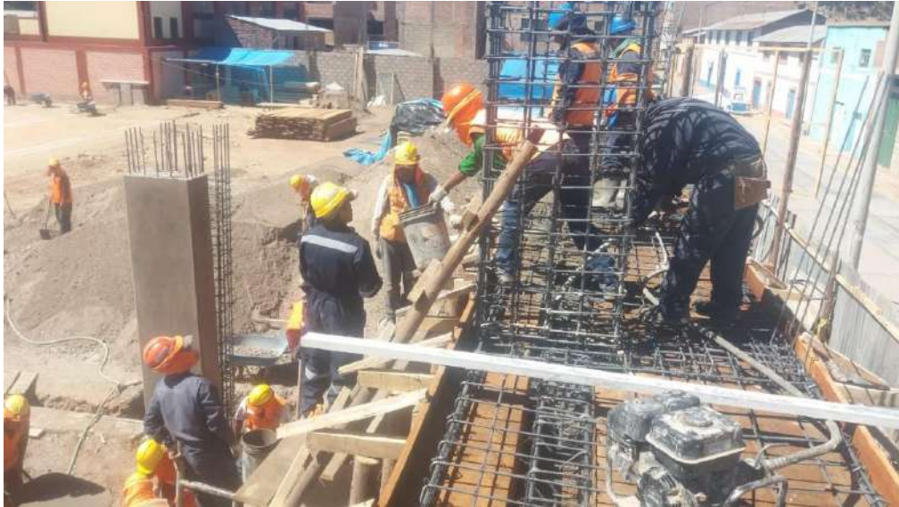
Figura 1. Mayor cantidad de acero de refuerzo y congestión de personal obrero por trabajos de vibrado.
