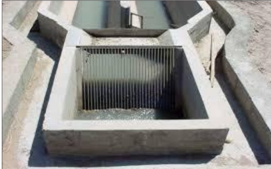
Figura 1 Cámara de rejas
