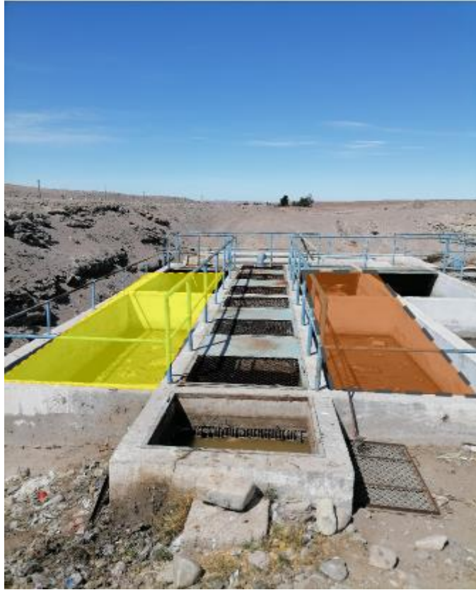
Figura 13 Cámara de espumas de tanque Fuente: Propia
