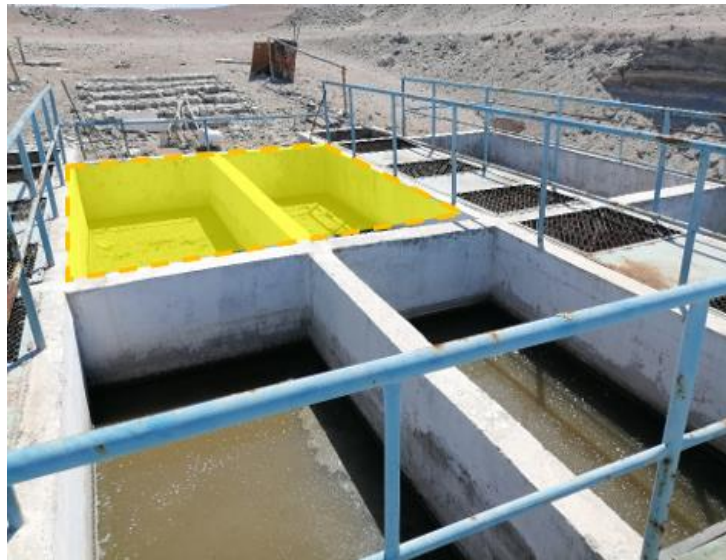
Figura 14 Tanque Imhoff Existente – Lodos flotantes Fuente: Propia
