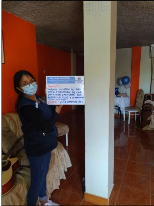
Figura 13. Toma de datos para el ensayo de esclerometría en la columna C-2. Fuente: Elaboración propia.
