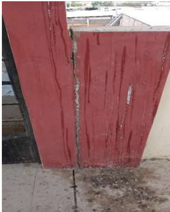
Fotografía 21. Muestra 7. Observación de discontinuidad en junta de separación entre bloques en muro y piso.
