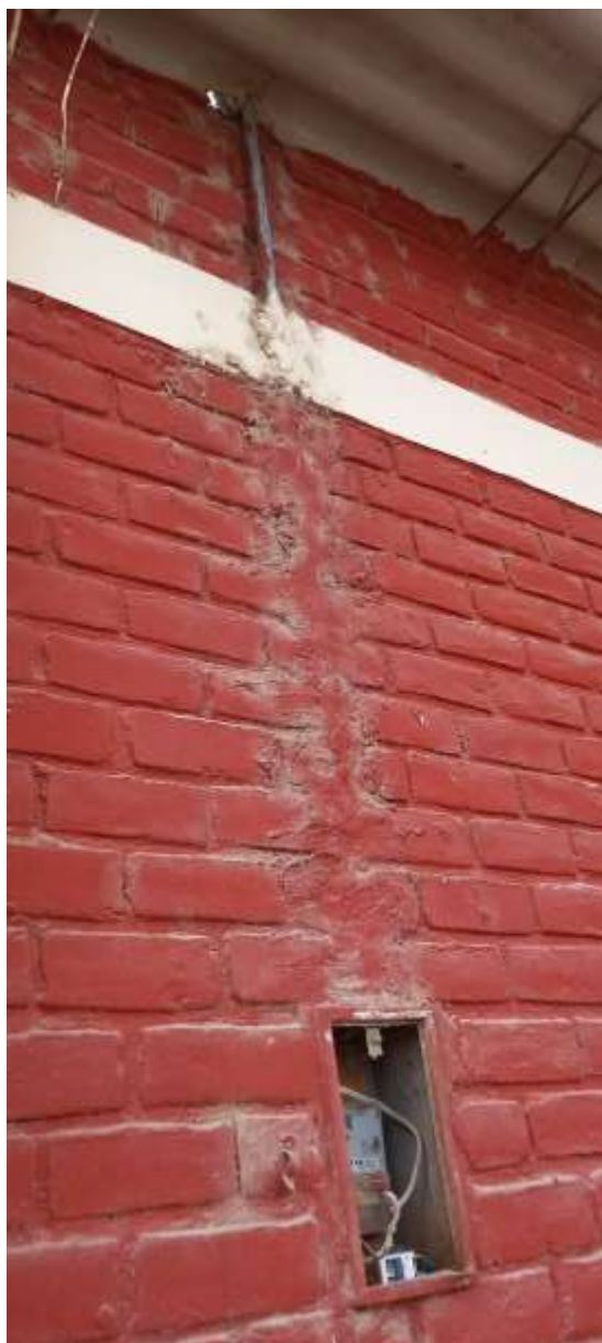
Fotografía 28. Muestra 14. Observación de trabajos incorrectos en instalaciones eléctricas.
