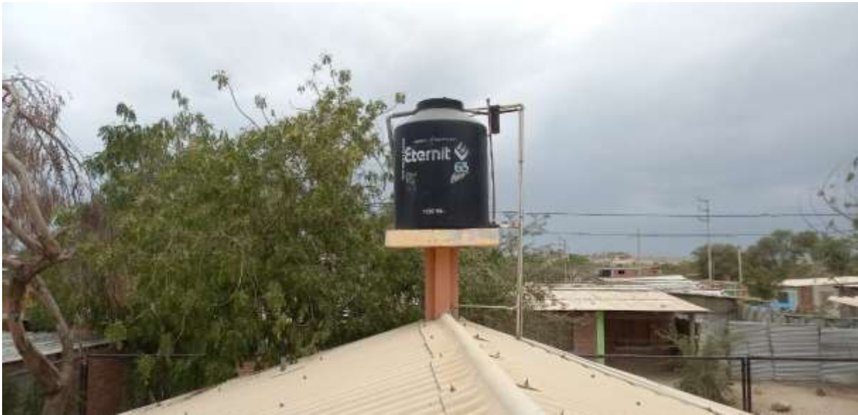
Figura 19. Pabellón de 01 nivel: Construcción con tanques de agua u otro tipo de elemento en el techo, mal construido y con mala conexión a la estructura, o construido posteriormente a la estructura principal
