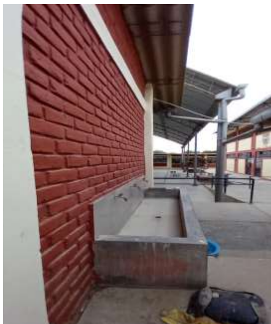
Fotografía 26. Muestra 12. Observación de fisuras y falta de verticalidad en muros de albañilería.
