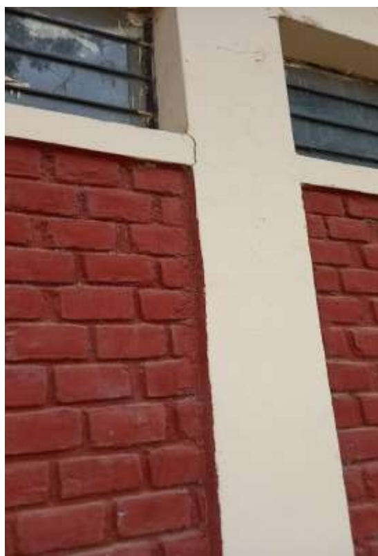
Fotografía 27. Muestra 13. Observación de fisuras en zona de columnas cortas.
