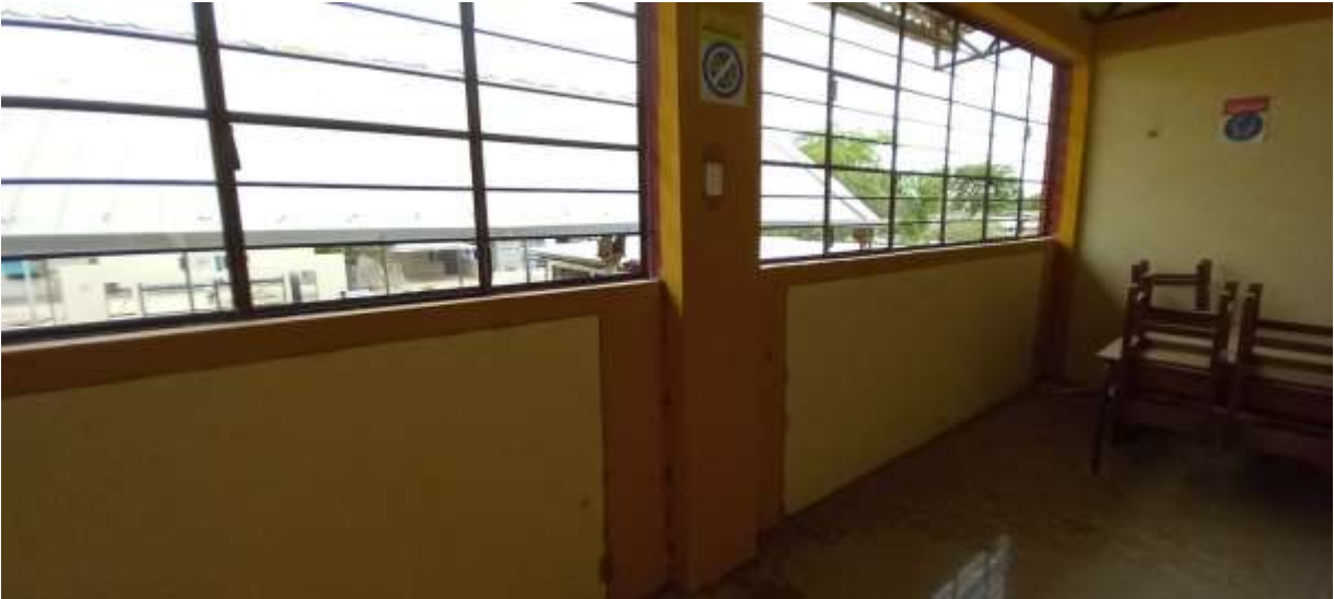
Fotografía 13. Salones en 2do nivel con pendientes constructivos destinados para aulas de clases.
