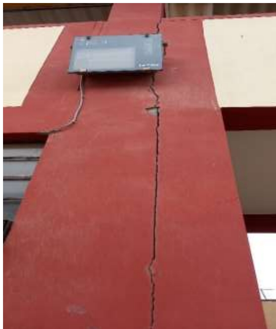
Fotografía 24. Muestra 10. Observación de fisuras muy visibles en junta de dilatación entre bloques de escalera y pabellón.
