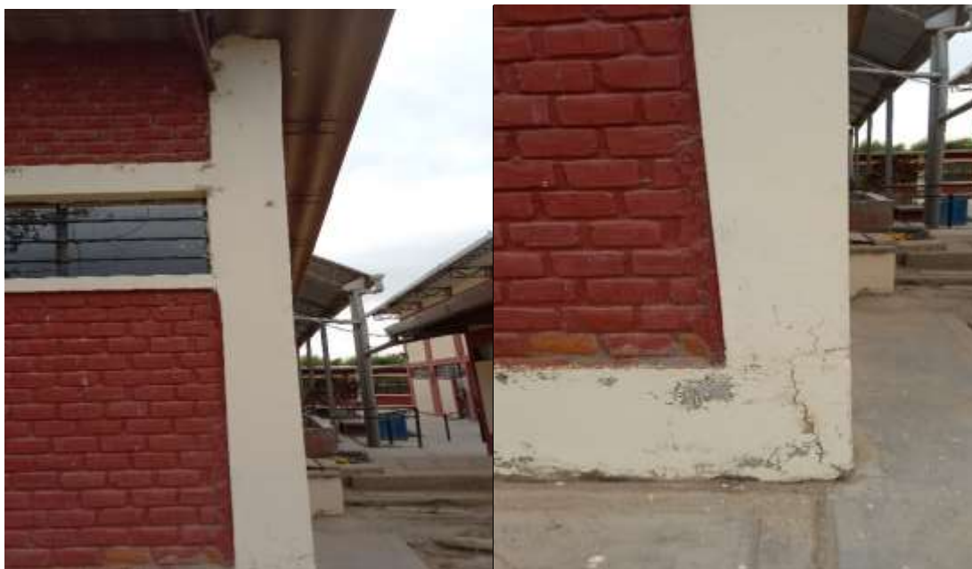
Fotografía 25. Muestra 11. Observación de fisuras y discontinuidad en columnas.
