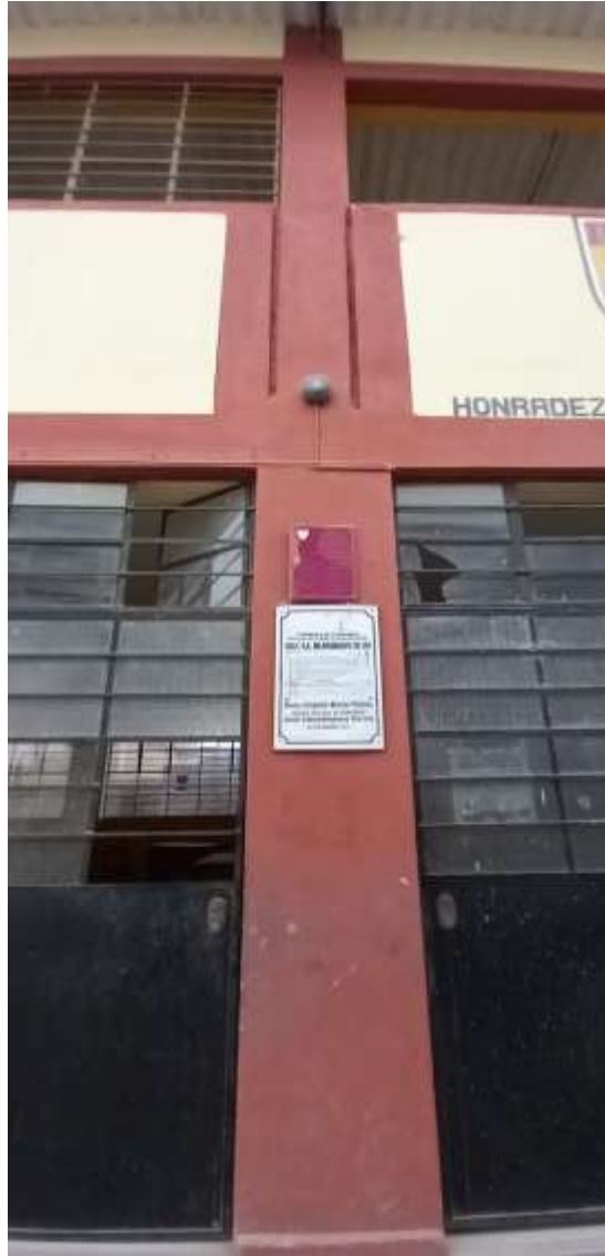
Fotografía 15. Muestra 1. Observación de Configuración en elevación y discontinuidad de elementos estructurales como esta columna central del frontis del pabellón.
