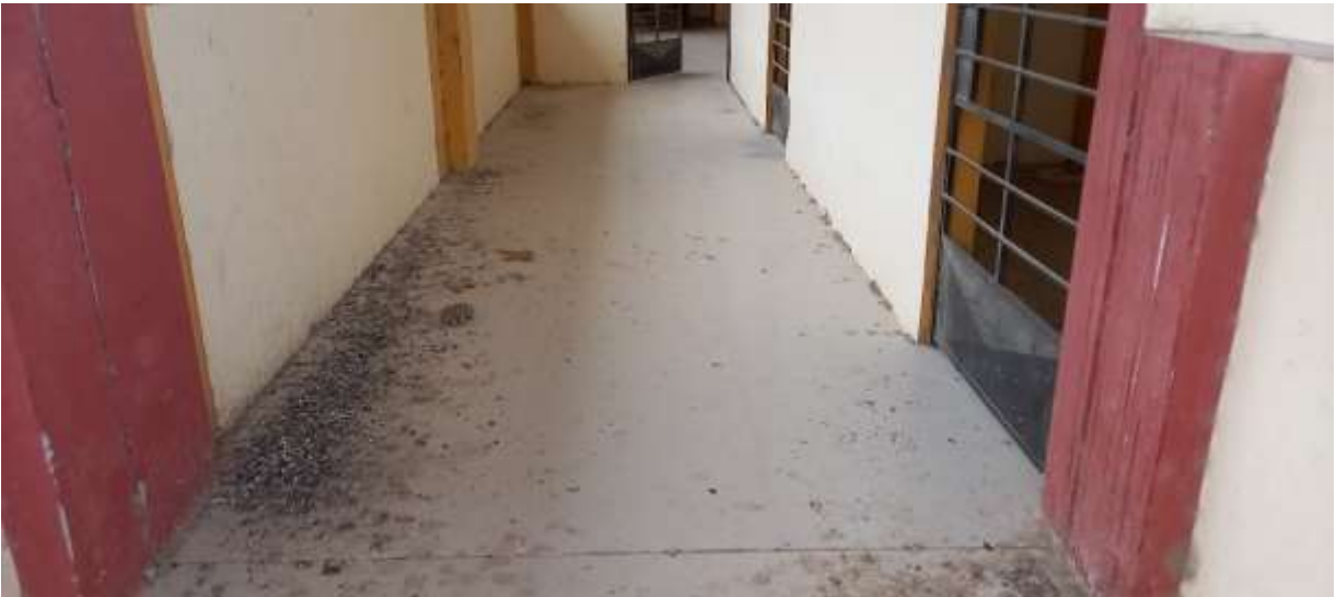
Fotografía 18. Muestra 4. Observación de ausencia de juntas de dilatación en piso en tramo largo en segundo nivel.
