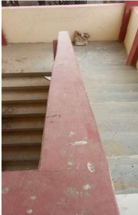
Fotografía 22. Muestra 8. Observación de discontinuidad en planta en pasamano de escalera de concreto.
