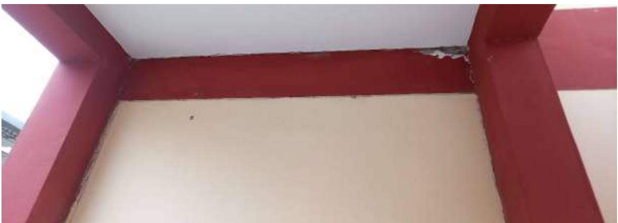
Fotografía 23. Muestra 9. Observación de fisuras muy visibles en bloque de escalera.
