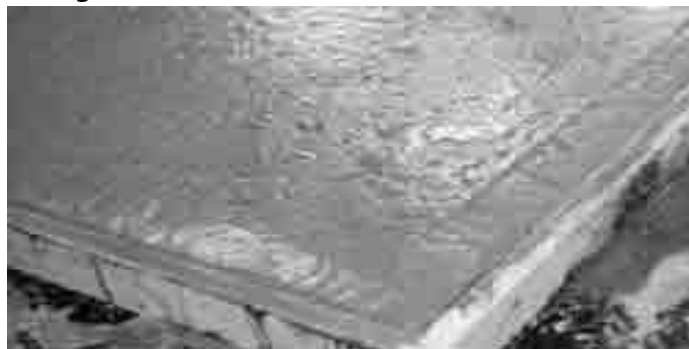
Figura N°17: Exudación del concreto.
