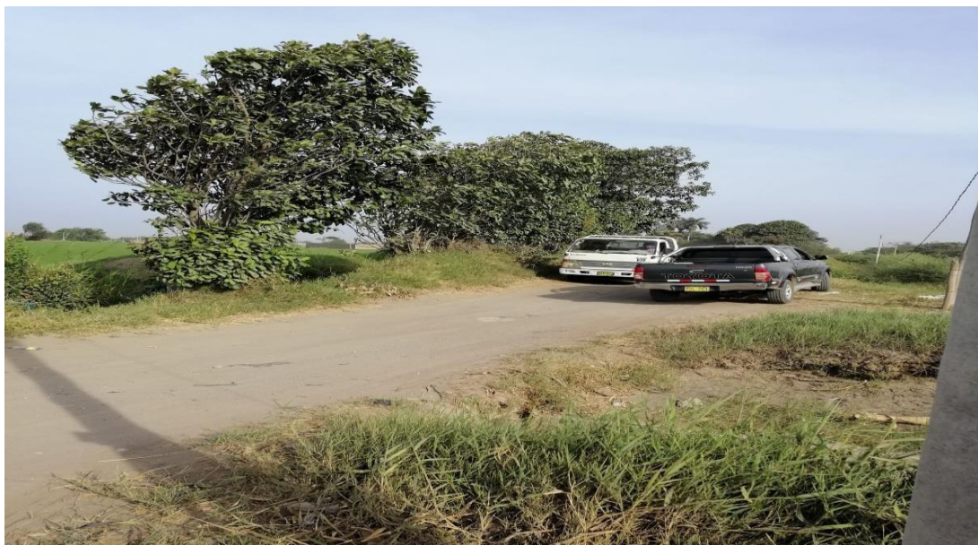
Figura 7. Estado actual de la vía trocha carrozable.
